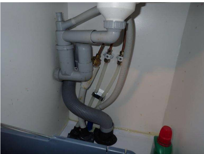
Keittiön allaskaapin putkiliitoksia.
