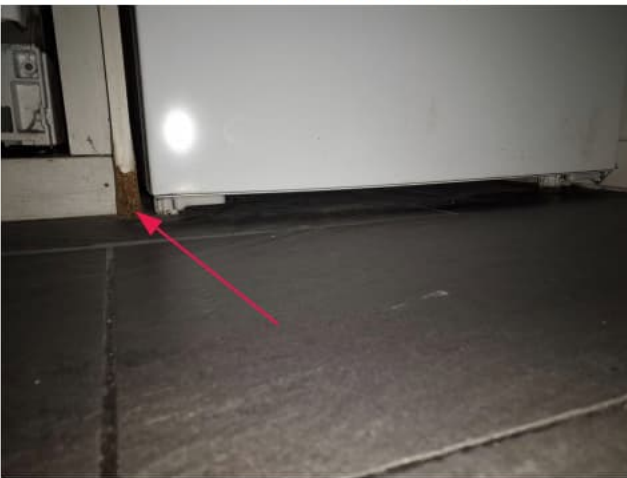
Jääkaapin alla ei ole suojakaukaloa. Peitelevy jääkaapin vieressä turvonnut kosteudesta.
