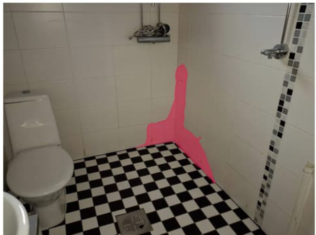
Suihkunurkassa, kohonneita pintakosteusarvoja seinässä.
