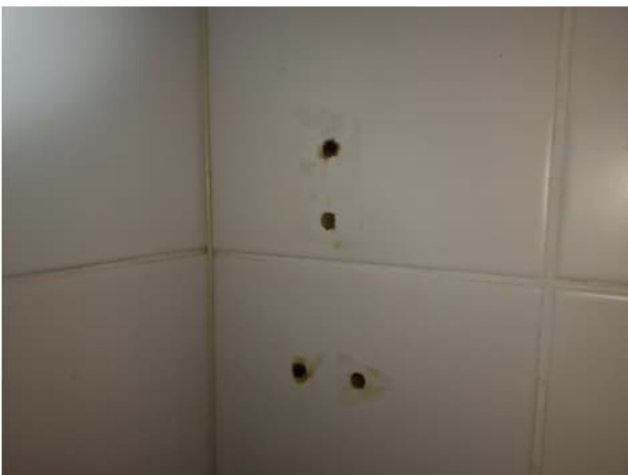
Suihkunurkassa tiivistettyjä vanhoja kiinnitysreikä. Tiivistysten uusiminen suotavaa.
