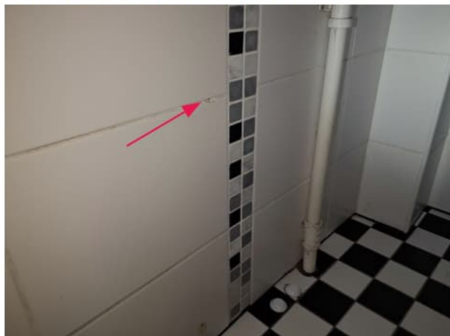
Yksi vanha kiinnitysreikä tiivistämättä. Lattiasa vanhoja putkitulppauksia.
