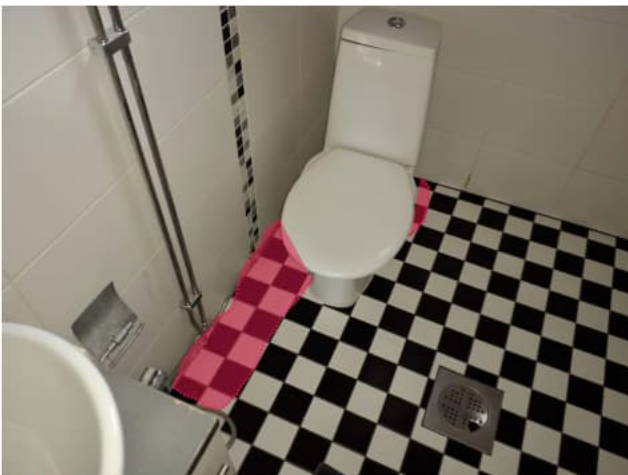
Wc istuimen vieressä, seinä ja istuimen välissä kohonneita arvoja lattiassa. Merkitty kuvaan.
