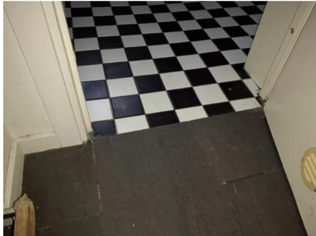
Tiivis kynnyksen puuttuu ovenaukon kohdalla.
