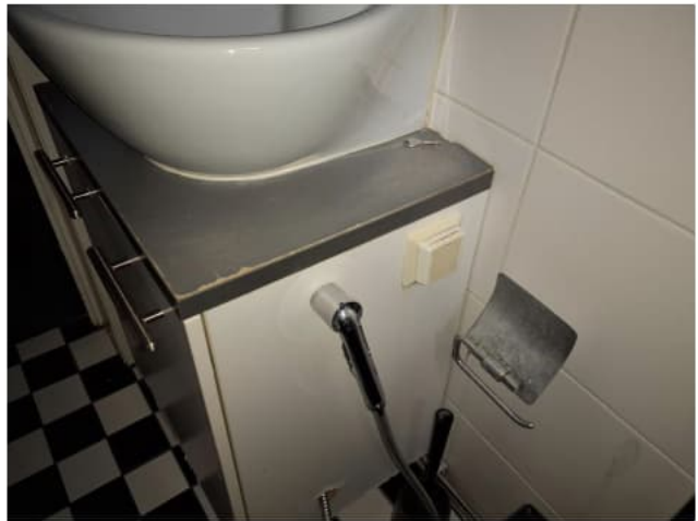
Allaskaapin kyljessä pistorasia, uppoasennuksella. Pistorasia on riskialttiilla paikalla, suositus että pistorasia siirretään kauemmaksi vesipisteiltä.
