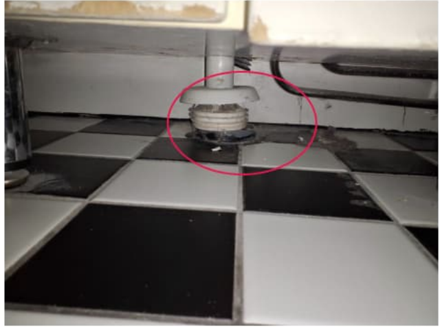
Pesualtaan viemärin liitos viemäriin epätiivis / paikoiltaan.
