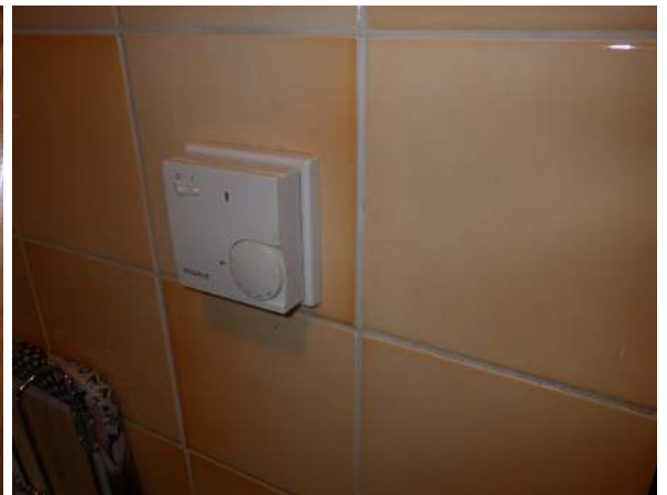
47. Pesuhuoneen lattialämmityksen termostaattia
