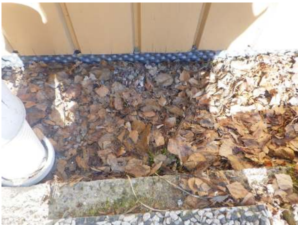
3. Patolevyä kuistin perusmuurissa
