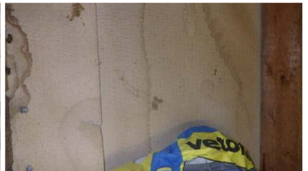
19. Kosteusjälkiä sivuvintillä pahrissa
