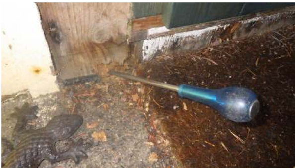
1. Betoniportaankohdalla seinässä pehmentymää
