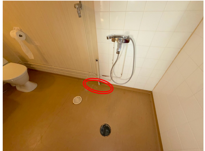
Kuva 6. Kohonnutta kosteutta havaittiin punaisella rajatulla alueella.
