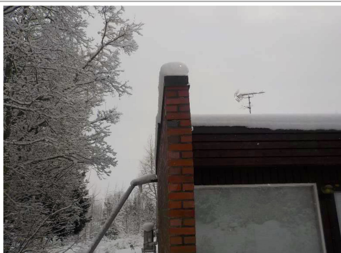
Asuinrakennusosan toisessa päädyssä täystiilirakenteisen ulkoseinän yläosassa oli havaittavissa kaarevuutta ja vaurioita.
