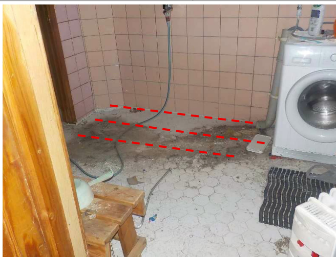
Paikoin havaittuja hieman kohonneita lukemia.
