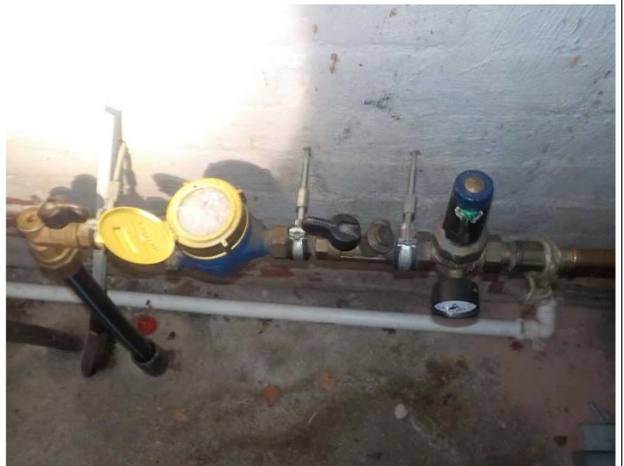
Vesimittari on jäämisen seurauksena rikkoutunut.
