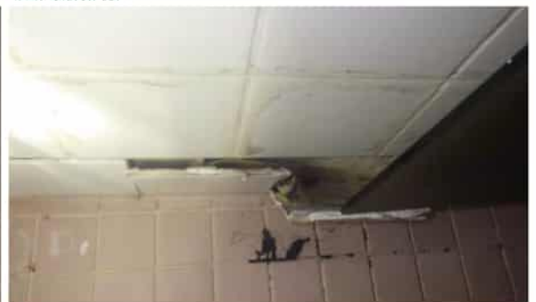
44. Seinälaatat irronneet kosteuden takia saunaosastolla
