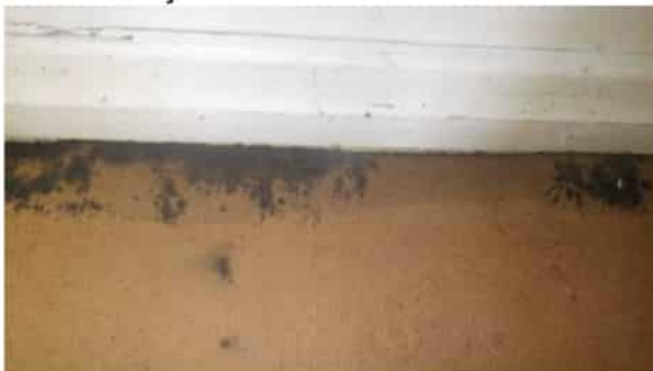
60. Näkyvää mikrobikasvustoa sisäpinnoissa
