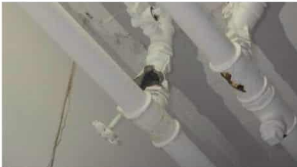
61. Mahdollisesti jäätyneen aiheuttamia vaurioita lämmitysputkissa
