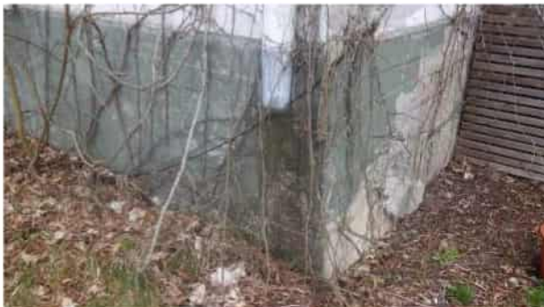
10. Kattovedet valuvat sokkelin viereen
