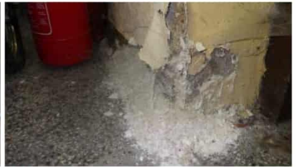
6. Maakosteuden aiheuttamia jälkiä
