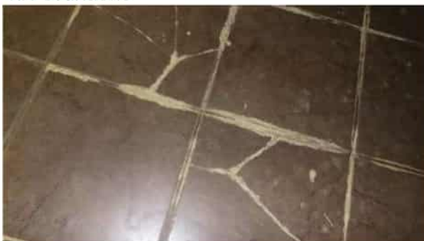
43. Lattia rikki / pehmenyt yhden asunnon kylpyhuoneessa
