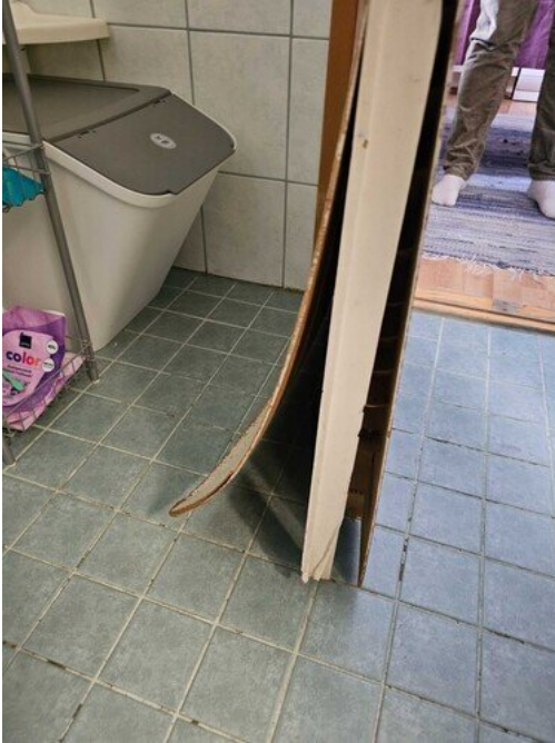
Kuva 9 Kylpyhuoneen ovi on huonossa kunnossa.
