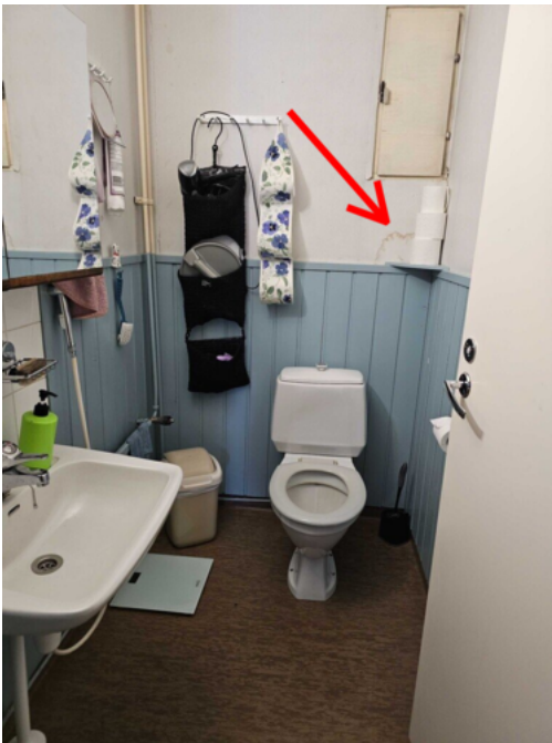
Kuva 10 Tuuletusikkunan alapuolella kosteusjälki.
