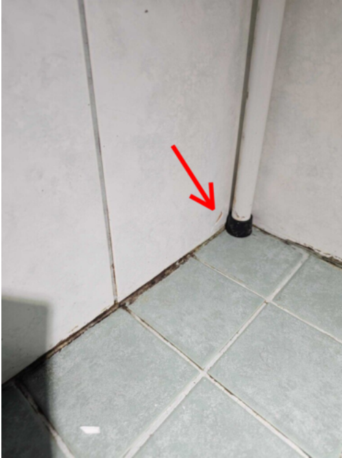
Kuva 3 Silikonisaumat huonossa kunnossa ja suihkunurkassa seinälaatta on halki.
