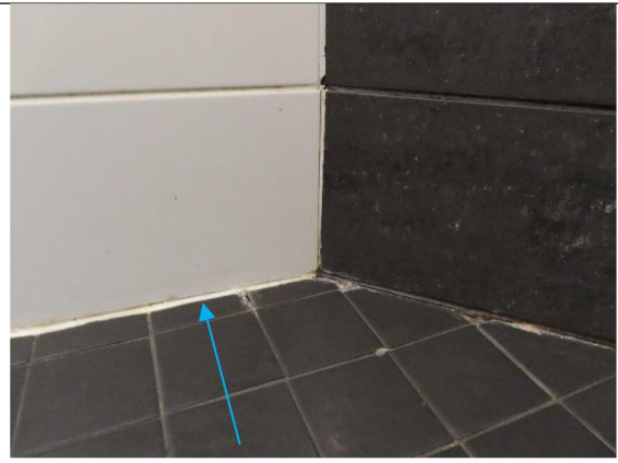
Lattia- ja seinälaatoituksen välinen kulmasauma paikoin auki
