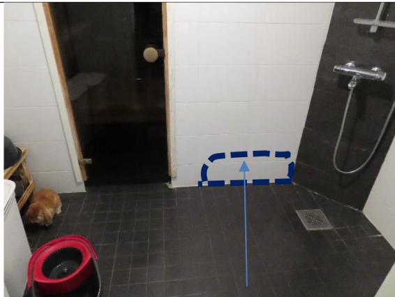
Saunan vastaisen seinän alaosaassa kosteutta
