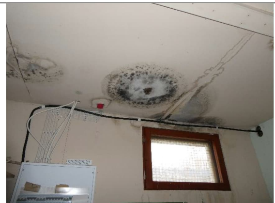
Autotallin sisäkatossa ja ulkoseinän yläosassa mikrobivaurioita
