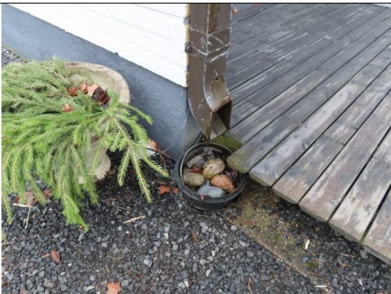
Rännien alustoissa on sadevesiviemärinti
