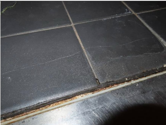
Lattialaatoituksen saumoissa paikoin reikiä
