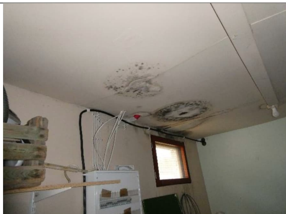
Autotallin sisäkatossa ja ulkoseinän yläosassa mikrobivaurioita
