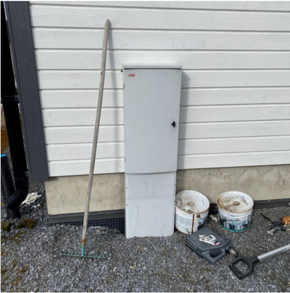
2. Yleiskuva: Pääkeskuksen suojauksessa ei havaittu puutteita.
