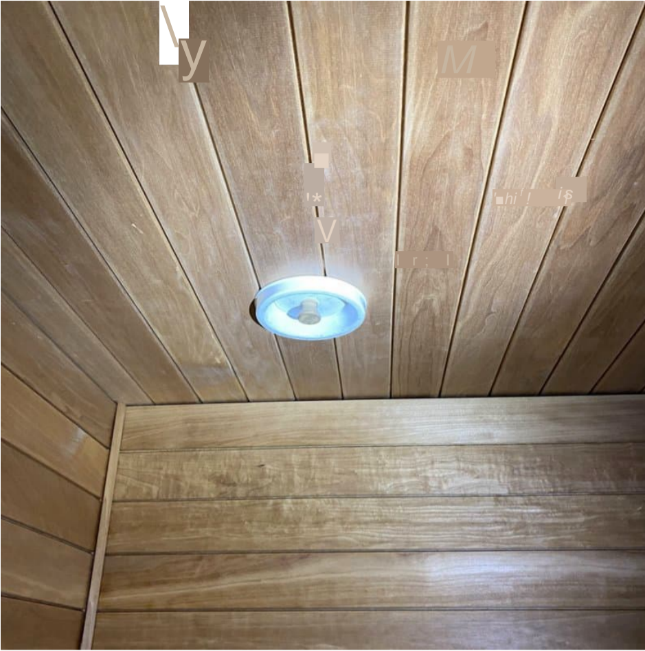
9. Yleiskuva: Saunassa on nupillinen poistoilmaventtiili (KSO-S). Venttiilillä voidaan tehostaa saunan kuivatusta käytön jälkeen vetämällä se kokonaan auki. Muulloin venttiili voi olla ns. kiinniasennossa.
