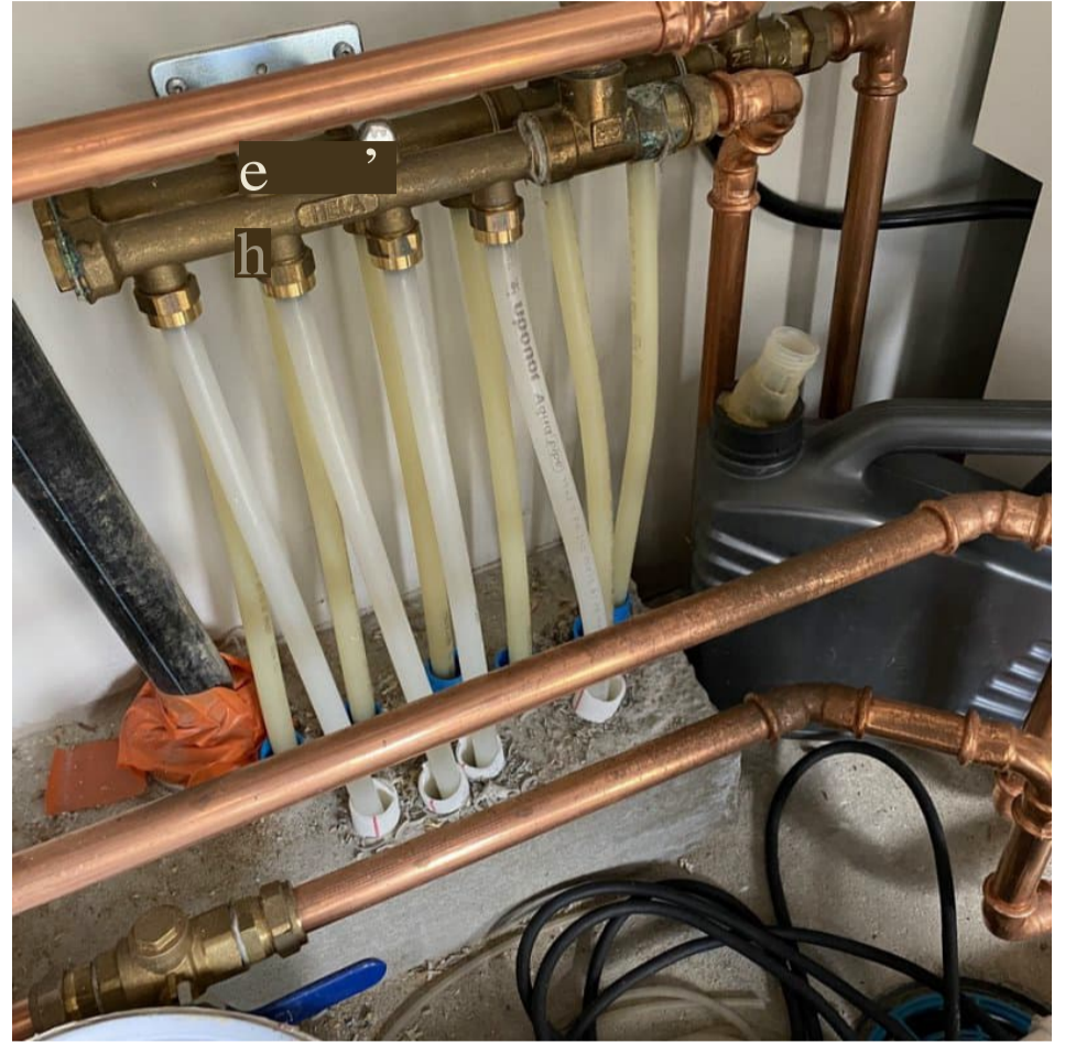
3. Yleiskuva: Käyttöveden jakotukkien asennuksessa ei havaittu puutteita. Jakotukit sijaitsevat teknisessä tilassa.
