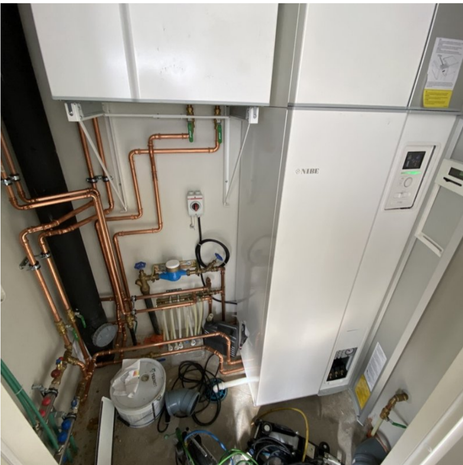
11. Yleiskuva teknisestä tilasta.
