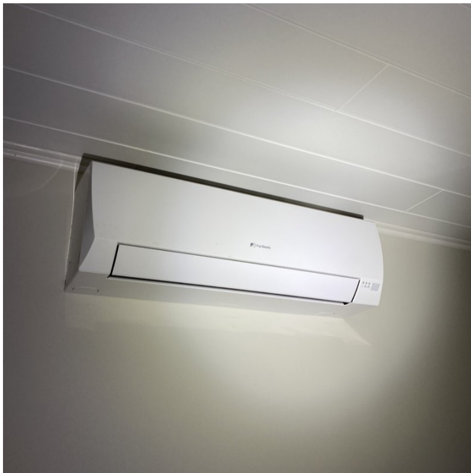
7. Yleiskuva ilmalämpöpumpun sisäyksiköstä. Sisäyksikön asennuksessa ei havaittu puutteita.
