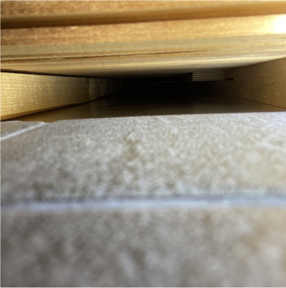
2. Yleiskuva: Saunan paneeliseinän takaa havaittiin tuuletusrako.
