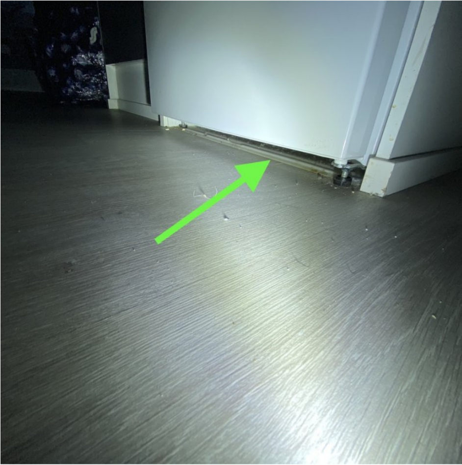
6. Yleiskuva: Kylmälaitteiden alle on asennettu suositusten mukaiset vuotokaukalot.
