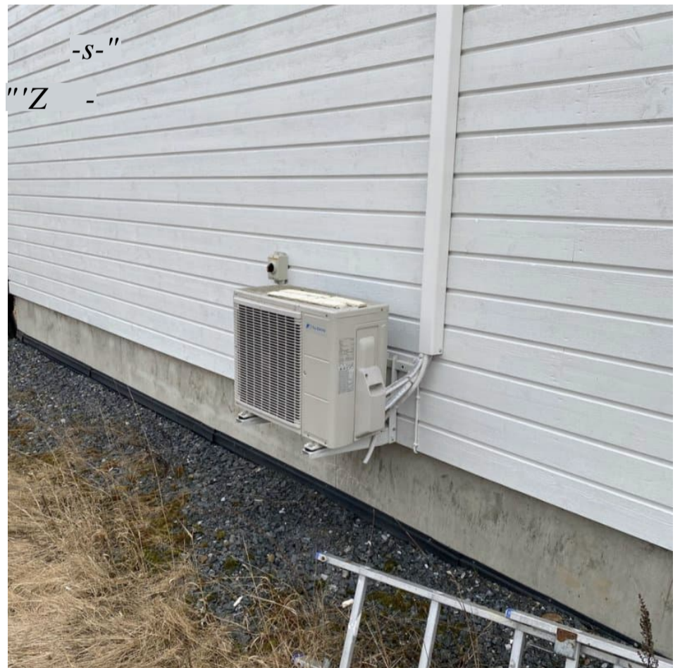
8. Huomio: Ilmalämpöpumpun ulkoyksikkö on asennettu kiinteästi ulkoseinään. Riskinä on runkoäänien kantautuminen sisälle. Mikäli runkoäänet muodostuvat häiritseväksi, suositellaan ulkoyksikön asentamista maanpäälle asennettavan jalustan varaan.
