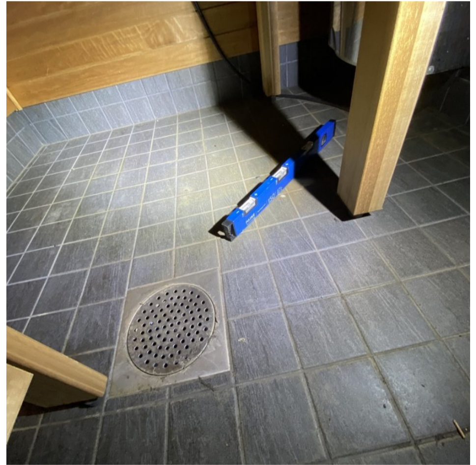
5. Yleiskuva: Saunan lattian kaatojen toimintaa arvioitiin kaatopassilla. Kaadoissa ei havaittu mainittavia puutteita.
