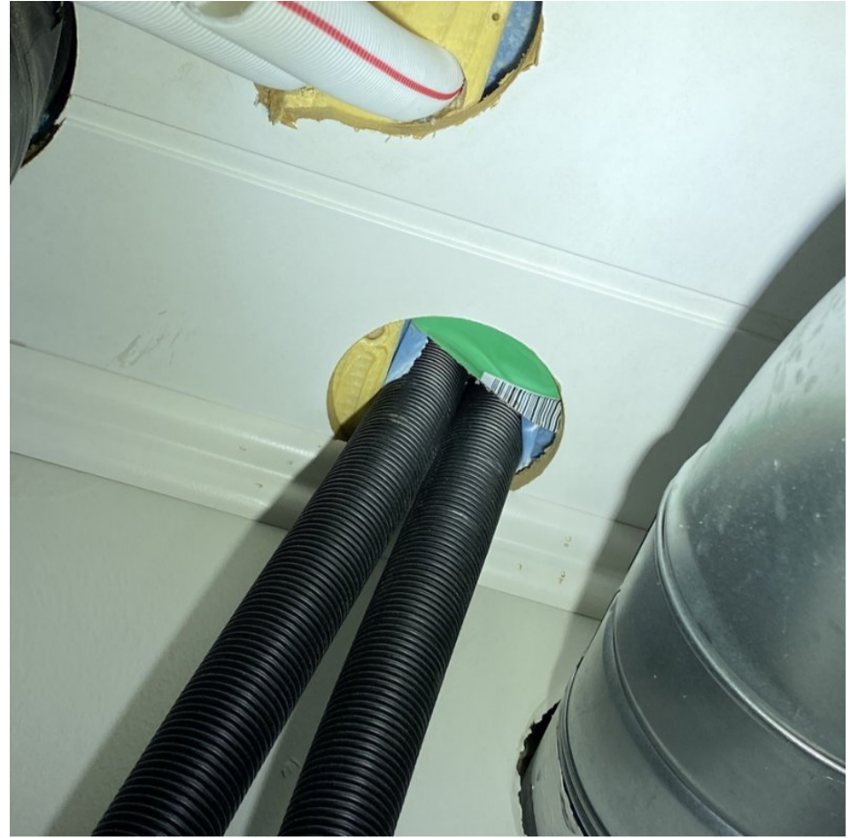
10. Huomio: Teknisen tilan sisäkatoissa höyrynsulun ja putkiläpivientien liitoksen tiiveydestä ei voitu luotettavasti varmistua. Höyrynsulun mahdollisesta epätiiveydestä johtuen, on riskinä kosteuden kulkeutuminen sisäilman mukana ja tiivistyminen yläpohjan/sisäkaton rakenteisiin. Höyrynsulkumuovin ja sisäkaton läpiviennin liitoskohta on suositeltavaa tarvittaessa tiivistää paremmin.
