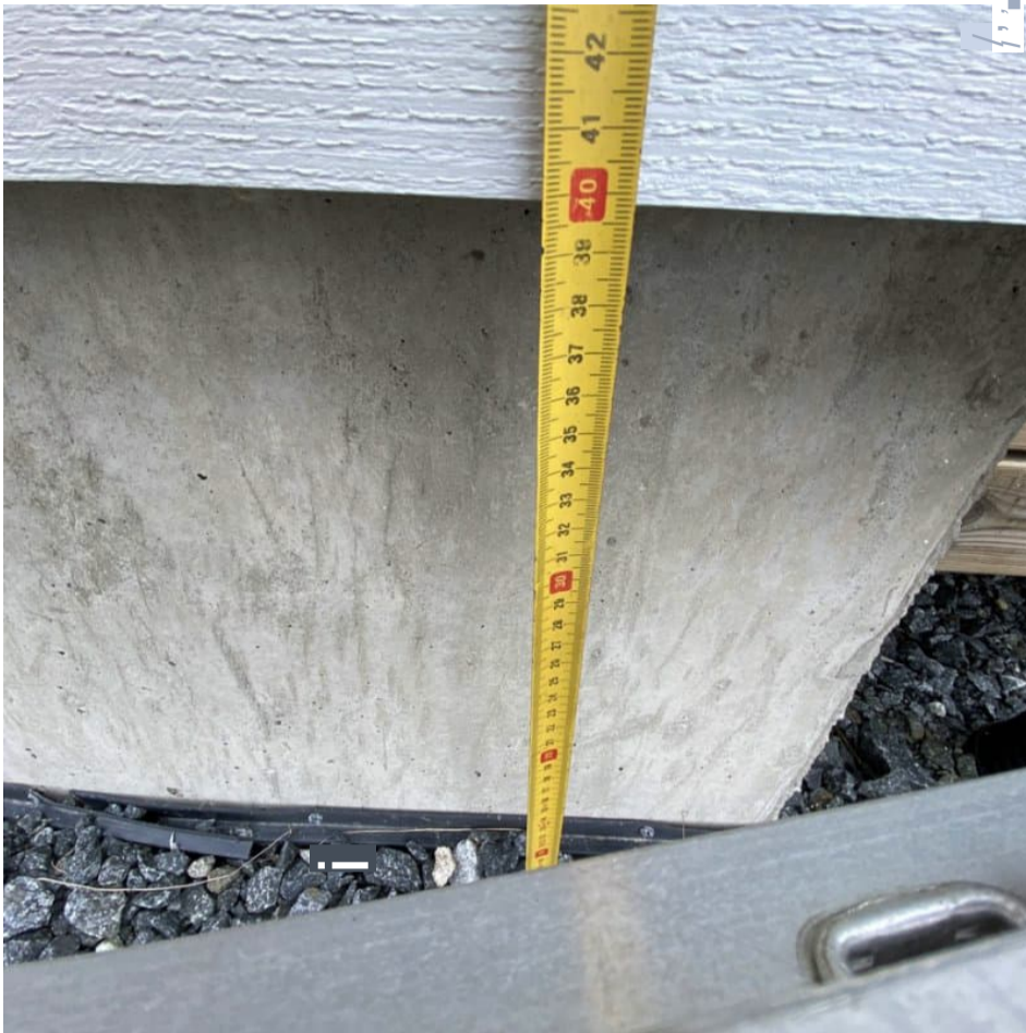
7. Yleiskuva: Sokkelin korkeudeksi mitattiin noin 400 mm. Sokkelin suosituskorkeus on min. 300 mm rakenteiden kosteusrasituksen minimoimiseksi (kinostuva lumi, roiskevesi, kapillaarinen kosteus).
