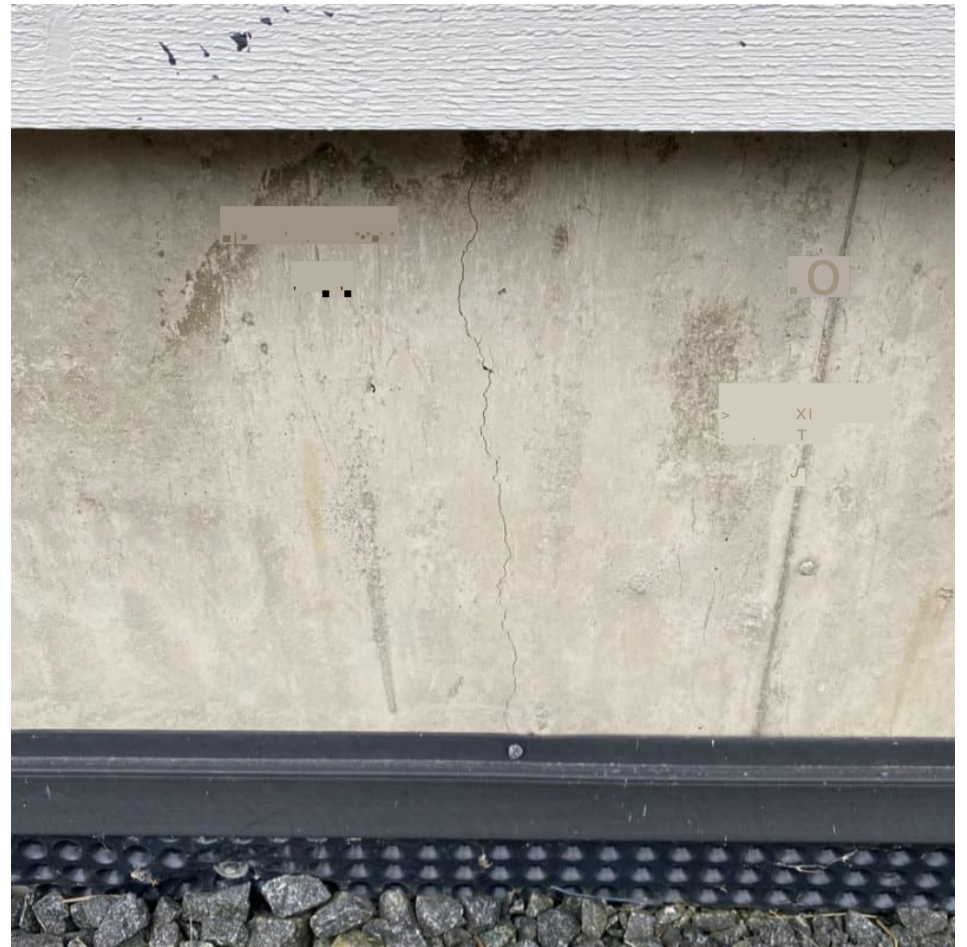
8. Huomio: Sokkelissa havaittiin yksittäinen halkeama. Halkeama on tarkastushetkellä pieni, eikä sen arvioitu aiheuttavan nykyisellään merkittävää rakenteellista riskiä (luonteeltaan esteettinen).
