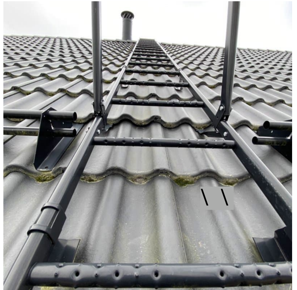
5. Yleiskuva: Vesikatolle on asennettu huoltotie savupiipulle asti. Huoltotien asennuksessa ja kunnossa ei havaittu puutteita.
