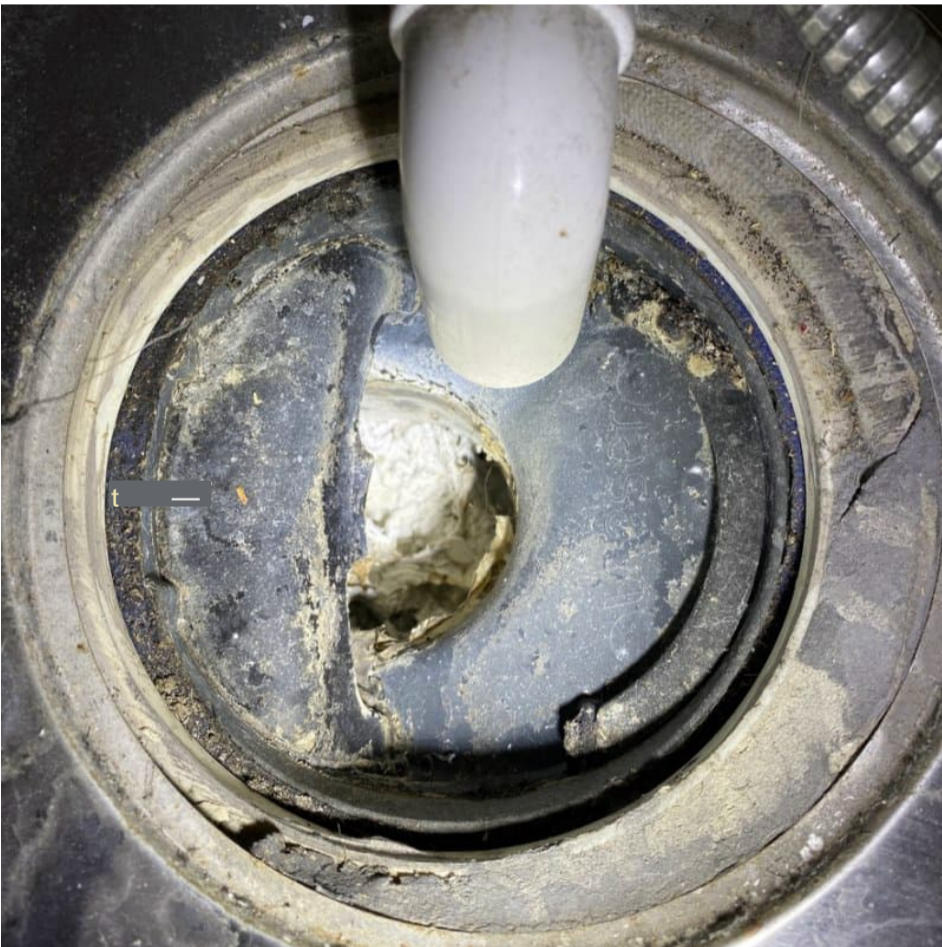
8. Huomio: Lattiakaivoissa on orgaanista ainetta ja kaivot ovat kuivuneet. Kaivojen säännöllinen puhdistus estää tukkeutumiset, niiden käyttöikä pitenee ja toiminta paranee. Kaivojen puhtaus vaikuttaa myös sisäilman laatuun.
