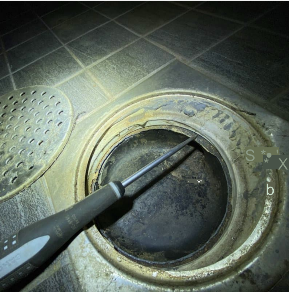
4. Yleiskuva: Saunan lattian vedenpoisto on järjestetty kuivakaivolla. Kuivakaivosta havaittiin vahvikekangas kiristysrenkaan alta. Kaivon asennus on näkyviltä osin nykyohjeiden mukainen.
