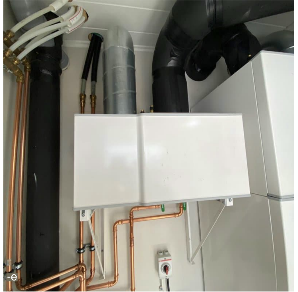
10. Yleiskuva ilmanvaihdon tuloilmamoduulista.
