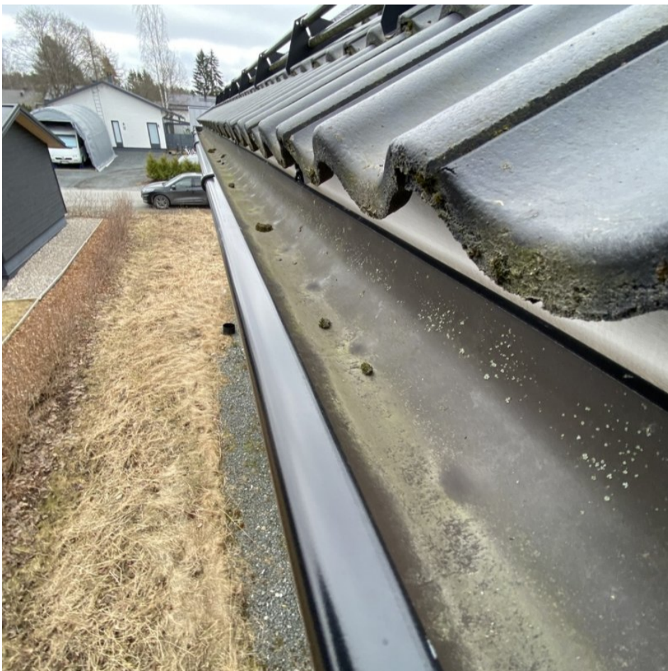
6. Yleiskuva: Vesikourut ovat tarkastetuilta osin kunnossa ja puhtaat. Kourujen puhtaudesta tulee huolehtia säännöllisellä huollolla hallitun sadevesien poisjohtamisen varmistamiseksi.
