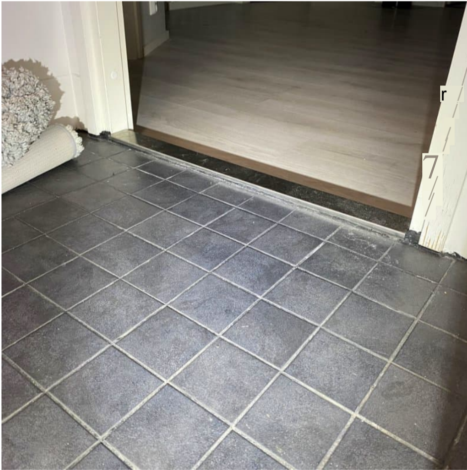
3. Yleiskuva: Erillisen pesuhuoneen ja kuivien tilojen välille on asennettu tulvakynnys.
