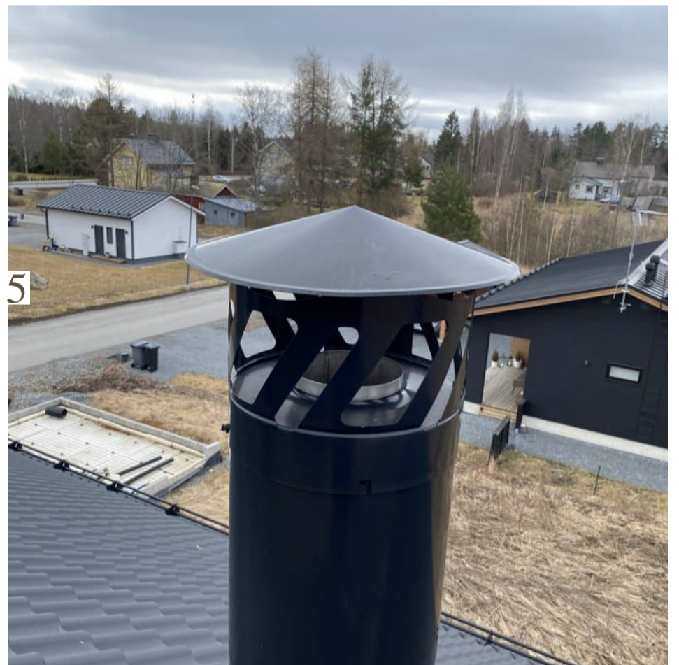
11. Yleiskuva: Savupiipun päälle on asennettu sääsuoja (hattupelti). Sääsuoja estää lumen ja veden pääsyä hormiin.
