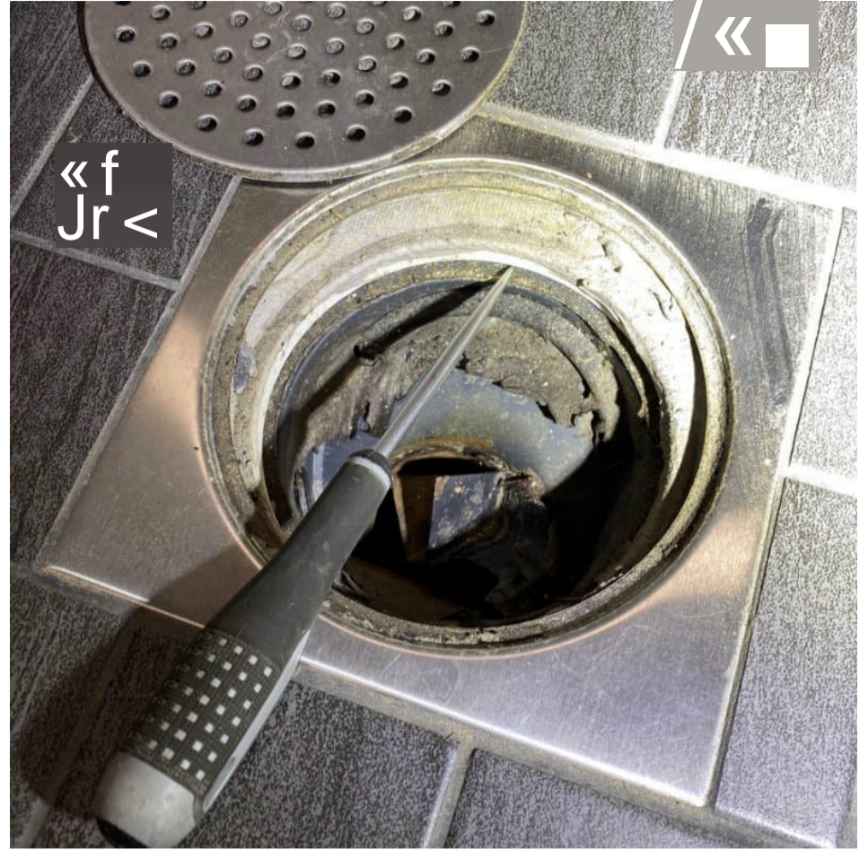
7. Yleiskuva: Alakerran pesuhuoneen lattiakaivosta havaittiin vahviekangas kiristysrenkaan alta. Lattiakaivon asennus on näkyviltä osin nykyohjeiden mukainen.
