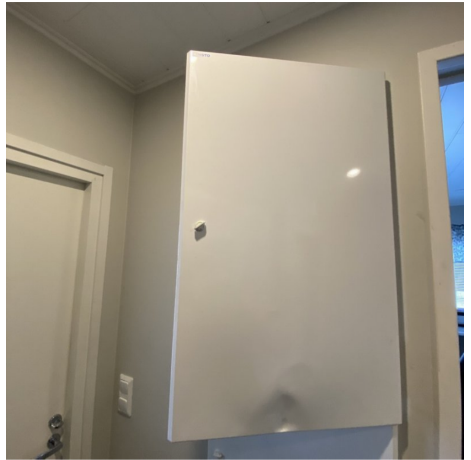
3. Yleiskuva: Ryhmäkeskus on suojattu määräysten mukaisesti.
