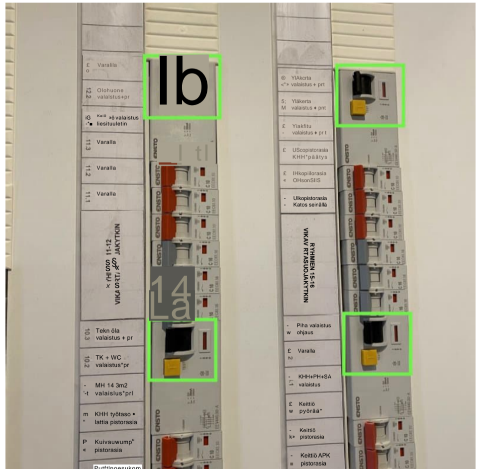
5. Yleiskuva: Asunnon vikavirtasuojakytkimien toiminta testattiin tarkastuksen aikana. Oikein toimiva suoja laukeaa testipainikkeesta ja katkaisee virran sen takana olevista piireistä ja sähköllä toimivista laitteista. Vikavirtasuojakytkimien toiminnassa ei havaittu puutteita.
