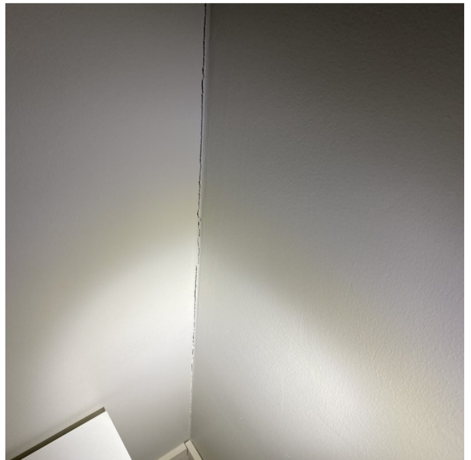
12. Yleiskuva: Rakennuksen sisäseinissä havaittiin muutamia halkeamia. Halkeamat ovat tyypillisiä puurunkorakenteisessa rakennuksessa (tyypillisesti esteettinen vaurio).
