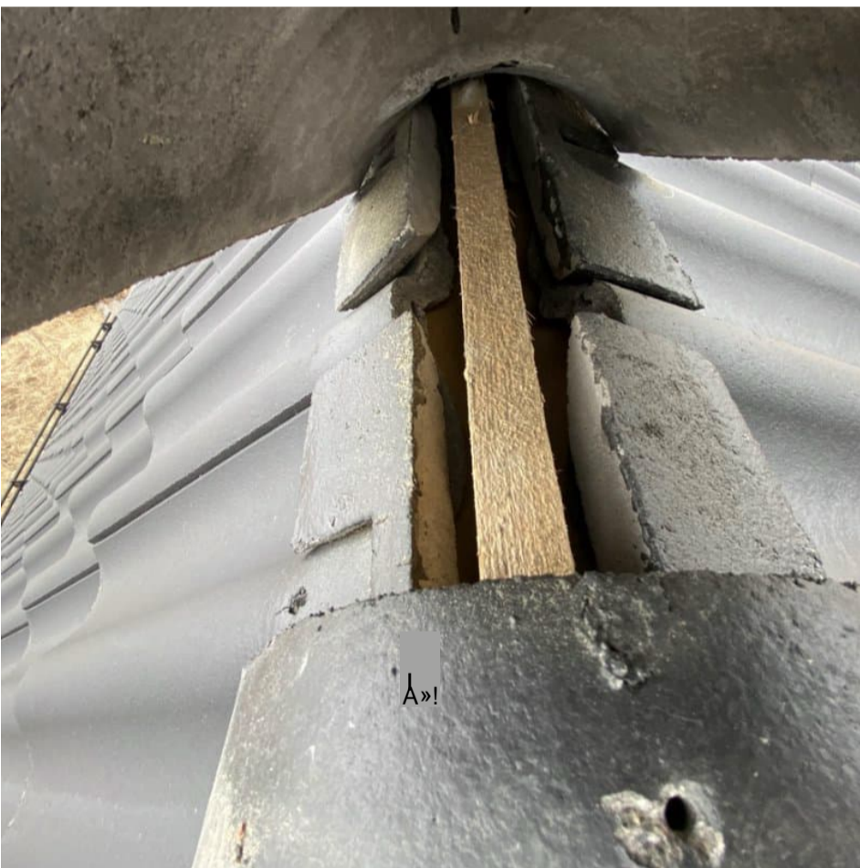
10. Yleiskuva: Harjatiilien alle on asennettu suositusten mukainen harjatiiviste. Harjan tiivistämisellä voidaan estää orgaanisen jätteen kulkeutuminen yläpohjaan ja aluskatteen päälle.
