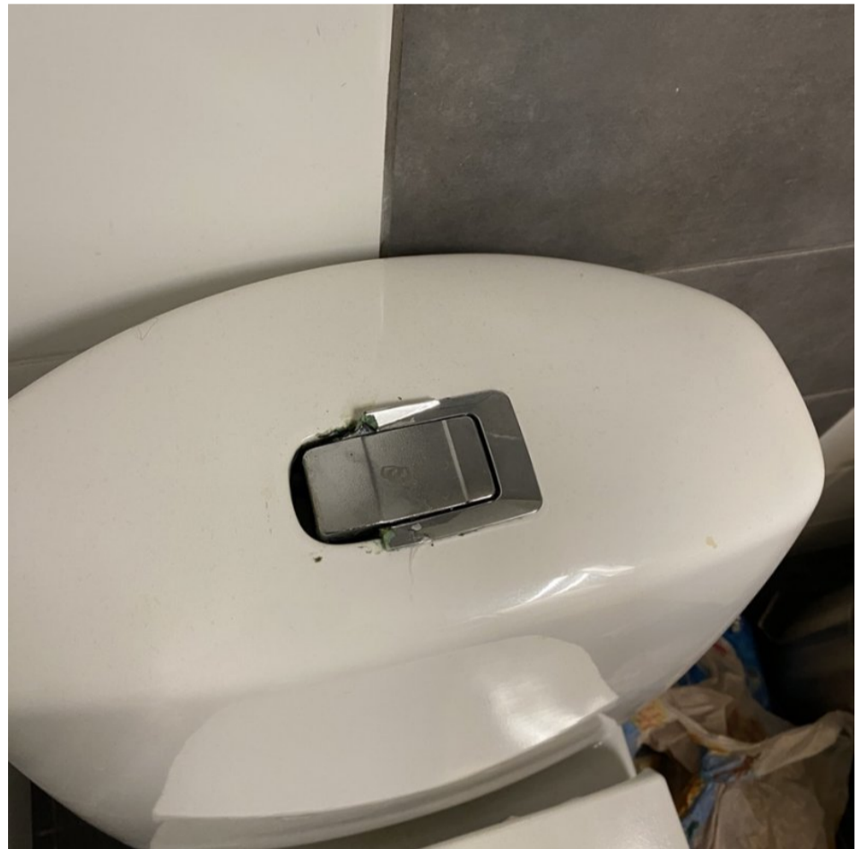
9. Huomio: Erillisen WC-tilan istuimen huuhtelupainikkeen reunus on vaurioitunut.
