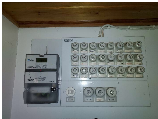
Rakennuksen sähköjärjestelmä on alkuperäinen ja teknisen käyttökänsä loppupäässä.
