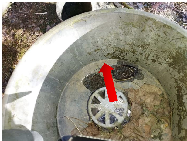
Sadevesijärjestelmän keruukaivo/suppilo oli halki
