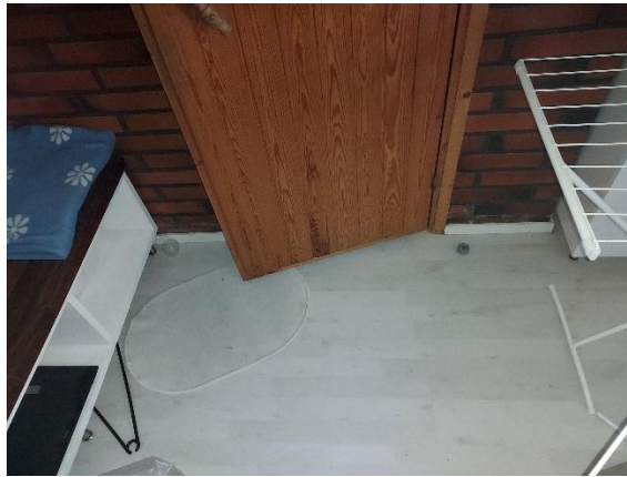
Pesuhuoneen ja khh:n alueella tiilistä muurattujen väliseinien alaosissa on kosteutta ja alunaa
