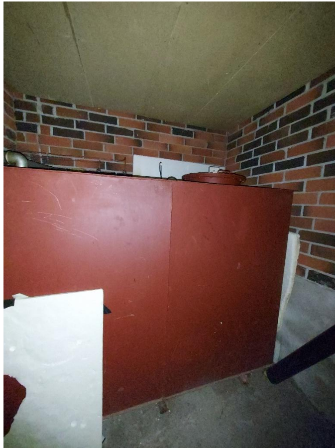
Teräksinen öljysäiliö sijaitsee erillisessä, öljysäiliötä varten rakennetussa huonetilassa autotallin päädssä
