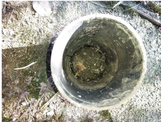
Sadevesiviemäroinnissä havaittiin tukkoisuutta
