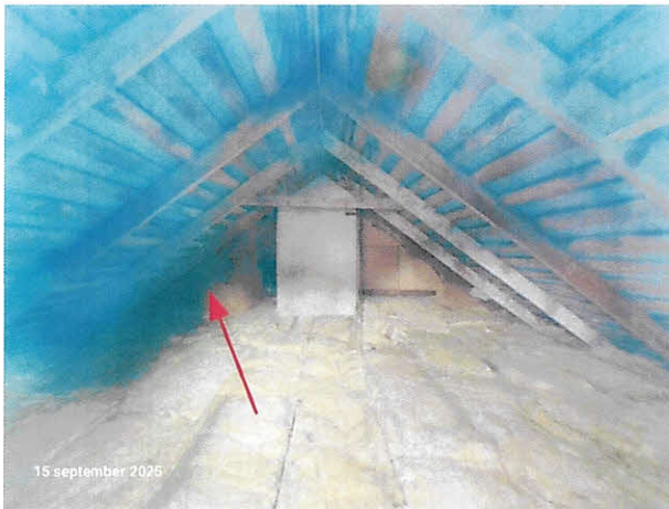
Överblicksbild mellantaksutrymme genom fönster i gaveln på husets norra sida. Fuktmärken observerades (pil). Undertak fattas under plåttaket.
