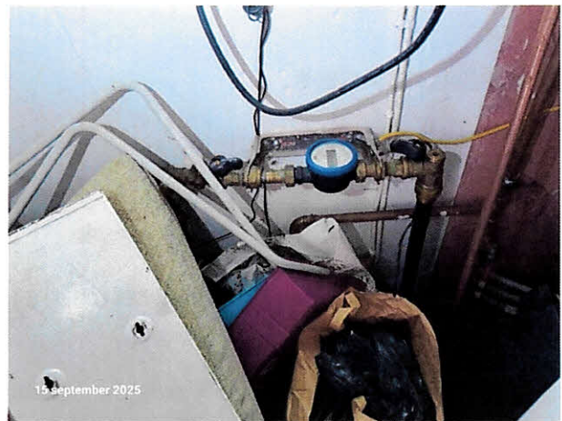
Inkommande vattenledning och vattenmätare i teknikrum. Inkommande vattenledning av plast.
