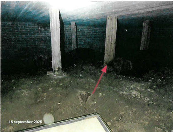
Överblicksbild kryputrymme under huset. Gjutformar av trä finns kvar runt om betongpelarna på flertalet pelare. Rekommenderas att dessa tas bort då de suger åt sig fukt från marken och ruttar. Mikrobiella skador såsom mögel och röta kan orsaka negativ inverkan på inomhusmiljön om oren luft från krypgrunden tränger in genom bjälklagets otätheter.
