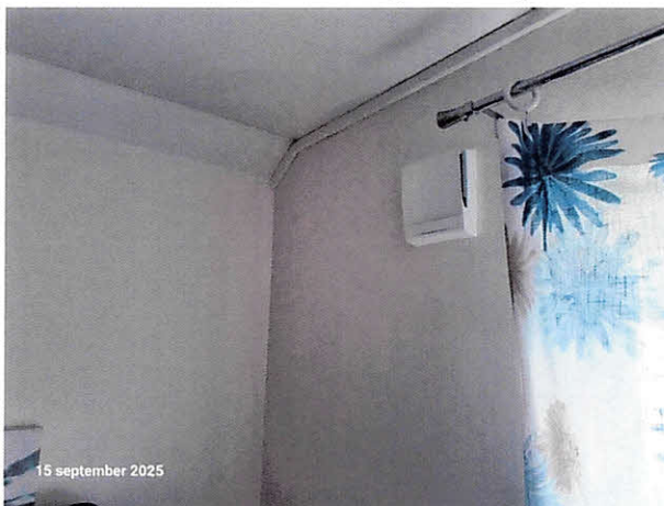
Friskluftsventiler observerades runt om i huset. gick inte att komma åt att se om ventilerna var öppna eller stängda.
