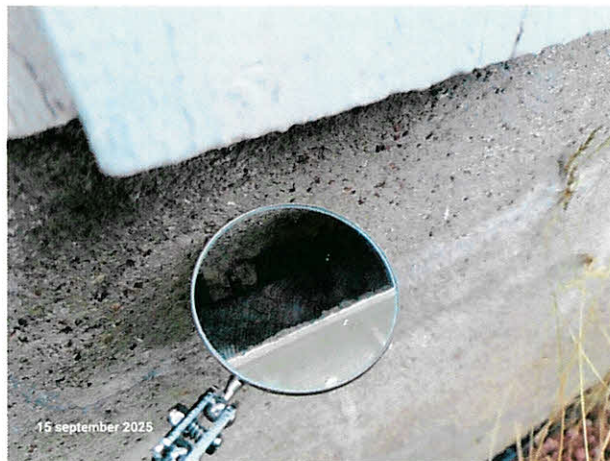
Öppen luftspalt observerades bakom panelens lockbrädor. Panelens nedre ändor ej målade vid fasadmålning.
