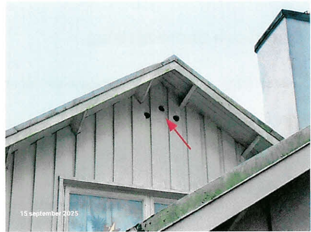
Ventilering av mellantaksutrymme via hål i gavlar.
