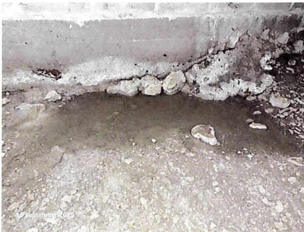
Stående vatten observerades i kryputrymmet. Tyder på att marken är fuktig trots att man dränerat kring huset.
