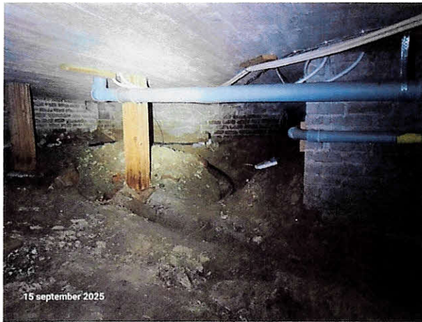
Oisolerade avloppsrör observerades i krypgrunden. Rekommenderas att man isolerar rören för att minska på frysrisken.
