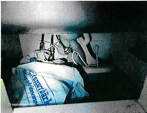
Bruksvattenrör av koppar och avloppsledningar av plast observerades.
