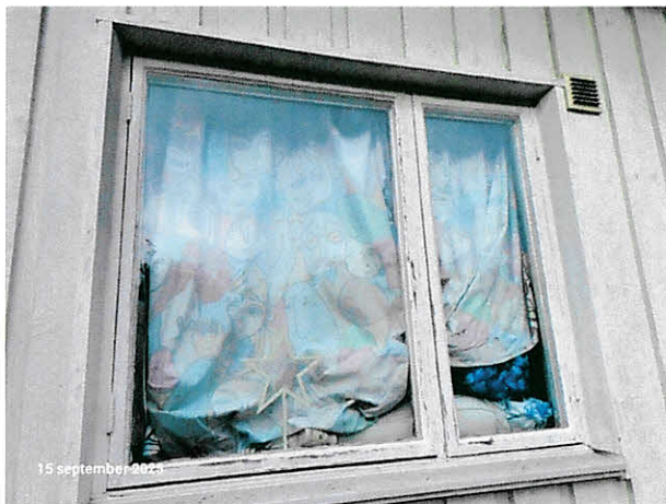
Överblicksbild fönster. Fönstren flagnar färg och är i behov av underhåll.
