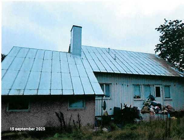
Överblicksbild vattentak från husets västra sida.
