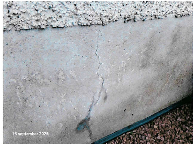
Sprickor observerades på sockeln runt om byggnaden. Inga bomljud observerades vid knackning.
