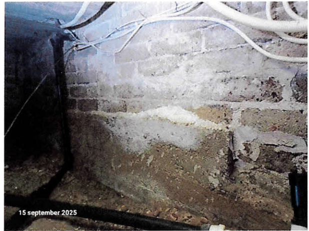
Kalkutfällningar observerades på insidan av grundmuren. Tyder på att konstruktionen belastas av markfukt.
