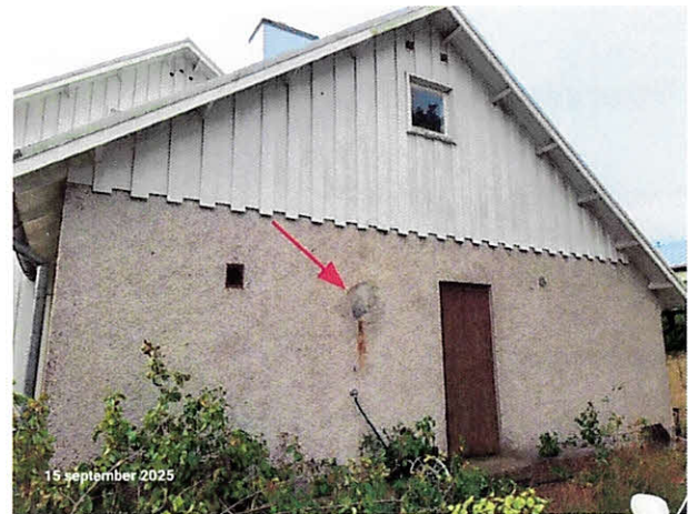
Fasad mot norr. Rappad fasad på del av huset. Ställvis har fasaden reparerats (pil). Fönster i gavelns övre del endast in till mellantaksutrymme.
