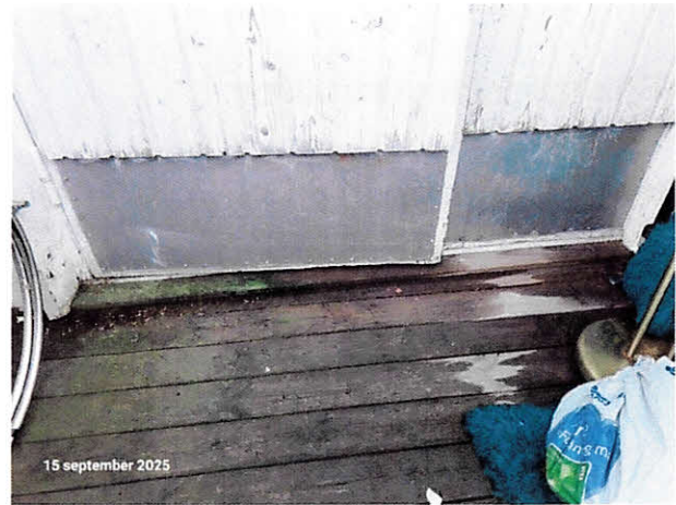
Tröskelplåt saknas vid ytterdörren.
