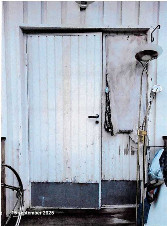
Överblicksbild ytterdörr. Dörren i behov av underhåll, alternativt förnyelse.
