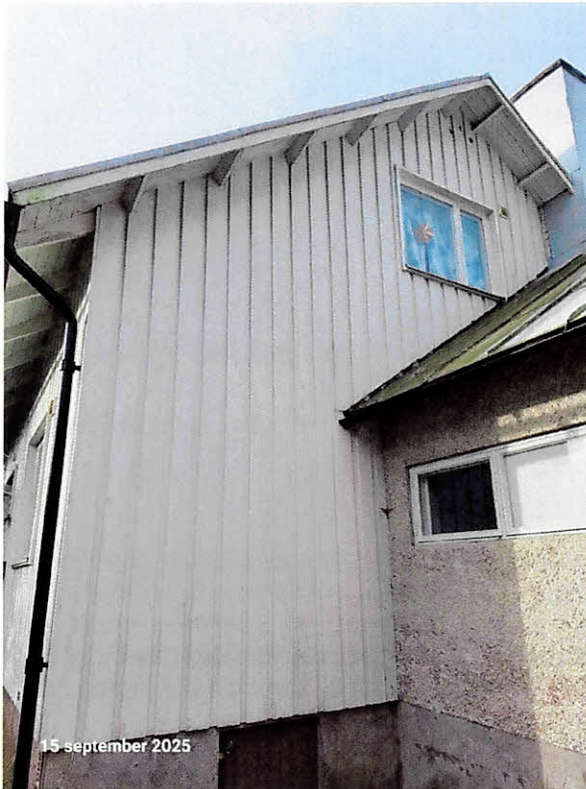
Fasad mot norr. Fasaden observerades ställvis smutsig och en fasadvätt och målning rekommenderas utförs inom de närmaste åren.
