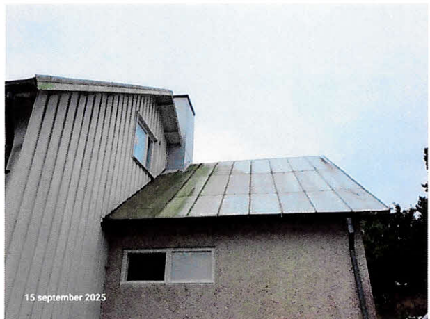
På husets norra del observerades mossa, alger och smuts på plåttaket.
