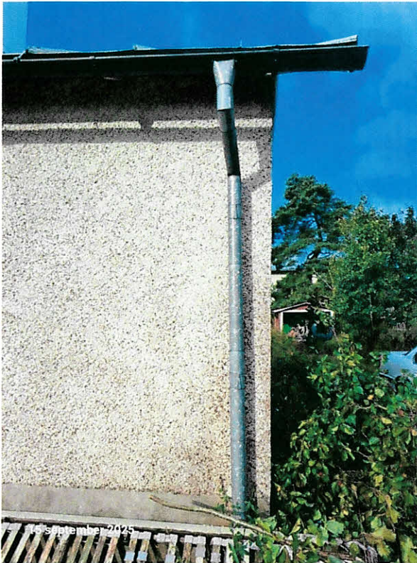
Hängrännor och stuprör av både äldre galvaniserade rör och modernare målade rör observerades.
