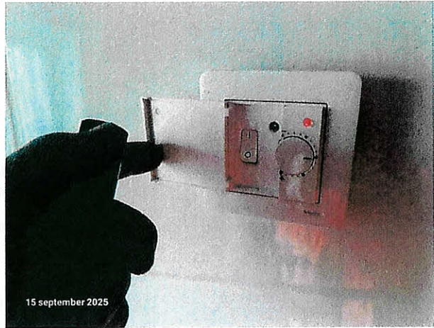
Elektrisk golvvärme i ett av badrummen.
