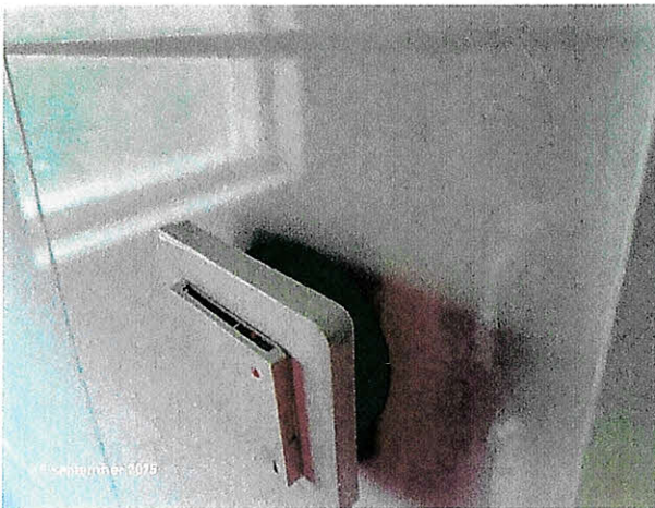
Termostaten till golvvärmen lös från väggen.
