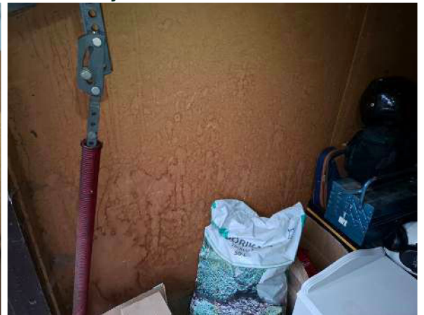
38. Kosteusjälki autotallin seinässä
