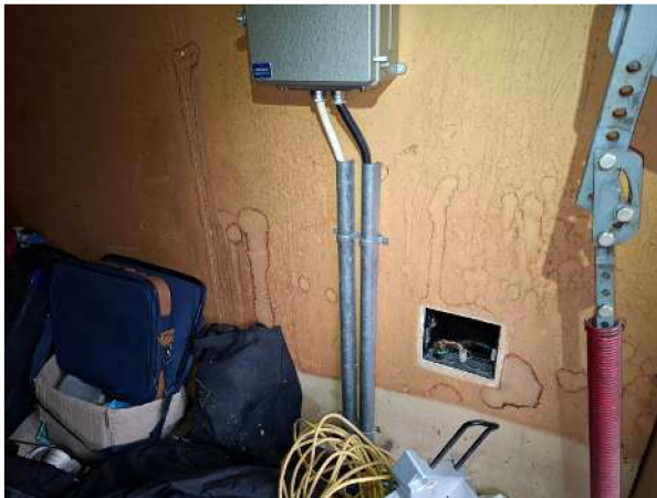
37. Kosteusjälki autotallin seinässä
