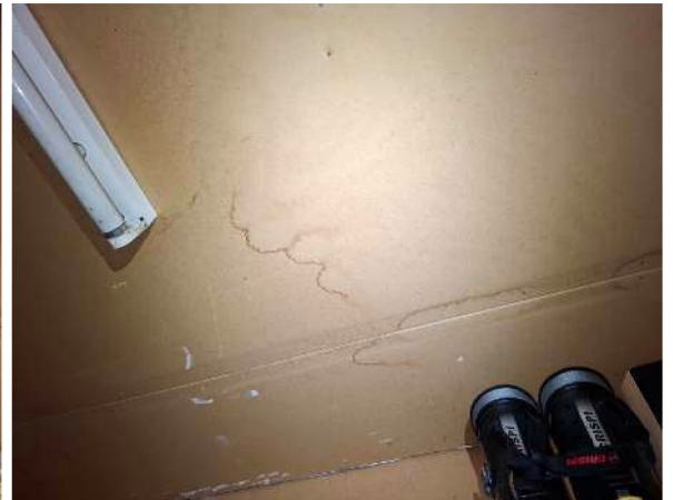
36. Kosteusjälki autotallin katossa
