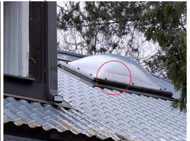
24. Kattoikkunan kuvun halkeama
