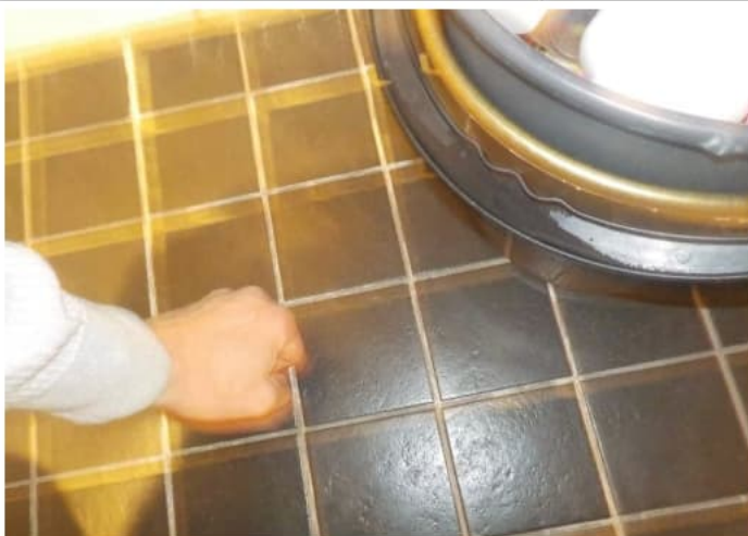
Toisen suihkun edustalla lattialla havaittiin hieman irti alustastaan olevia ns. kopolaattoja.
