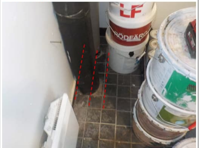
Teknisen tilan lattialla havaittiin radonputken ja viemärin tuuletusputken läheisyydessä paikoin hieman kohon- neita lukemia.
