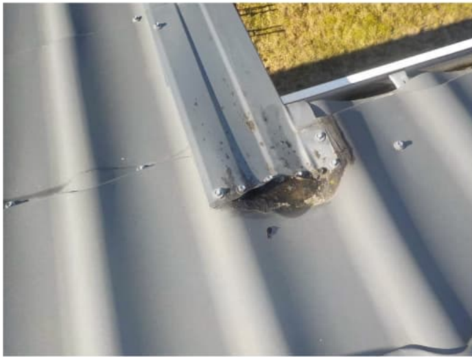
Etupihan puoleisella räystäällä pidemmälle ulottuvan lappeen liitoskohdassa päätyräystäspellin yläosassa havaittiin hieman vääntymää.
