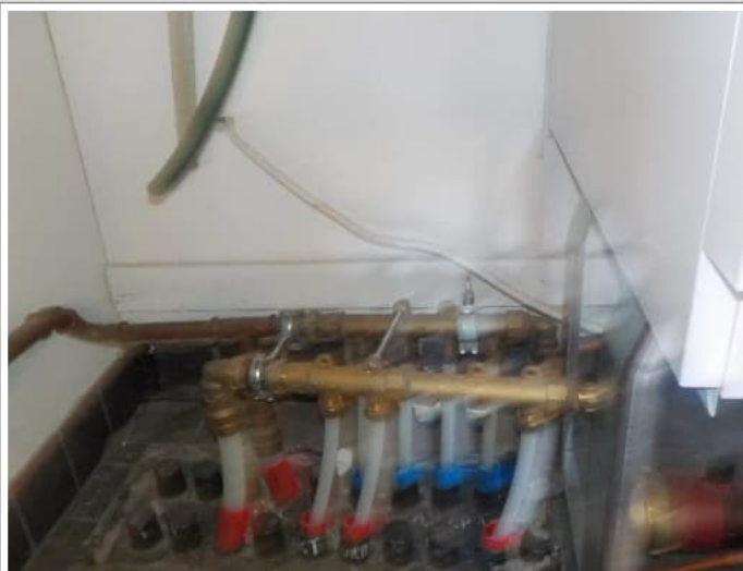
Lämminvesivaraajalle johdettu sähköjohto.
