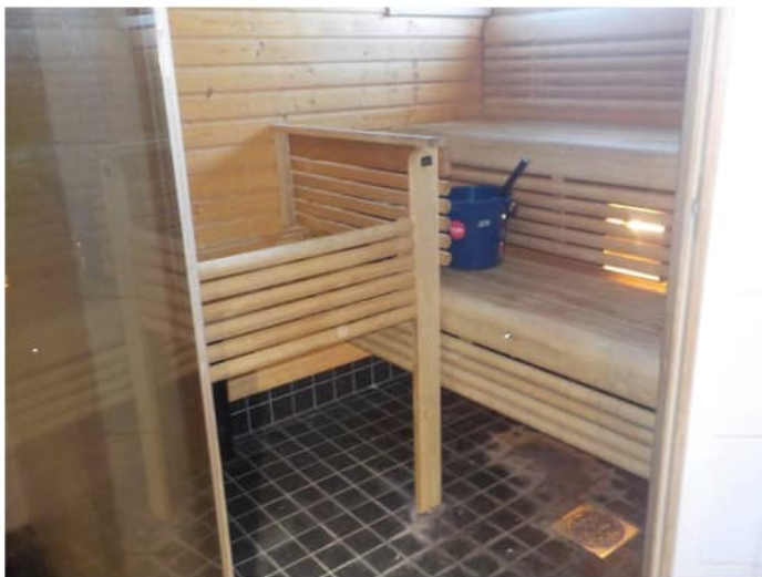
Lattialle oli kertynyt paikoin selvemmin likaa ja kalkkia.
