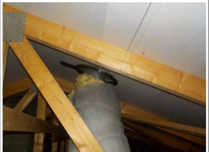
Muutaman putken/kanavan yläosien eristyksissä havaittiin vesikaton läpivientien alapuolella hieman puutteita.
