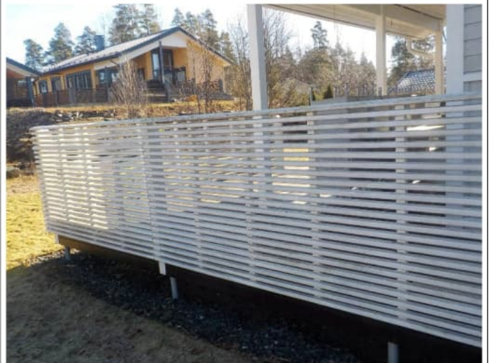
Mm. kaiteet altistuvat helpommin jatkuvalla säärasitukselle.
