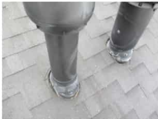
Kuva 4b. Läpiviennissä ei havaittu tiiveyspuutteita.
