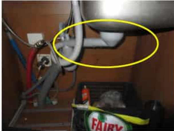
Kuva 5.5a. Allaskaappi. Poistoviemärin liitokset on puutteellisesti tiivistetty.
