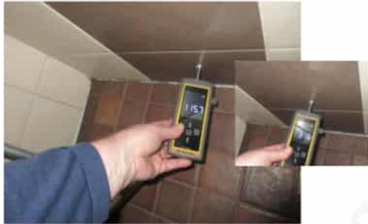
Kuva 5d. Patoutunutta kosteutta.
