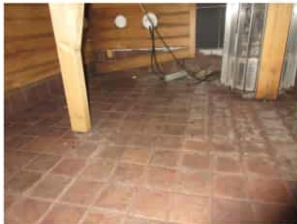
Kuva 5.2b. Sähköjohtoja lattialla, paneeli irronnut.
