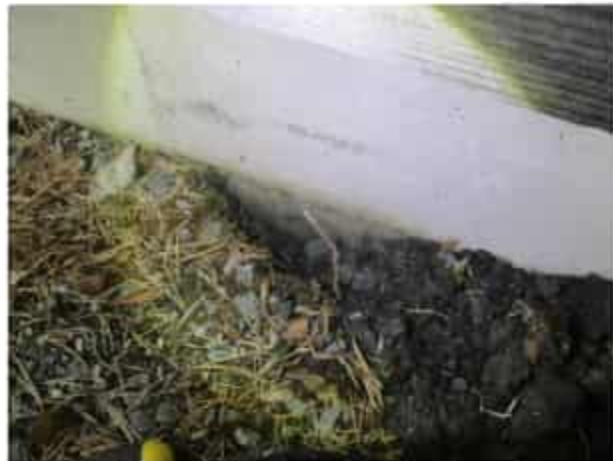
Kuva 1b. Sokkelin kosteuseristystä ei havaittu.
