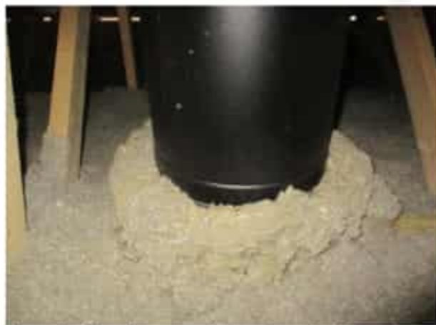
Kuva 4h. Havainnon mukaan piipun läpiviennissä ei ollut palamatonta eristevillaa.
