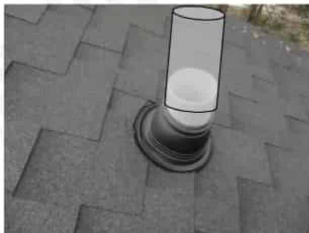
Kuva 4c. Viemärin tuuletusputki on matala, jolloin se voi jäädä lumivaipan alle, aiheuttaen ajoittain hajuhaittaa sisätiloissa. Jatkokappale mallinnettu kuvaan.
