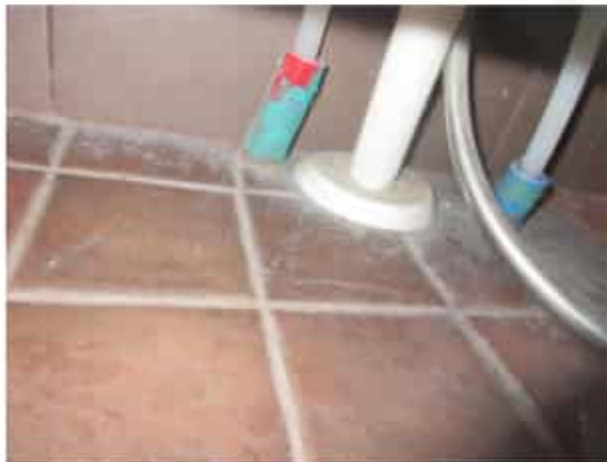
Kuva 5.4e. Vedeneristyksistä saatiin havainto.
