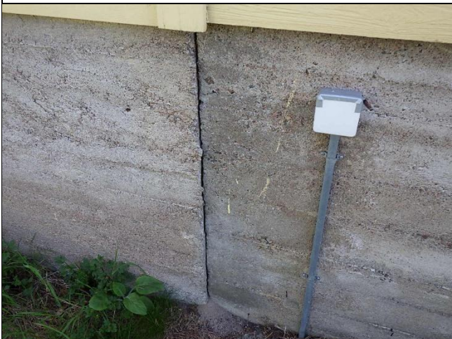
Kuva 3. Vanhan ja uuden osan välillä sokkelissa rakoa.
