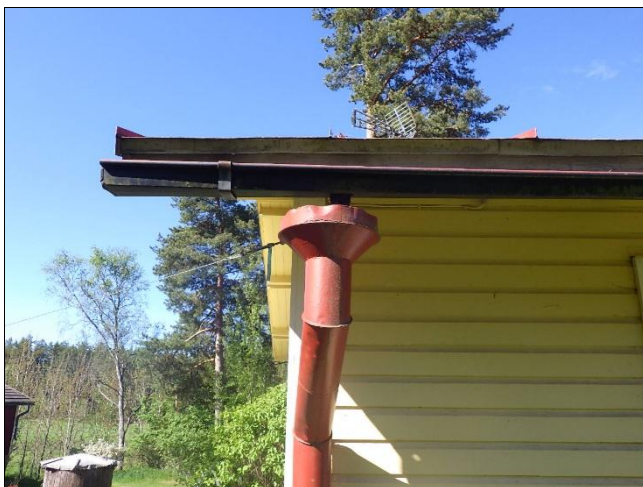
Kuva 10. Syöksytoria ei olla kiinnitetty räystäskouruihin.
