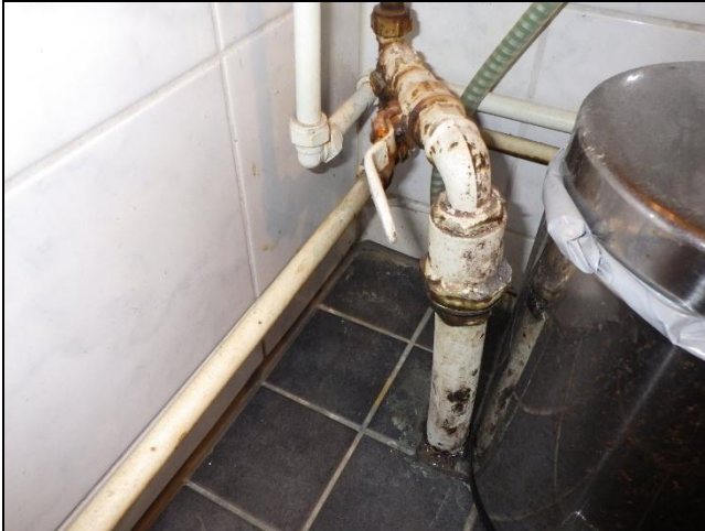
Kuva 37. Ikään tynnyttä käyttövesilinjaa wc-ti- lassa.
