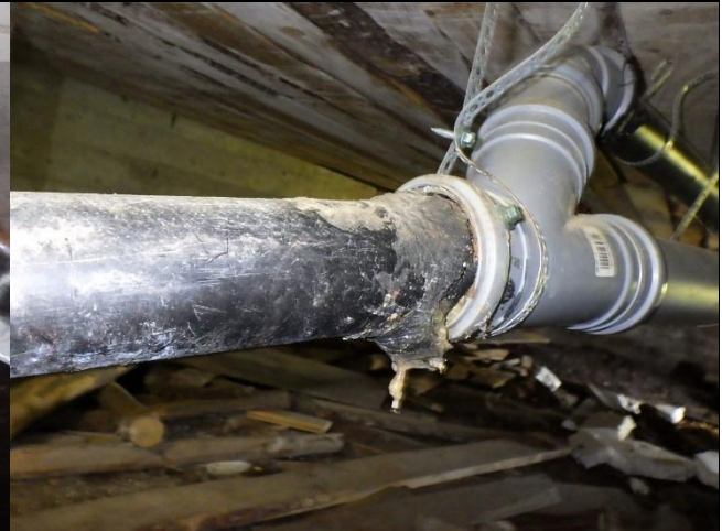
Kuva 38. Ryömintätilassa viemäriputkien liitos- vuotaa tiputtaen.
