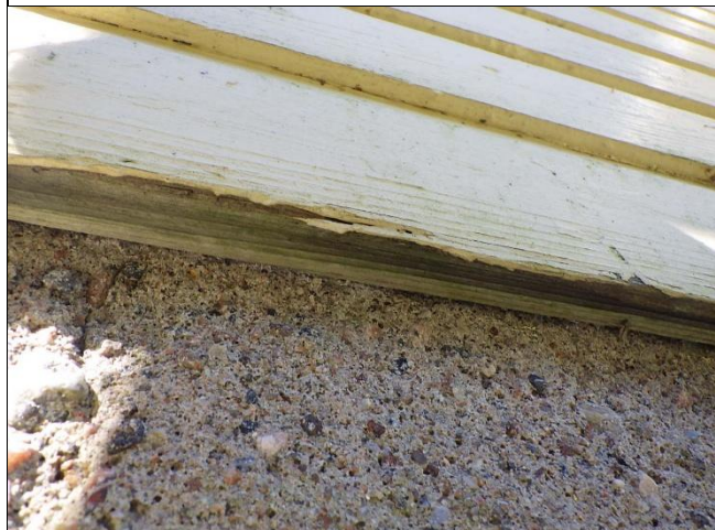
Kuva 14. Julkisivuverhoilun taustalla ei ole tuuletusrakoa.
