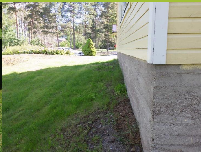
Kuva 9. Vierustan täyttömaa hienoaineista.
