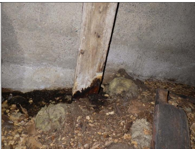
Kuva 6. Paikoin puurakenteisia kannattimia vasten kosteaa maata.
