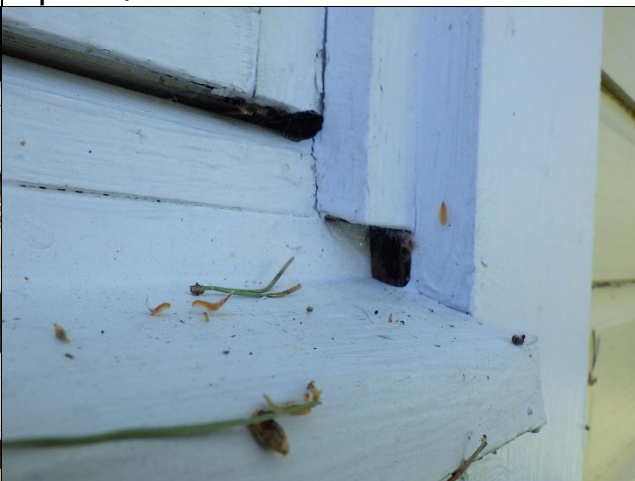
Kuva 18. Nykyisellään esimerkiksi viistosateella vesi voi päätyä seinärakenteeseen.
