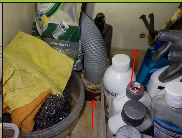
Kuva 28. Läpiviennin aukko ja saumat tiivistämättä.
