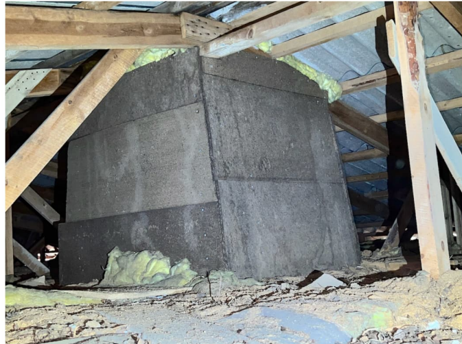
Kuva 7. Kattoikkunan läpiviennin kohdalla havaittavissa vuotojälkiä.
