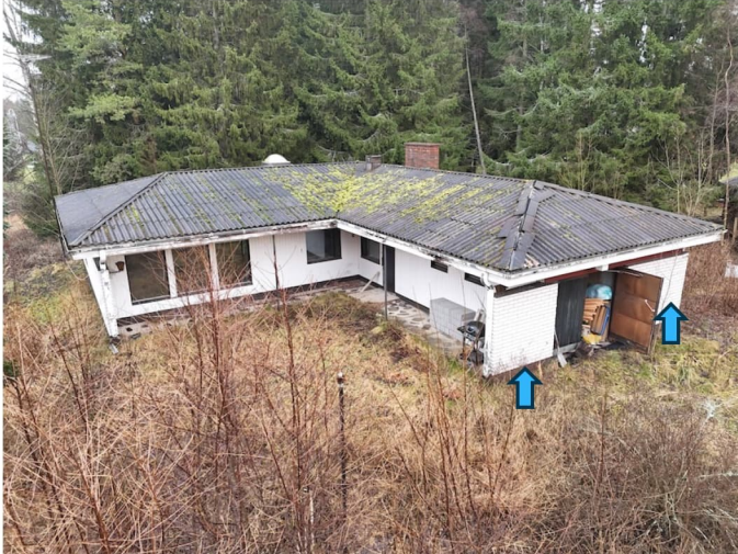
Kuva 8. Tiiliverhous on osittain autotallin kohdalla irronnut puurungosta.
