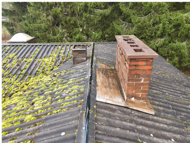
Kuva 5. Katon käyttöikä on saavutettu
