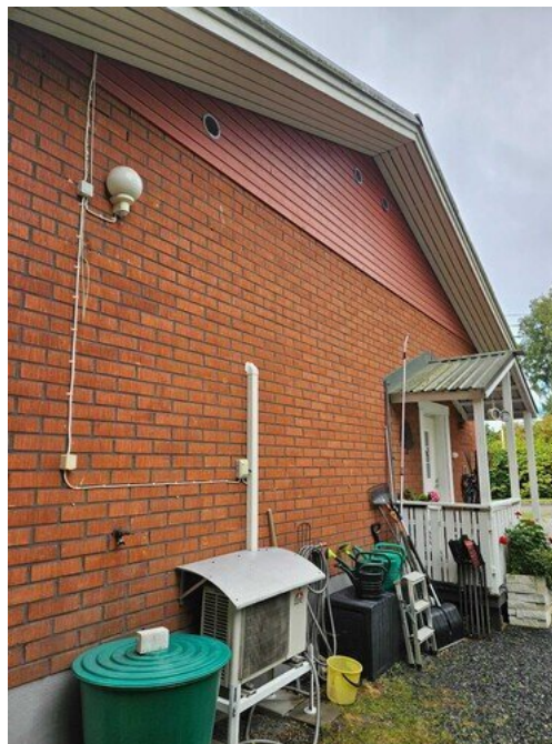
Kuva 21 Julkisivuverhouksesta ei kirjattu tarkastuksen aikana oleellisia huolto- tai korjaustarvehavaintoja
