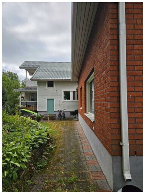
Kuva 4 Pintamaan muotoa rakennuksen sivulla.
