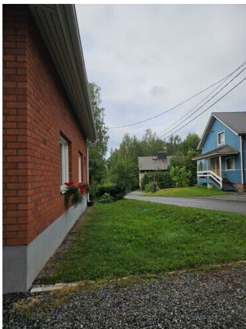
Kuva 3 Pintamaan muotoa rakennuksen sivulla.
