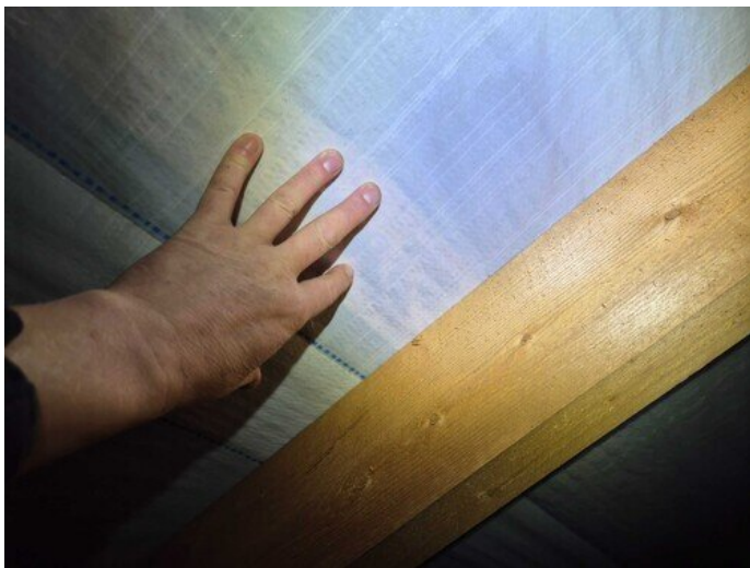
Kuva 39 90-luvun lopussa aluskatteen asennussuosituksissa on ohjeistettu, että aluskatteen yläpuolelle tulisi asentaa korokerima, jolloin aluskate tuulettuu myös yläpuolelta.
