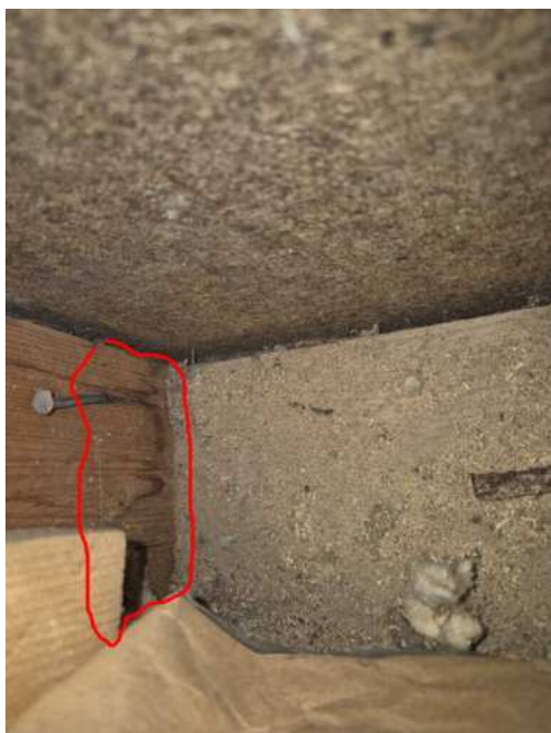
Kuva 17 Seinän alaohjauspuu kuvattuna rakenteen sisäpuolelta. Pystytolpan alapäässä todettiin kosteuden tiivistymisestä aiheutuneita jälkiä.
