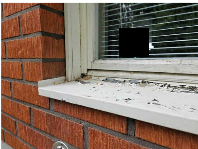
Kuva 29 Vesipellityksissä ja smygilaudoituksissa havaittiin kuluneisuutta ja epätiiviyttä kohtia.
