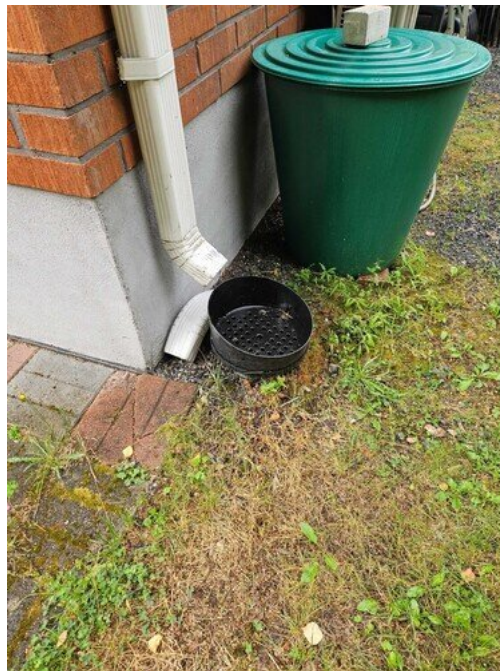
Kuva 9 Osa syöksytorvista todettiin olevan liian korkealla suhteessa räystääsvesikaivon reunaan
