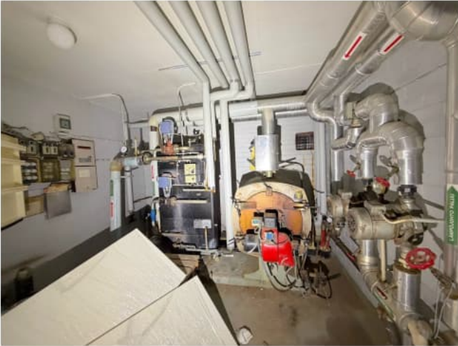
Kuva 18. Lämmöntuotona kaukolämpö sekä öljy. ( ei toimintakuntoisia)
