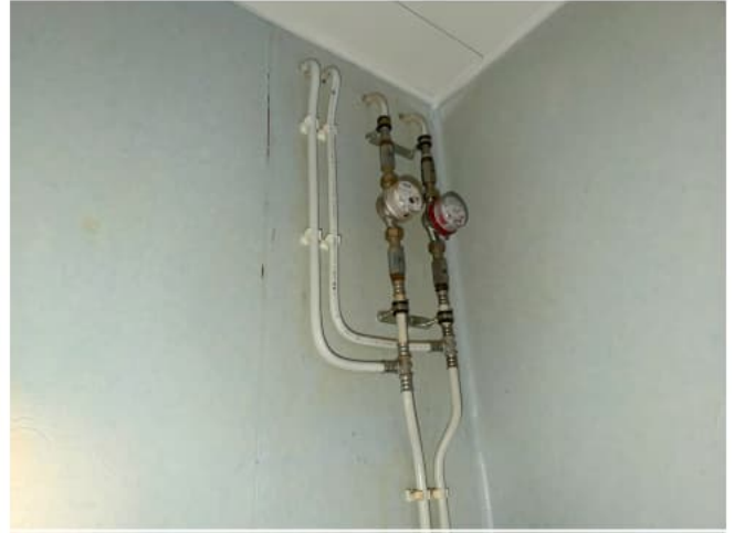
Kuva 21. B-talossa pääosin komposiittiputkistoa
