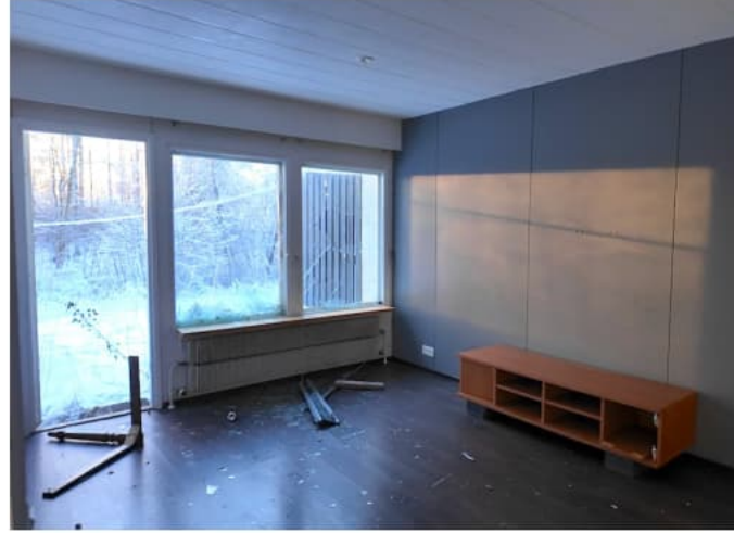
Kuva 25. Asunto 1 Olohuone (ikkunat rikottu)
