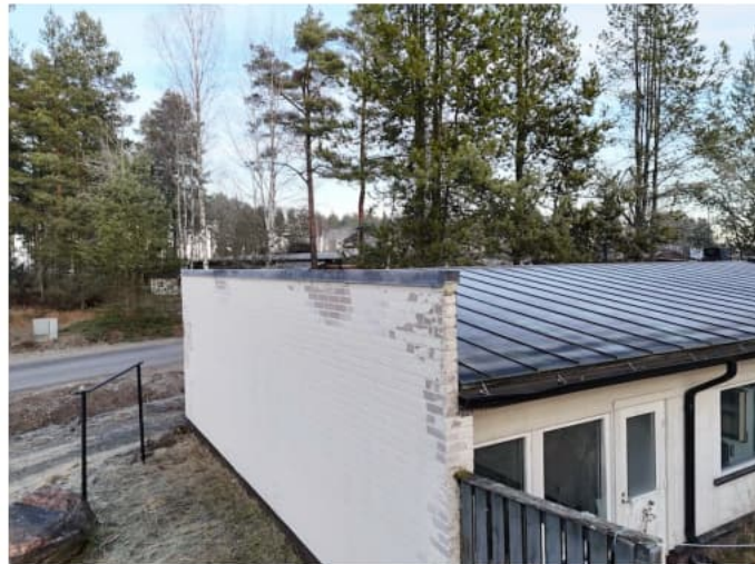
Kuva 12. Tiiliverhous on osittain kostunut
