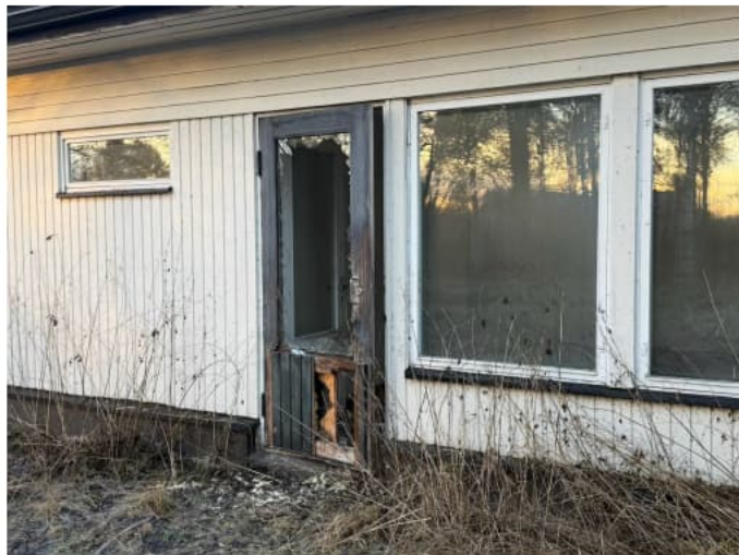
Kuva 14. Ikkunoita-ja ovia on rikottu
