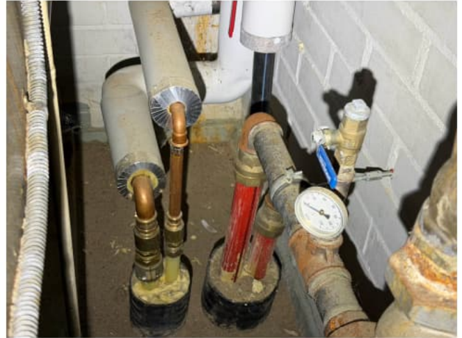
Kuva 19. Talojen välinen lämmön- ja veden siirtokanava on jossain vaiheessa uusittu.
