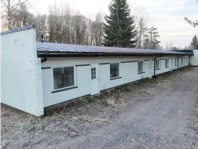
Kuva 11. Ulkoverhouksen kunto on tyydyttävä
