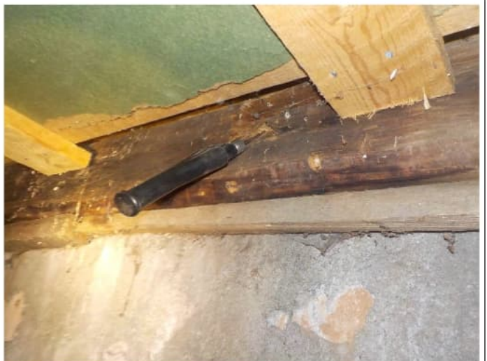
Pistokokein ryömintätilasta käsin tarkastettuna kuistin ulkoseinän alasidepuussa/-hirressä havaittiin yhdessä kohtaa vanhaa lievää pehmentymää/lahoa
