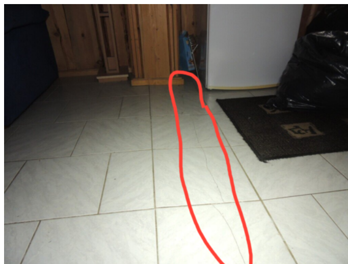
Kuva 42 Lattiassa korkeuseroa ja laatat halki
