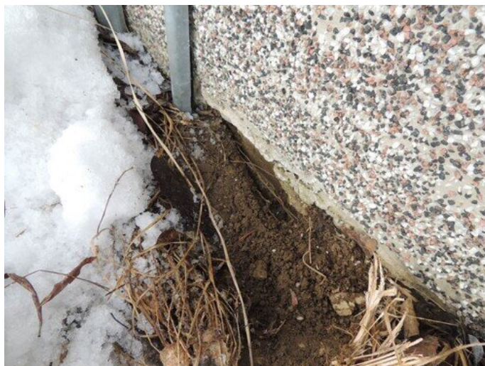
Kuva 12 Alapihan puolella ei havaittu kosteuskatkoa.
