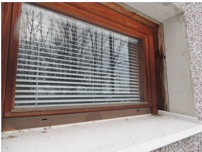
Kuva 19 Alakerrassa ikkunoista puutuu pielilautoja, puurakenteissa kastumisjälkiä ikkunan vierustalla.
