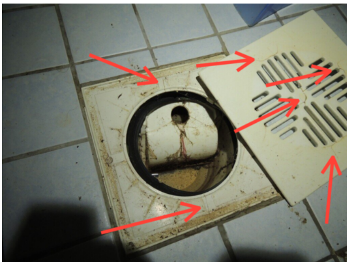
Kuva 55 Alakerran lattiakaivon kansiosissa halkeamia
