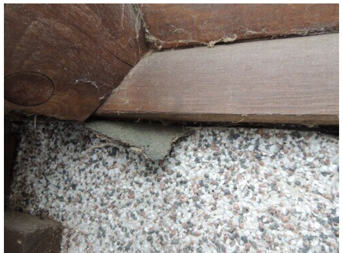
Kuva 18 Alimman hirren alla on kosteuskatko
