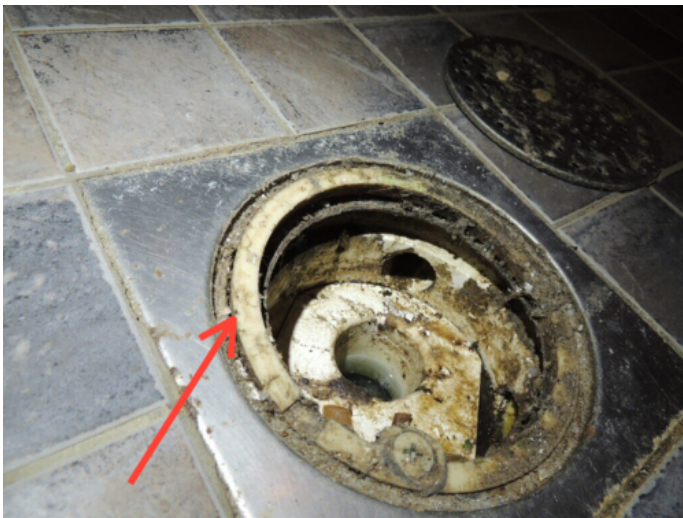
Kuva 60 Kaivon kiristysrengas on irti.
