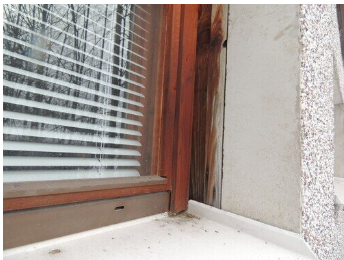
Kuva 20 Alakerrassa ikkunoista puutuu pielilautoja, puurakenteissa kastumisjälkiä ikkunan vierustalla.
