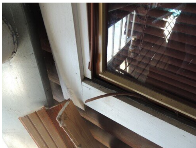
Kuva 22 Ikkunat tiivisteet irti, keskikerroksen makuuhuone.
