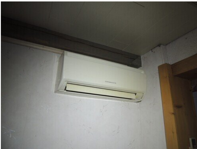
Kuva 67 Alakerrassa ilmalämpöpumppu, sisäyksikössä laakeri tms pitää ääntä.
