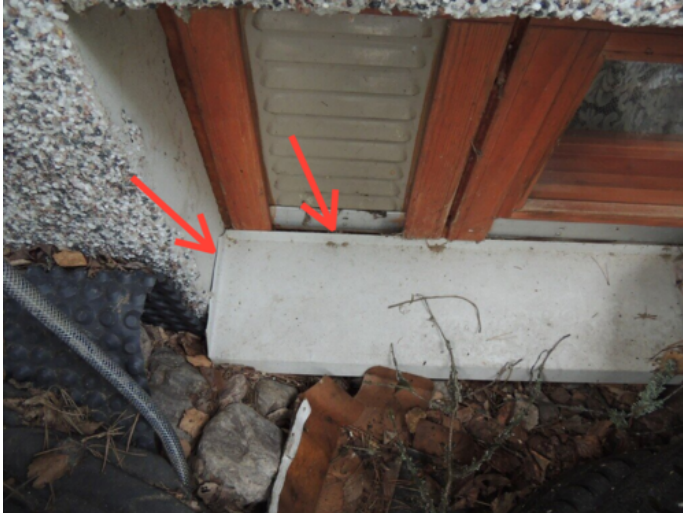
Kuva 26 pesuhuoneen ikkunan vesipellin liitokset epätiiviit.
