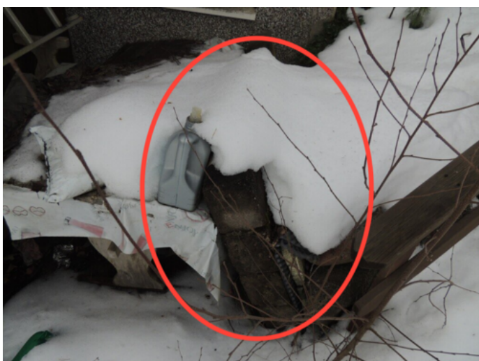
Kuva 13 Tukimuuri pettänyt ja kallistunut
