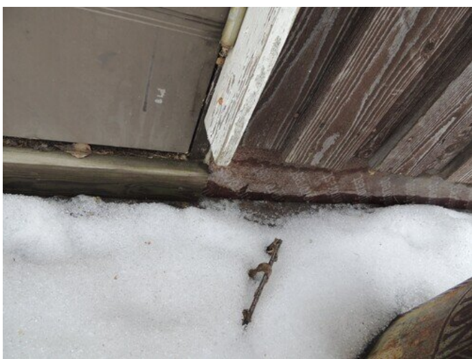
Kuva 7 Alakerran laajennusosalla puuverhous on liian lähellä maanpintaa. Samalla kohdalla sokkelissa käytetty vanerilevy kiinni maassa.
