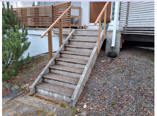
2. Ulkoportaita, käsijohde ei ulotu alas saakka
