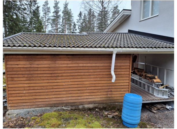
10. Sadevesien ohjausta, vedet ohjautuvat puuvajan seinään
