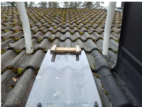
28. Talotikkaiden yläpään kiinnitys puutteellinen
