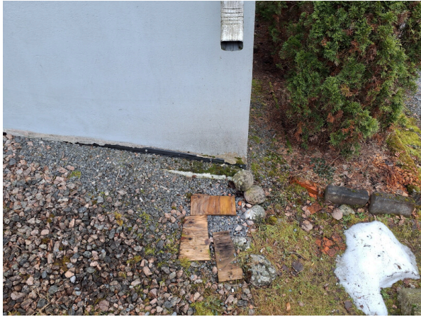
9. Sadevesien ohjausta, vesiä ei ole johdettu kauemmas rakennuksesta
