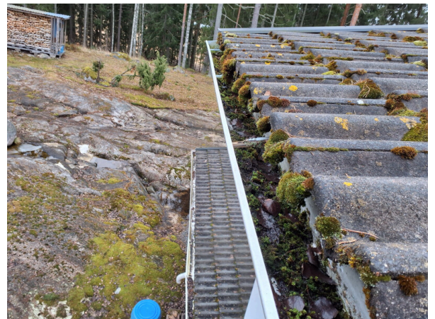
27. Sadevesikouruissa roskaa lehtiä yms.
