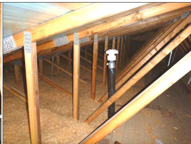
Kuva 20 Viemärin tuuletusputki päättyy yläpohjatilaa ja on varustettu alipaineventtiilillä
