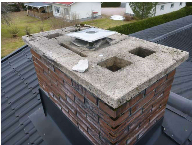
Kuva 17 Savupiippu ei ole varustettu sadehatulla
