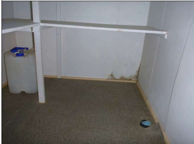
Kuva 21 Piipun vierustalla sisätiloissa on havaittu kosteusjälkiä
