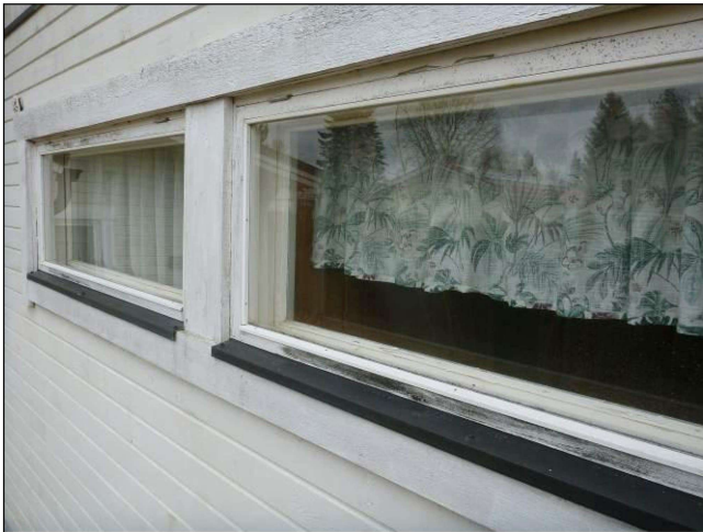
Kuva 13 Paikoin on huoltotarvetta ikkunoissa
