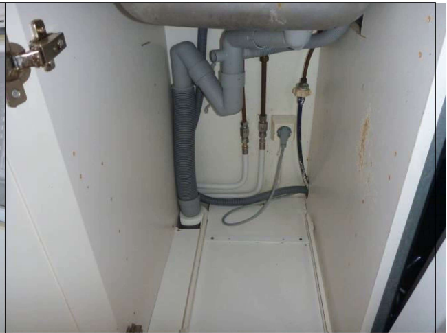
Kuva 31. Allaskaapin pohjalevy ei ole tiivistetty
