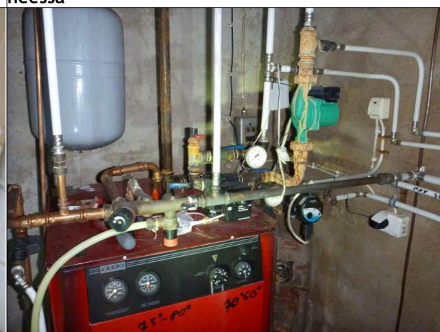
Kuva 44 Putkiliitoksia ovat paikoin auki pannuhuoneessa
