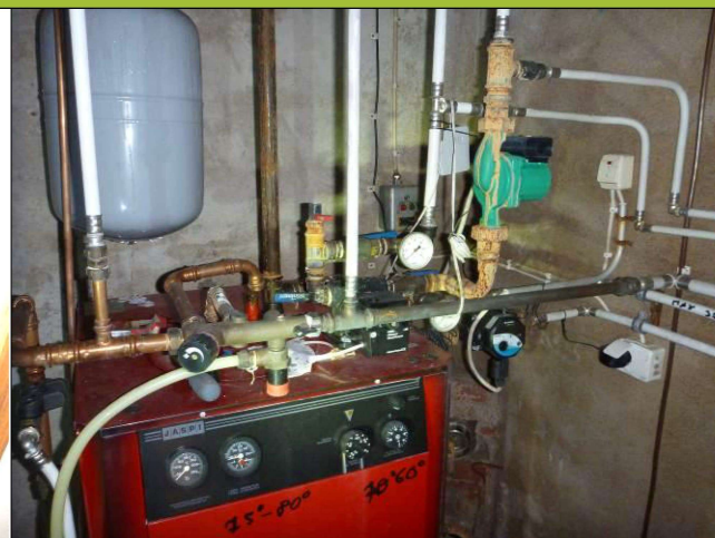
Kuva 42 Putkiliitoksia ovat paikoin auki pannuhuoneessa
