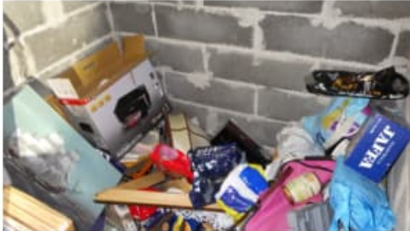
1. Runsas irtaimisto haittasi kellarin tarkastusta ja kosteusmittauksia
