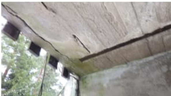
9. Takasivulla oleva betonilaatta huonokuntoinen
