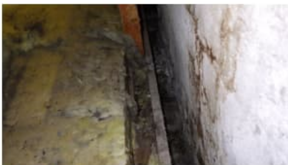
23. Palovilla puuttuu piipun kohdalta
