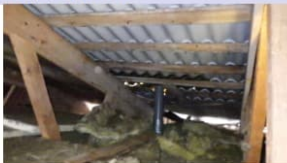
20. Aluskate puuttuu yhdestä ristikkovälisestä
