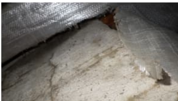
21. Aluskatteen läpiviennit puutteellisia
