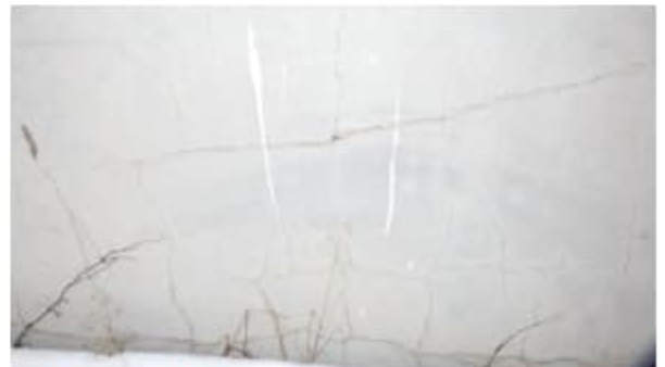
6. Halkeilua sokkelin pinnoitteessa
