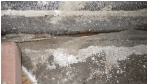
3. Kosteutta kellarin rakenteissa
