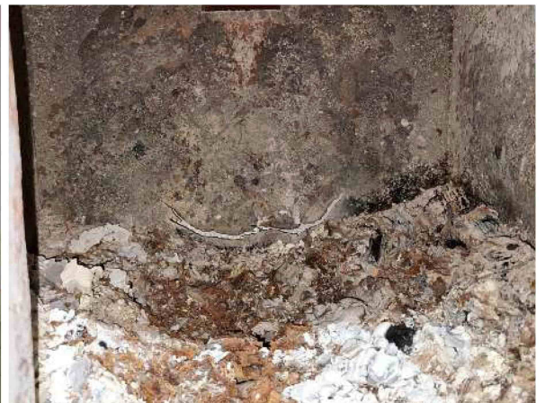
50. Kiukaan tulipesän halkeama
