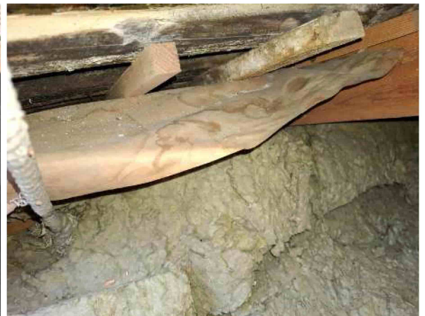
24. Tuuletusrako ja kosteusjäljet
