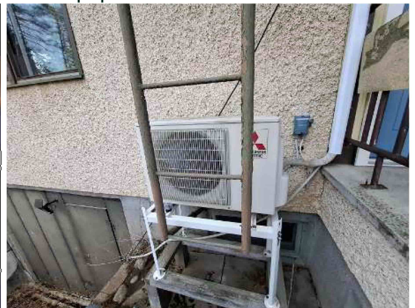
60. Rakennuksessa on kaksi ilmalämpöpumppua
