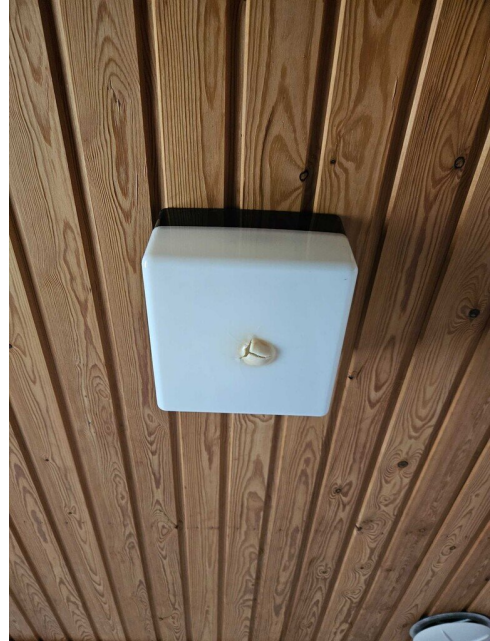
Kuva 58 Talosaunatiloissa valaisimen kupu sulanut
