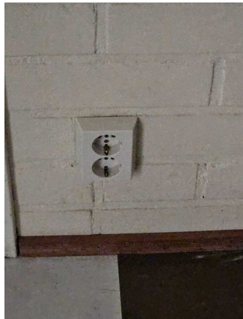
Kuva 60 Maadoitetut pistorasiat asunnoissa ja piharakennuksessa.
