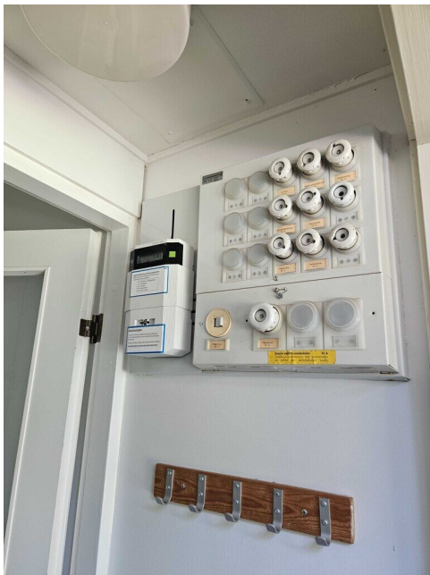
Kuva 59 Kuva asunnon 3 sähkökeskuksesta.
