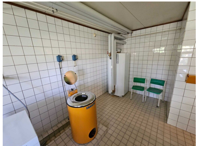
Kuva 41 Pesula, lämminvesivaraajan tyyppikilvessä vuosiluku 2012
