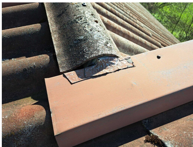
Kuva 26 Harjatiilen ja reunapellin välisissä lyijypelleissä reikiä
