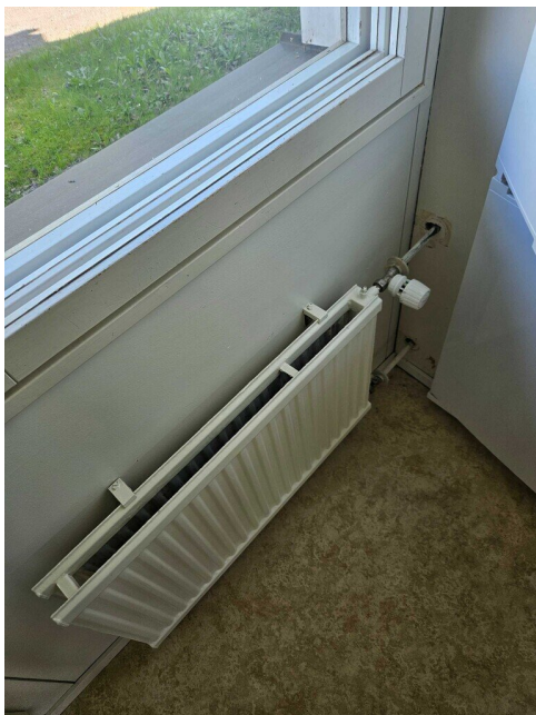
Kuva 49 Vesikiertoiset patterit, termostaatteja uusittu puppujen asennuksen yhteydessä?
