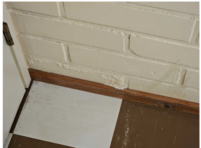
Kuva 37 WC tilan edessä havaittu kalkkihärmää tiileissä, seinän takana lämmönjakohuone, jossa ei havaittu vuotoa. Ilmeisesti vanha jälki.
