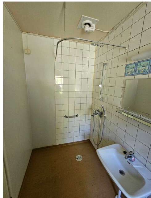
Kuva 51 Kuva asunnon 3. pesuhuoneesta. Poistoilmakanavassa pax puhallin
