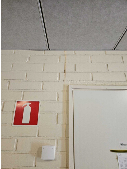
Kuva 38 Piharakennuksen aulatilassa vanha valumajälki seinässä. Alakatto levy ei irronnotu, jotta asian olisi voinut tarkistaa.
