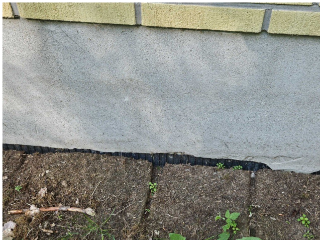
Kuva 16 Talon päädyssä havaittu perusmuurilevy
