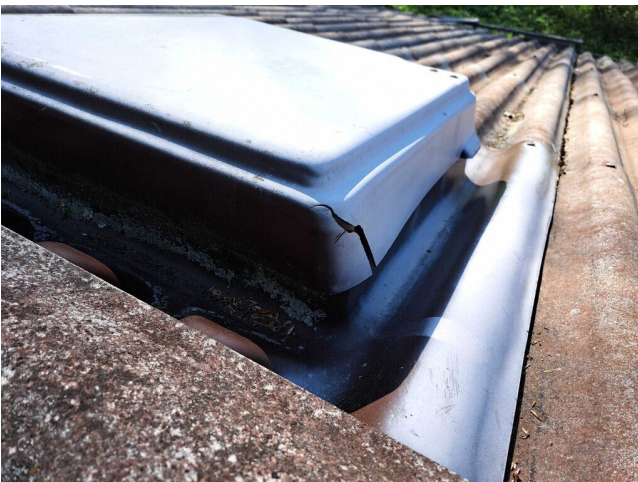
Kuva 29 Kattoluukussa halkeama, korjattu teipillä kierroksen yhteydessä
