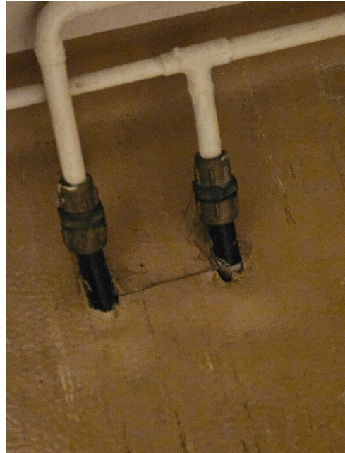
Kuva 53 Vesijohdot lattiassa muoviputkella ja näkyvät putket kuparilla.
