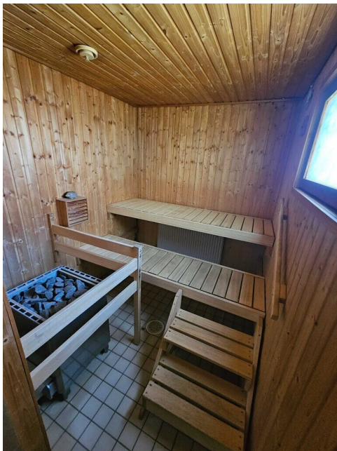
Kuva 36 Talosaunatilat vaativat saneerauksen. Lauteet ja penli suht. hyvässä kunnossa.
