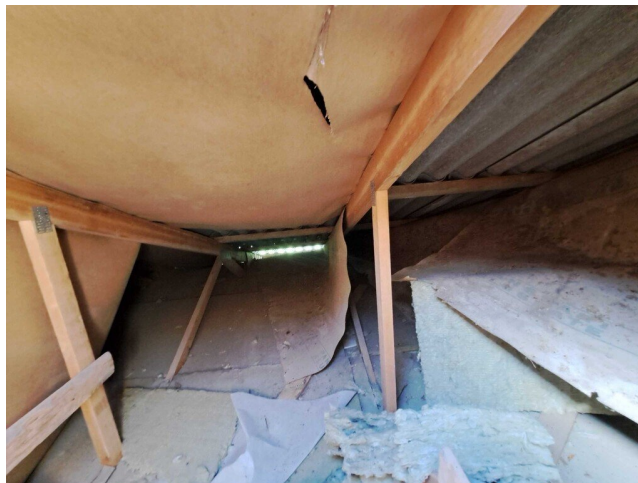
Kuva 32 Revenneitä ja pudonneita aluskatteita
