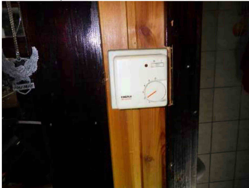
43. Pesuhuoneen/WC:n lattialämmityksen termostaattia
