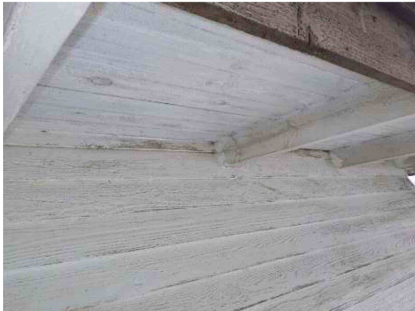
24. Ei tuuletusrakoa yläpohjaan
