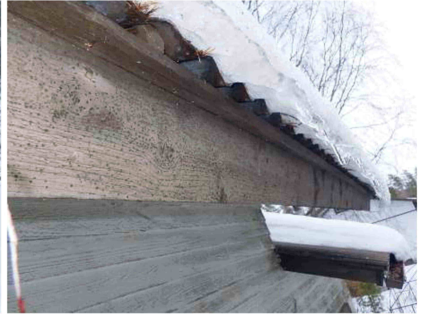
21. Ei sadevesikouruja pihan puolella.
