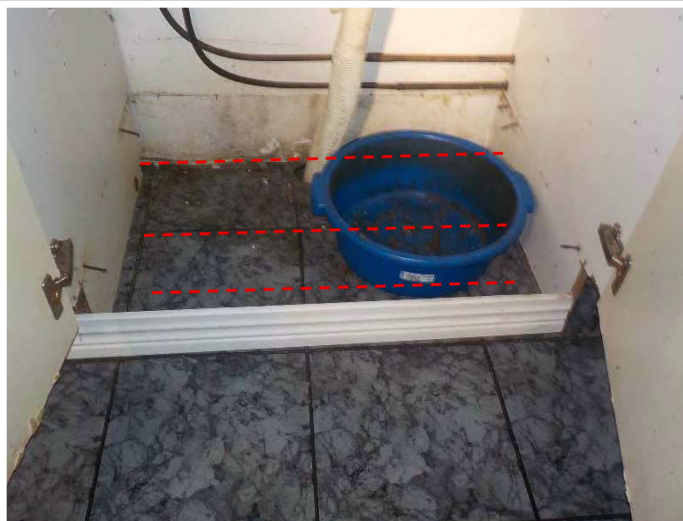
Tiskialtaan alapuolella lattialla havaittiin pintakosteudentunnistimella selvemmin kohonneita lukemia.
