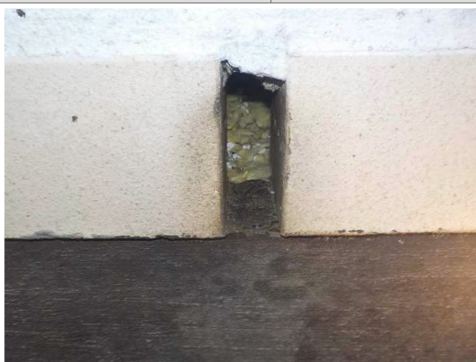
Tuuletussauvojen kohdalla ulkoseinien villaeristeissä oli havaittavissa hiirten/pieneläinten elämisen merkkejä.
