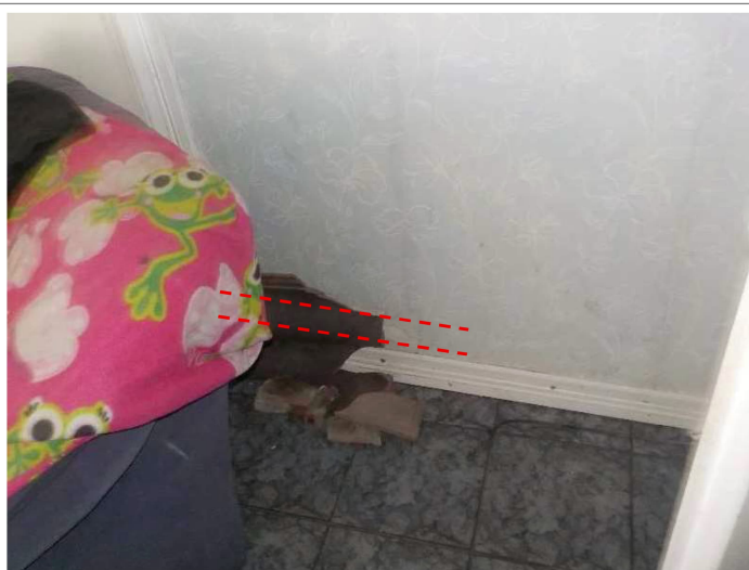
Takkahuoneen puolella pesuhuoneen vastaisen seinän alaosassa havaittiin hieman kohonneita lukemia ja merkkejä kosteusrasituksesta.
