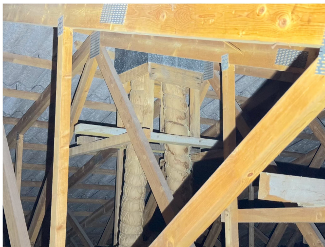
Kuva 7. Putkisto on eristetty asianmukaisesti
