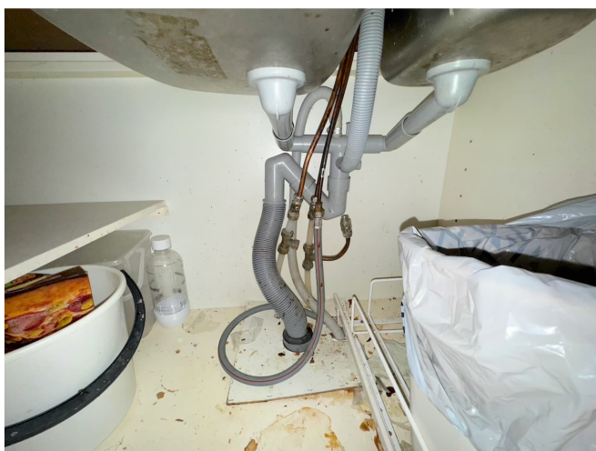
Kuva 12. Keittiön käyttövesiputkista puuttuvat kannakkeet
