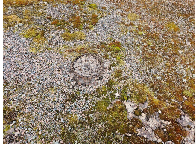
Kuva 69 Desinfiointikeskuksen vesikaton kaivot olivat tukossa (avattiin kierron yhteydessä).
