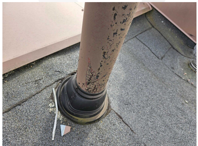
Kuva 63 Varasto: Tuuletusviemärin läpiviennistä puuttui kiristysrenkas.
