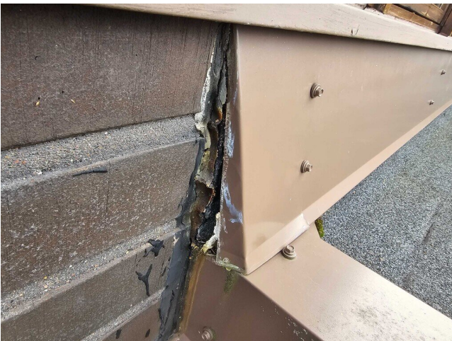
Kuva 66 Varasto: vesikaton pellitysten elastiset massaukset olivat ikääntyneet.
