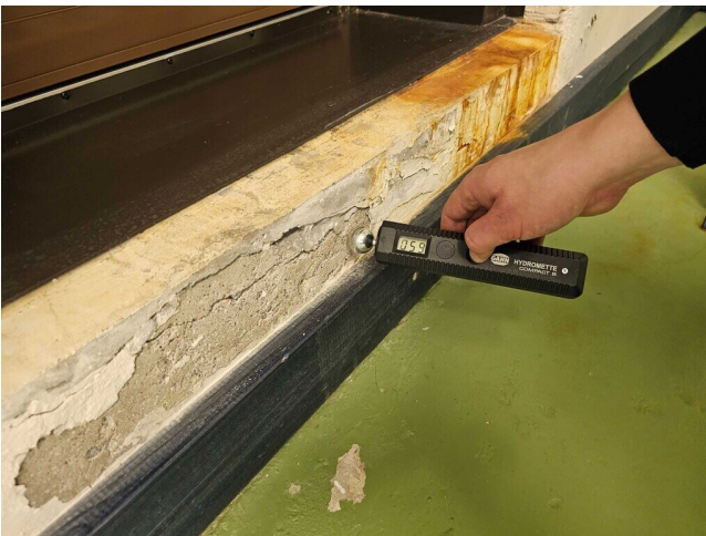
Kuva 59 Varasto: vanhoja vauriojälkiä hätäpoistumisteiden ovien alaosissa. Mittauksissa ei havaittu kohonneita pintakosteuksia.
