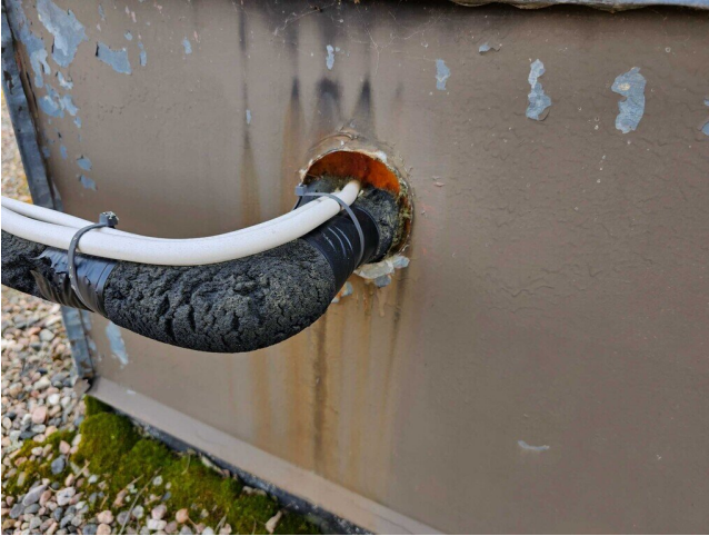
Kuva 72 Epätiivittä läpivientejä desinfiointikeskuksen katolla.
