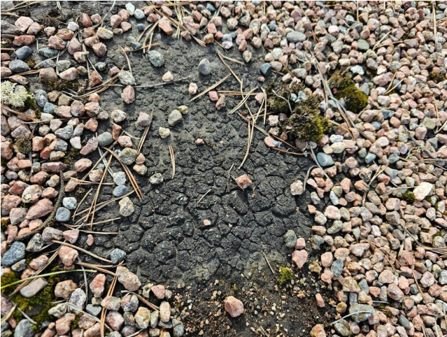
Kuva 76 Autokatoksen bitumikermiä olivat ikääntyneet ja halkeilivat.
