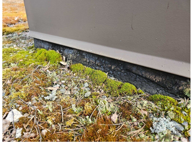
Kuva 73 Desinfiointikeskuksen bitumikermi halkeilivat.
