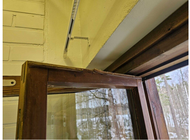
Kuva 46 Ikkunoiden tiivisteet ovat ikääntyneet.
