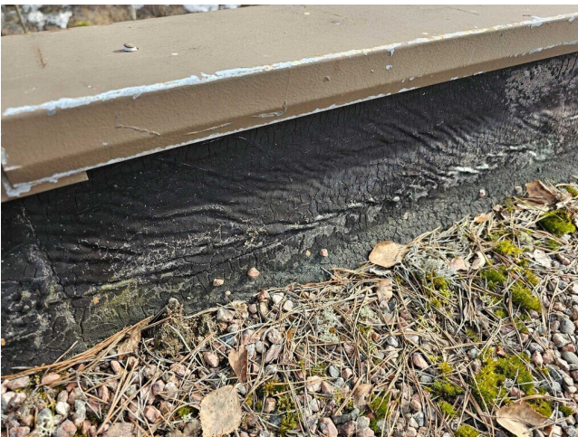
Kuva 74 Autokatoksen bitumikermi olivat ikääntyneet ja halkeilivat.
