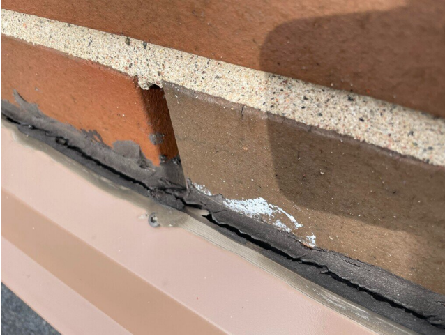
Kuva 68 Varastorakennuksen vesikaton pellitysten elastiset massaukset olivat ikääntyneet.
