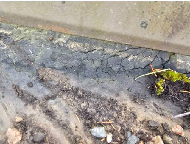
Kuva 70 Desinfiointikeskuksen bitumikermi halkeilivat.
