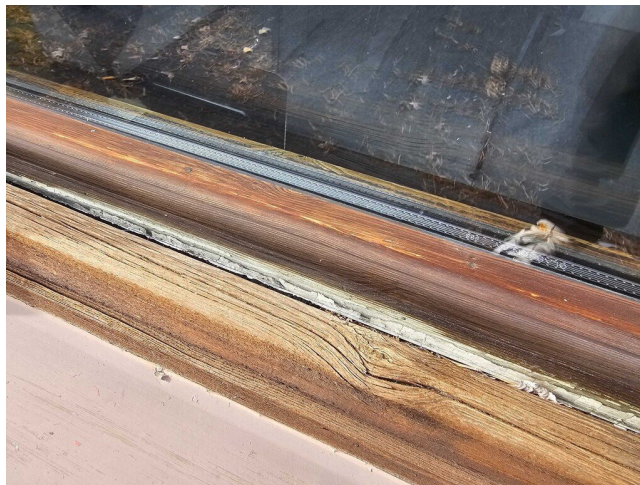
Kuva 50 Ikkunoiden puuosat ovat ikääntyneet.
