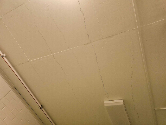
Kuva 23 Varasto: 1. krs varaston käytävän katon halkeamat.
