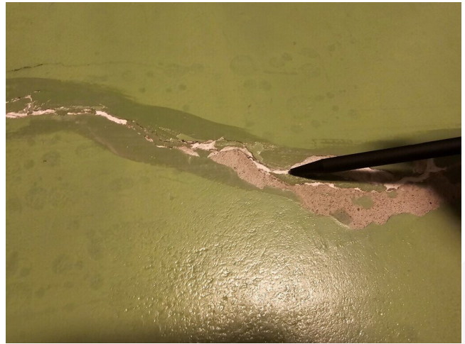
Kuva 22 Varasto: 2. krs alapohjan halkeama.
