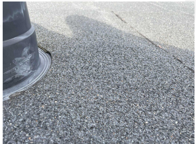
Kuva 67 Varastorakennuksen alipainetuulettimien ympärillä kermissä oli paikoin rakoja.
