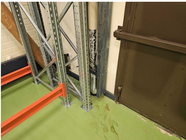
Kuva 115 Varastorakennuksen vesikaton sadevesiviemäriin on ollut joskus vuotoja.
