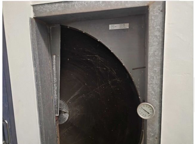
Kuva 106 Alkuperäinen TK31 lämmöntalteenottokiekko.
