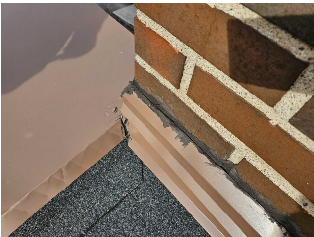
Kuva 62 Varasto: ylösnostopeltien tiivistysmassaukset ovat ikääntyneet ja repeilleet.
