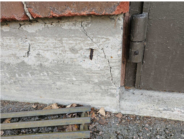
Kuva 13 Desinfiointikeskuksen sokkelin vaurioita.
