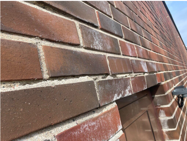
Kuva 41 Varasto: hätäuloskäynnin aukonylityspalkin vaurioita.
