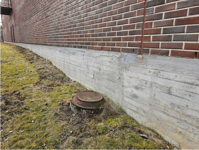
Kuva 11 Varastorakennuksen sokkelin vierusta.
