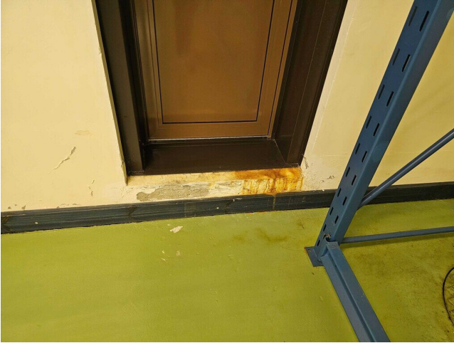
Kuva 17 Varasto: hätäpoistumisoven alapuolella maali oli hilseillyt alapohjasta.
