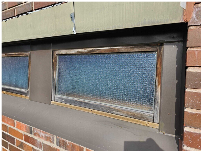
Kuva 49 Ikkunoiden puuosat ovat ikääntyneet.
