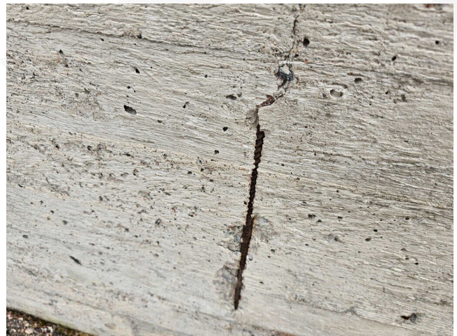
Kuva 14 Varastorakennuksen sokkelin vaurioita.
