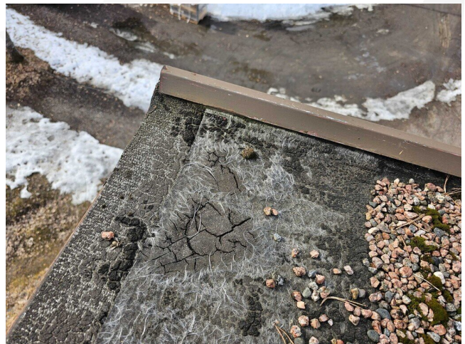
Kuva 75 Autokatoksen bitumikermi olivat ikääntyneet ja halkeilivat.
