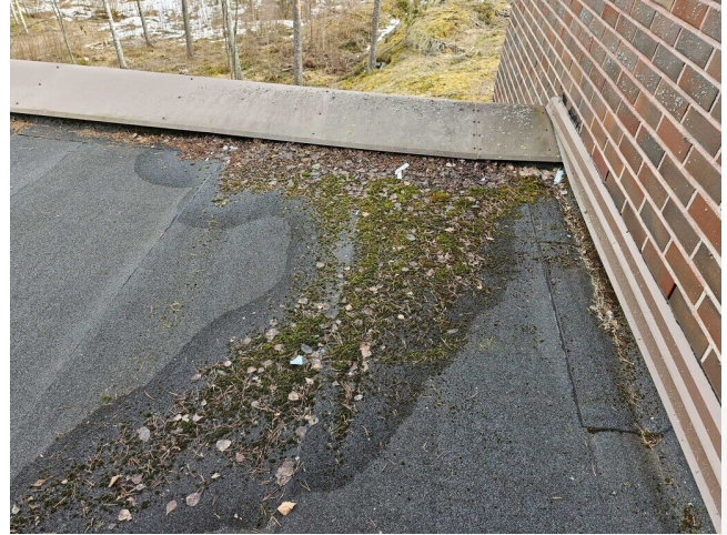
Kuva 65 Varasto: vesikatoilla kasvoi paikoin sammalta.
