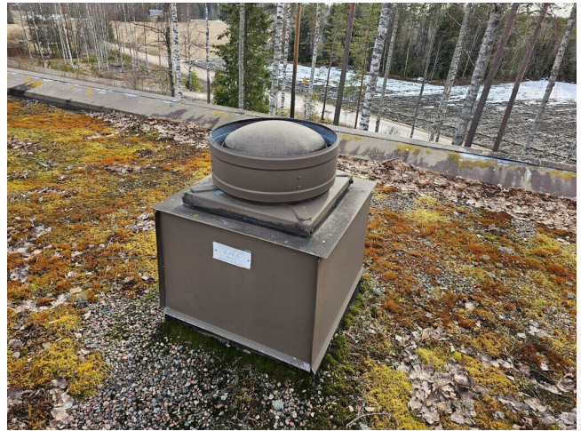
Kuva 108 Alkuperäinen huippuimuri desinfiointikeskuksessa.
