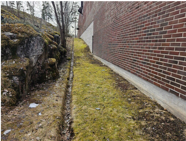
Kuva 9 Varastorakennuksen sokkelin vierusta.
