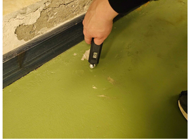
Kuva 18 Varasto: pintakosteudet eivät olleet kohollaan hätäpoistumistien edustalla (ovet uusittu 2017).
