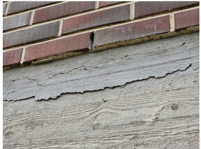
Kuva 10 Varastorakennuksen sokkelin vaurioita.
