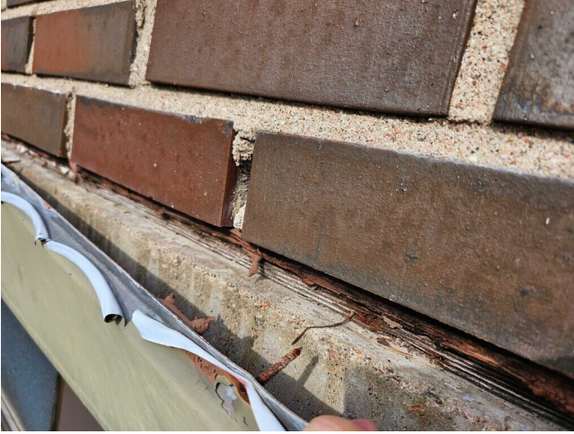
Kuva 39 Varasto: 3.kerroksen desinfiointikeskuksen puoleinen aukonylityspalkki.
