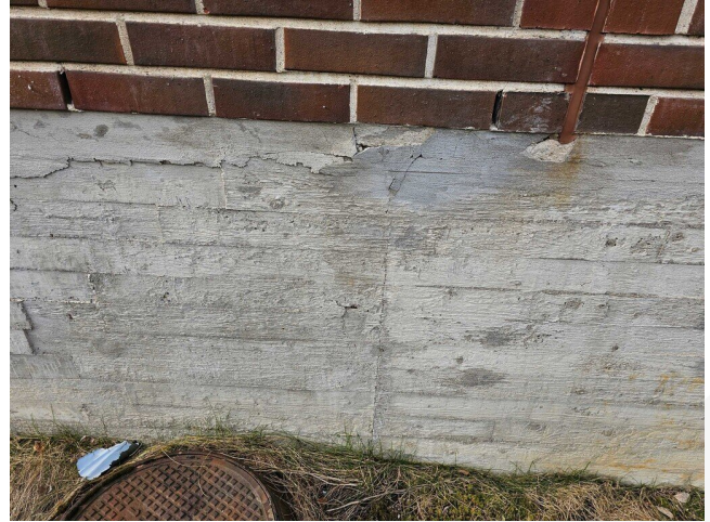
Kuva 12 Varastorakennuksen sokkelin vaurioita.
