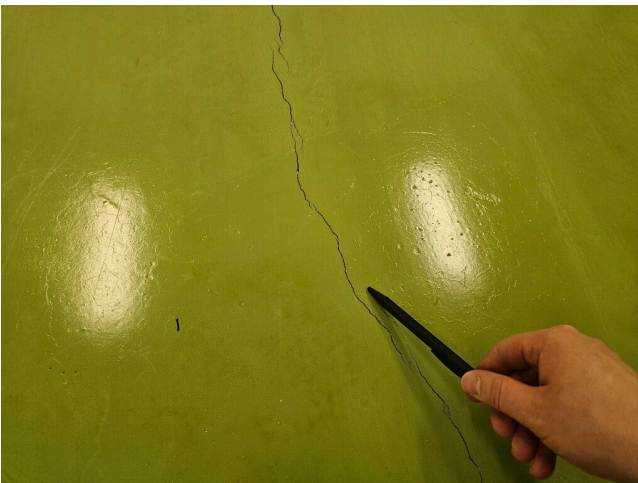
Kuva 25 Varasto: edellisiä kuvia vastaavalla kohdalla halkeamat 2.kerroksen lattiassa.
