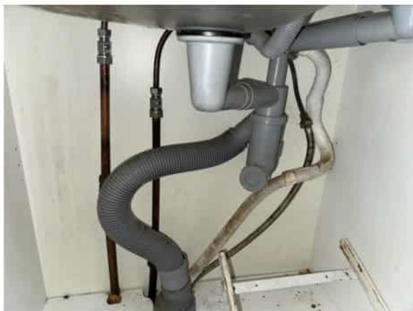
Käyttövesiputkisto on kupariputkistoa
