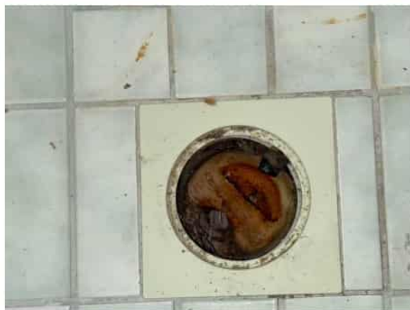
Lattiakaivoa on valurautainen
