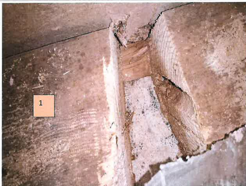
MP-1 Alaohjauspuusta leikattiin pala ja havaittiin vaurioita alapinnalla
