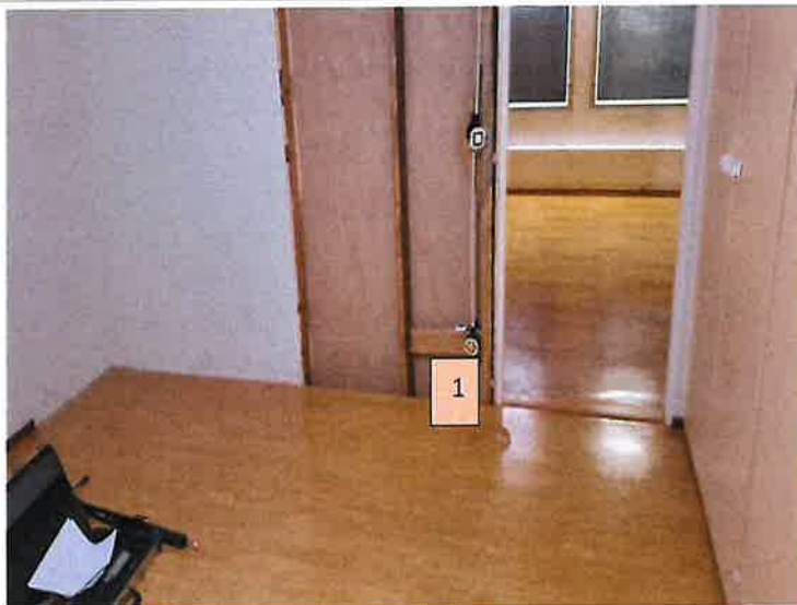
Alaohjauspuu olohuoneen ja makuuhuoneen välissä 21 paino%=lievästi kostea ja tummunut. Ummehtunut haju puussa
