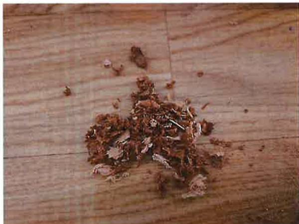
Kantavan väliseinän alajuoksun porauspurua, purussa todettavissa väri-ja hajumuutoksia
