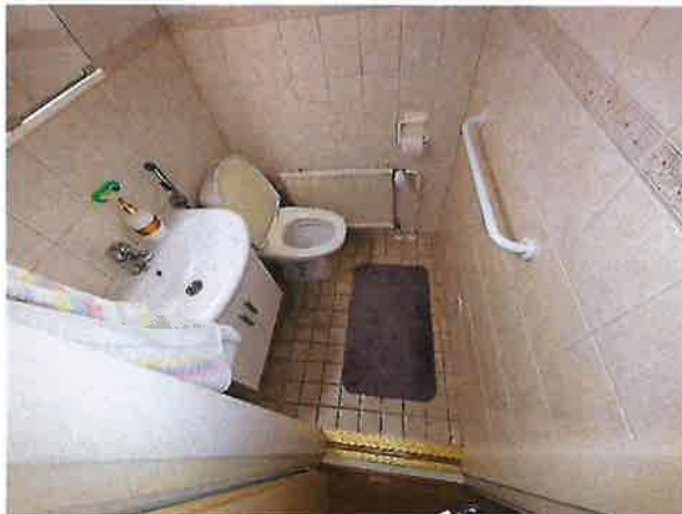
Wc-tila, normaali pintakosteus tarkastushetkellä
