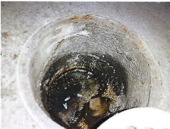
Korokerenkaalliset lattiakaivot puhdistettava, jonka jälkeen tiivistettävä korokerenkaiden liitoksien kohdalta.
