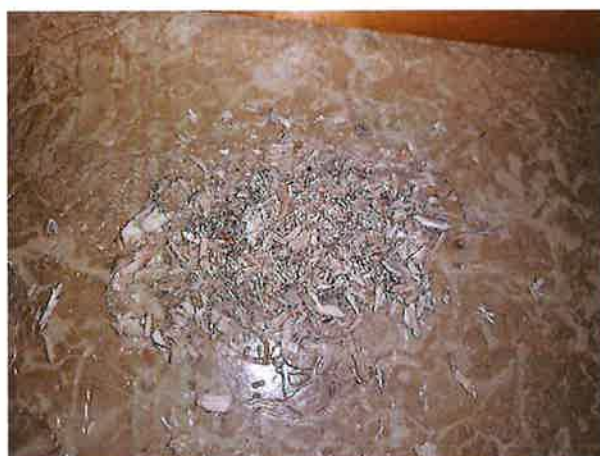
Ulkoseinien alajuoksujen ylösotetussa porauspurussa ei havaittu värimuutoksia
