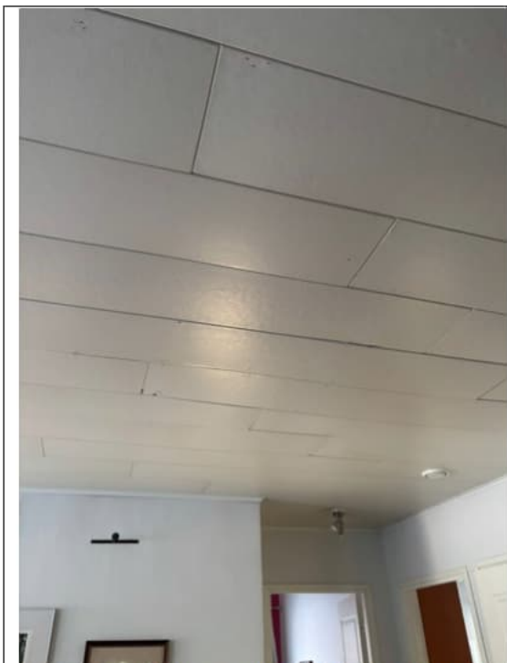
Kuva 45 MDF kattopaneelit roikkuivat paikoittain.
