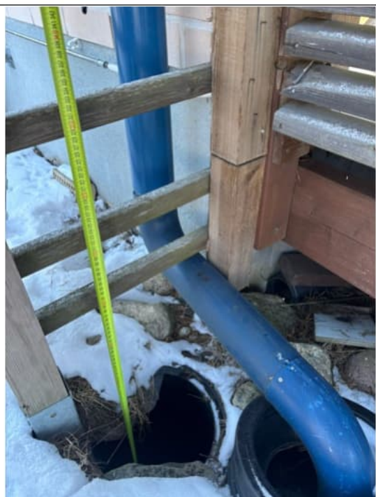
Kuva 6 Salaojat päästiin kuntotarkastuksessa mitaamaan yhdestä tarkastus kaivosta. Salaojat havaittiin olevan noin 440 mm kellarin lattian pintaa alempana.
