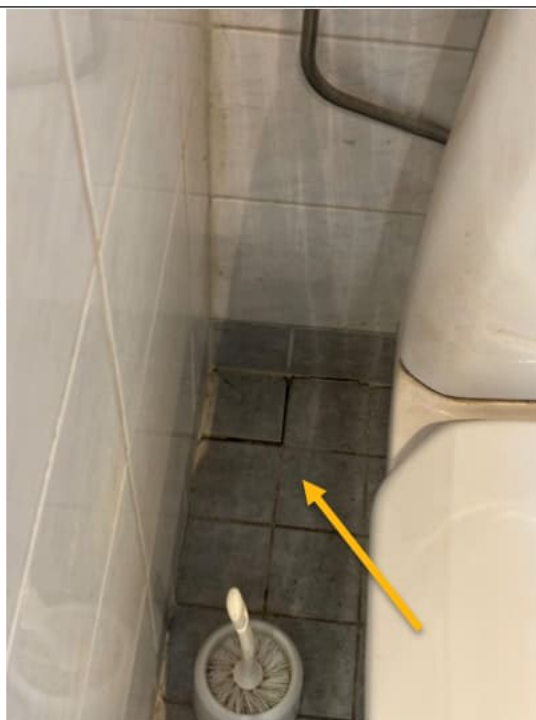
Kuva 54 Alakerran erillis wc:ssä havaittiin haljonneita ja osittain irroneita laattoja.
