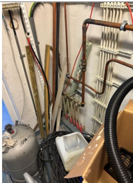
Kuva 74 Jakotukit sijaitsee teknisessä tilassa.
