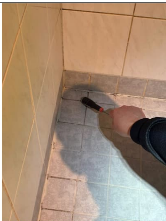
Kuva 34 Nurkassa havaittiin haljennut laatta.
