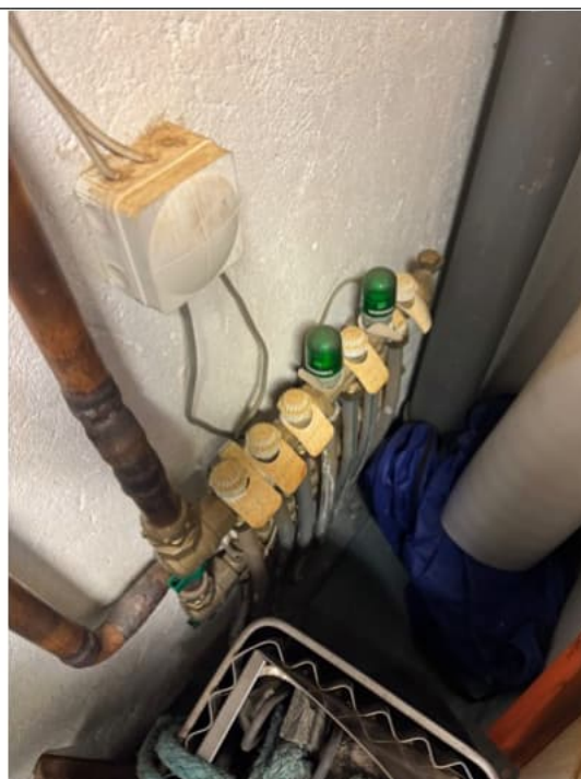
Kuva 71 Vesikiertoisen lattialämmityksen jakotukit sijaitsivat teknisessä tilassa. Jakotukien juurella ei havaittu vesieristysnostoja.
