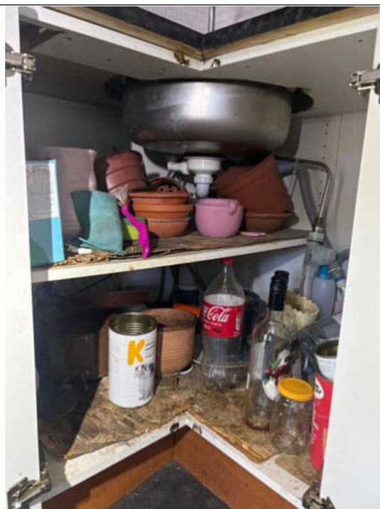
Kuva 40 Allaskaapin pohjan tiivistys valumakaukaloksi puuttui. Pesualtaan viemärointiä ei ole kannatettu ja kiinnitetty taustaseinään.
