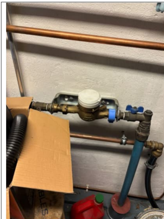
Kuva 73 Vesimittari sijaitsee teknisessä tilassa. Vesimittarin jälkeen ei havaittu vedenpaineentasausventtiiliä.
