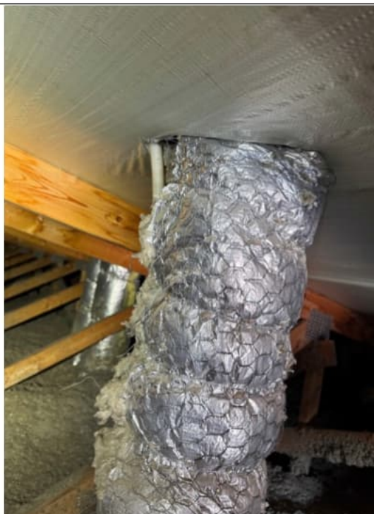
Kuva 10 Aluskatteen läpivienneissä havaittiin puuteita
