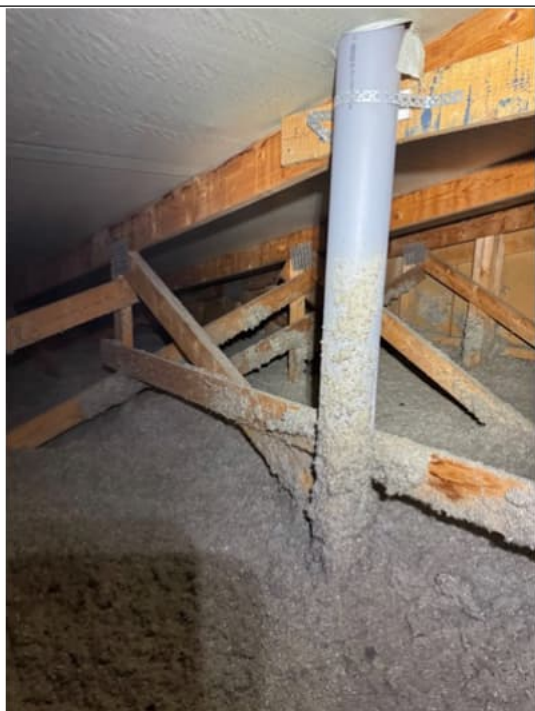
Kuva 13 Yläpohjassa kulkeva viemärin tuuletusputki oli eristämättä.
