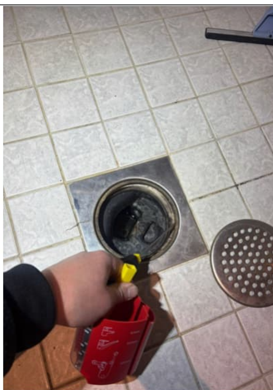
Kuva 48 Yläkerran pesuhuoneen lattiakaivo aukaistiin kuntotarkastuksessa. Kaivossa havaittiin kiristysrenkas, jolla vesieriste on painettu kaivoon.
