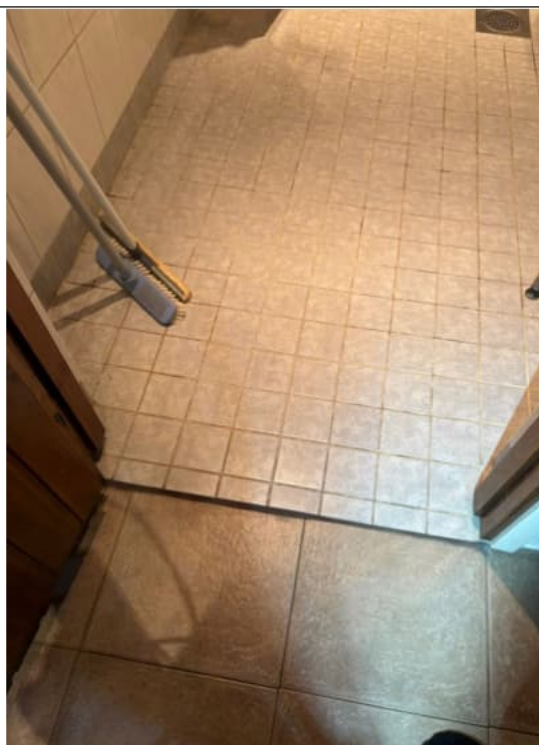
Kuva 32 Pesuhuoneesta kuivantilanpuolelle ei havaittu tulvakynnystä.
