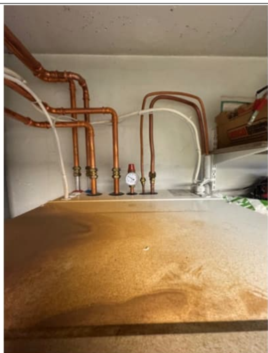
Kuva 67 Vesi-ilmalämpöpumpun mittari näytti lämmönjaon paineeksi 1 bar.
