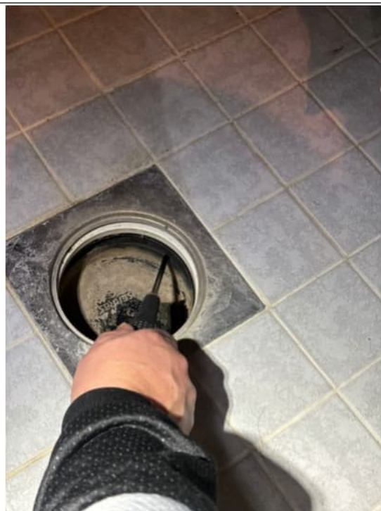
Kuva 29 Saunan kaivosta puuttui korokerengas, jolla korokerengas saadaan painettua vesitiiviisti kaivoon.
