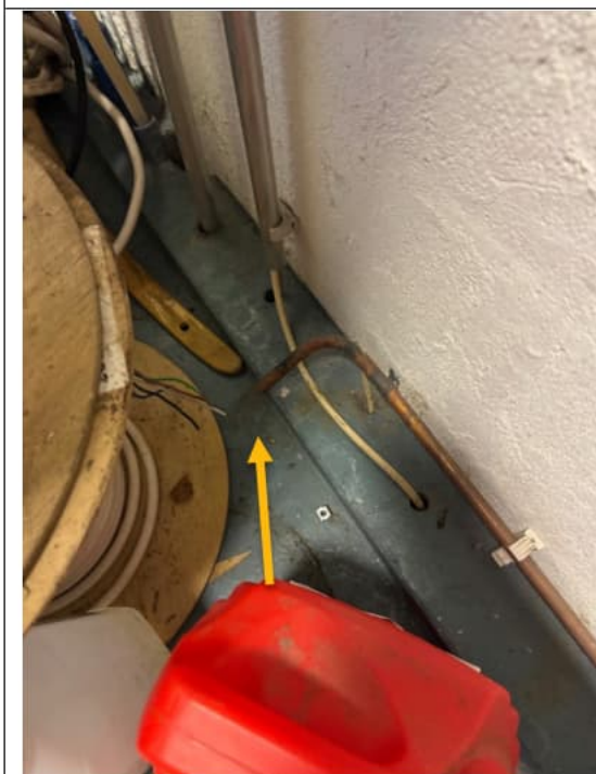
Kuva 70 Vesikiertoisen lämmönjaon varoventtiili oli viemäroimättä.
