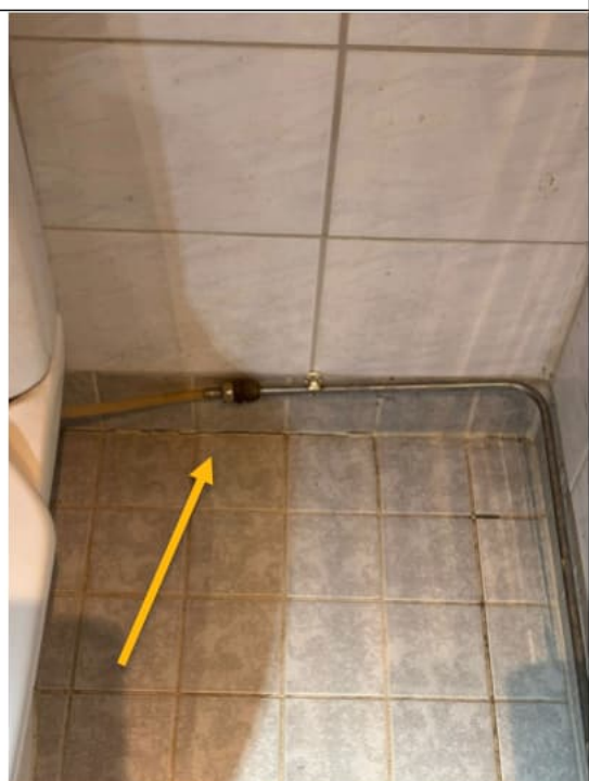
Kuva 55 Alakerran wc:n lattian sauma oli auki. Lattia on painunut tai rakenteet eläneet
