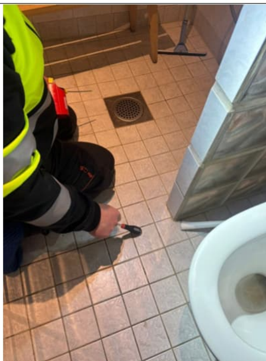
Kuva 50 Kopolaatta havainto yläkerran pesuhuoneessa.
