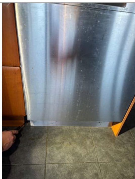
Kuva 42 Astianpesukoneen alla havaittiin valumakaukalo.
