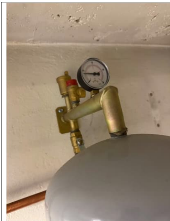
Kuva 68 Kalvopaisuntasäiliön mittari näytti lämmönjaon paineeksi 0,8 bar.
