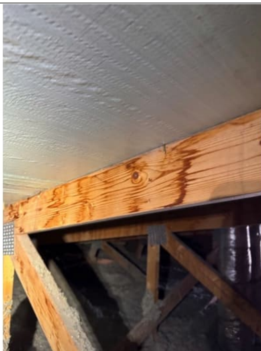
Kuva 14 Kattotuolin yläpaarteessa kosteusjälkiä
