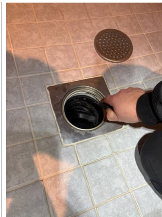
Kuva 31 Pesuhuoneen suihkun puoleisesta kaivosta puuttui korokerenkaan tukirengas, jolla korokerengas saadaan painettua vesitiiviisti kaivoon.
