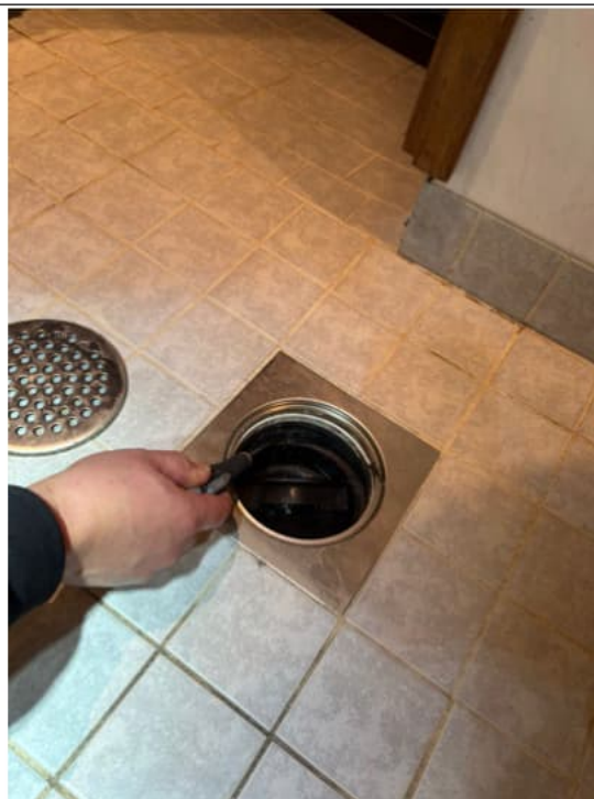
Kuva 30 Pesuhuoneen kaivosta puuttui korokerengas, jolla korokerengas saadaan painettua vesitiiviisti kaivoon.
