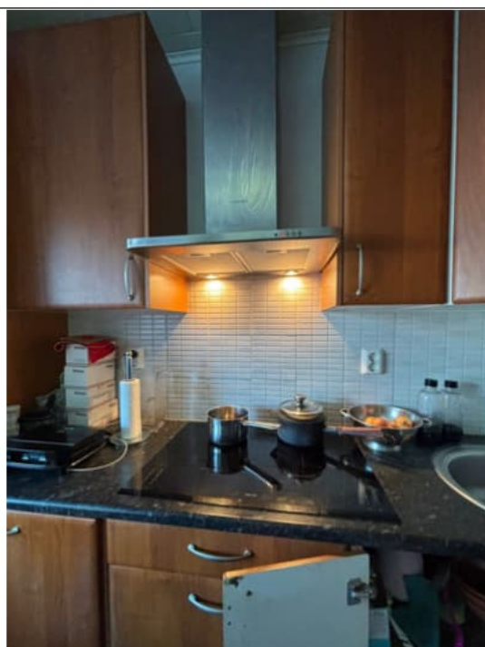
Kuva 44 Liesituuletin puhalttaa huippumurilla ka- tolle.
