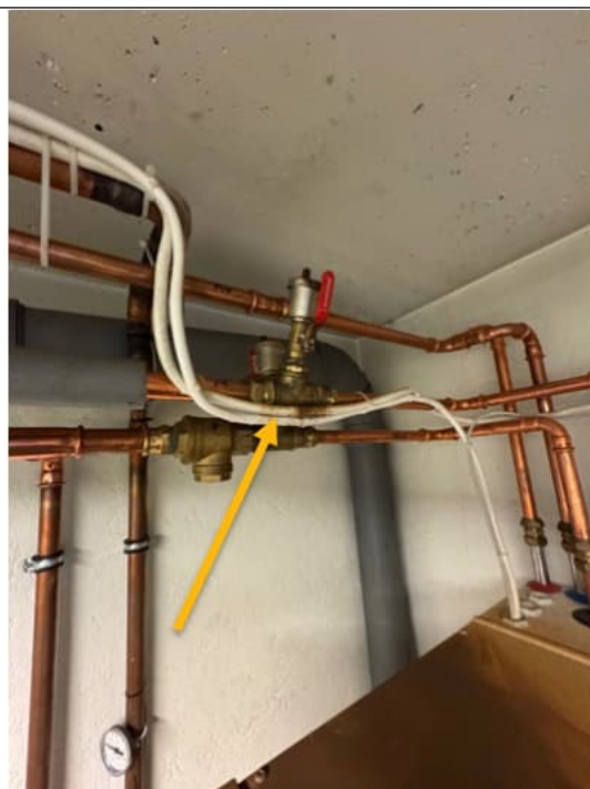
Kuva 69 Tarkastuksessa havaittiin järjestelmässä vuotava ilmakello.
