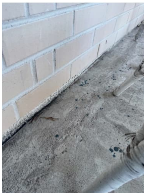
Kuva 24 Parvekkeella ei havaittu vesieristystä eikä vesieristysnostoa
