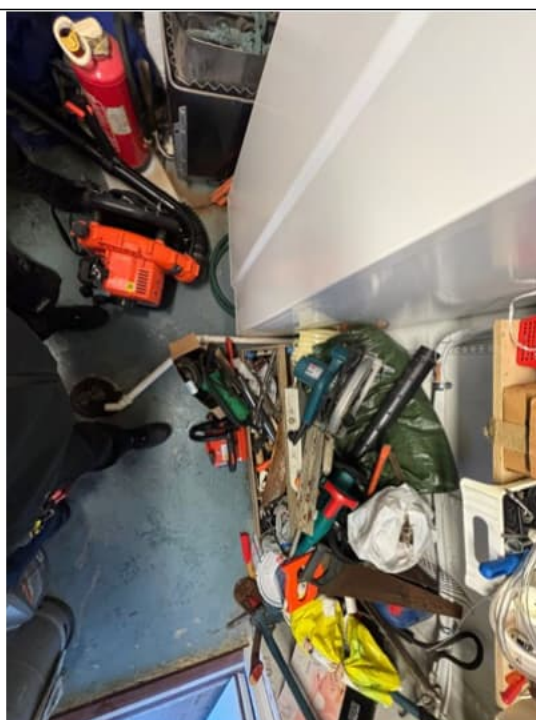
Kuva 56 Teknisen tilan lattiassa ei ole vesieristettä.
