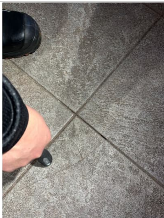
Kuva 63 Eteisessä havaittiin haljennut laatta.
