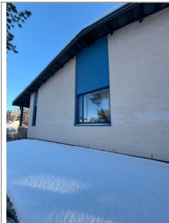
Kuva 17 Julkisivuna havaittiin tiiliverhous. Tuuletuksen tehostamiseksi havaittiin alimmassa tiilirivissä olevan joka kolmas pystysauma auki.
