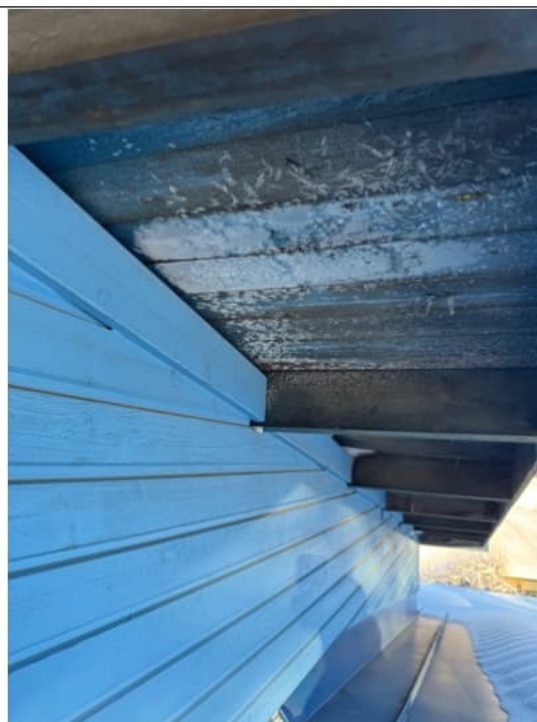
Kuva 16 Yläpohjan lämmin kostea ilma huurtuu räystääille. Tuuletuksen tehostamista suositellaan
