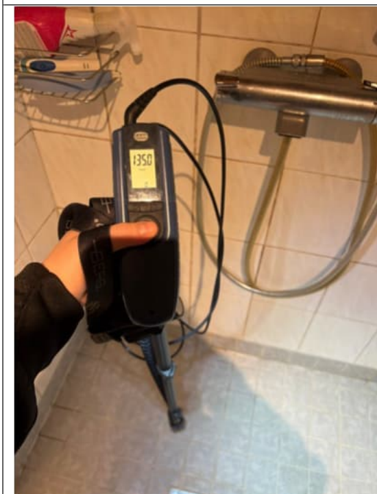
Kuva 37 Pintakosteudenvertailumittauksessa havaittiin märkiä lukemia roiskevesialueella.
