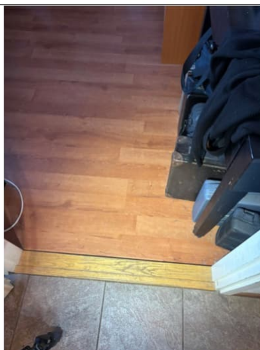
Kuva 80 Työhuoneen oven alta puuttui siirtoilmareitti.
