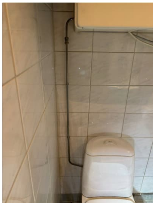
Kuva 78 Ilmanvaihtokoneen kondenssivesi on viemäroity.
