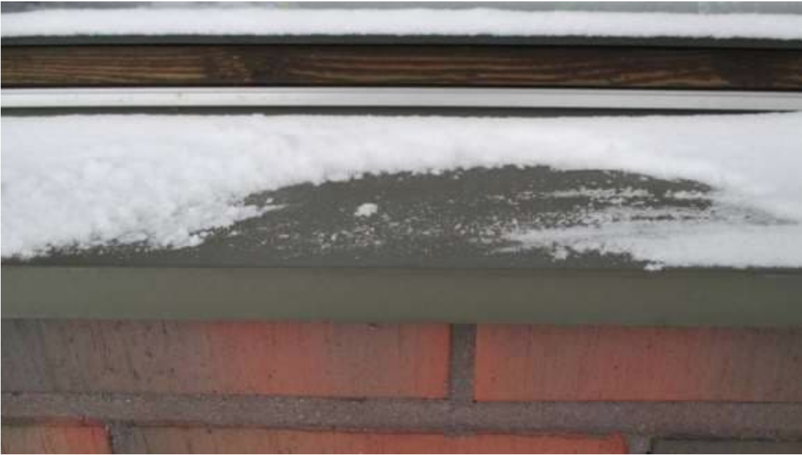
Liite 12. Kuvassa on kiinteistön ikkunapellitystä jonka kaato pitäisi olla suurempi poispäin kiinteistöstä ettei lumi ja vesi jää pellityksen päälle.
