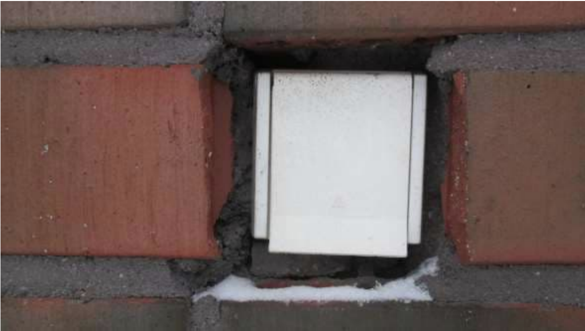
Liite 9. Kuvassa on kiinteistön tiiliverhoilun sähköpistorasia jonka ympärys pitää saumata uudestaan.
