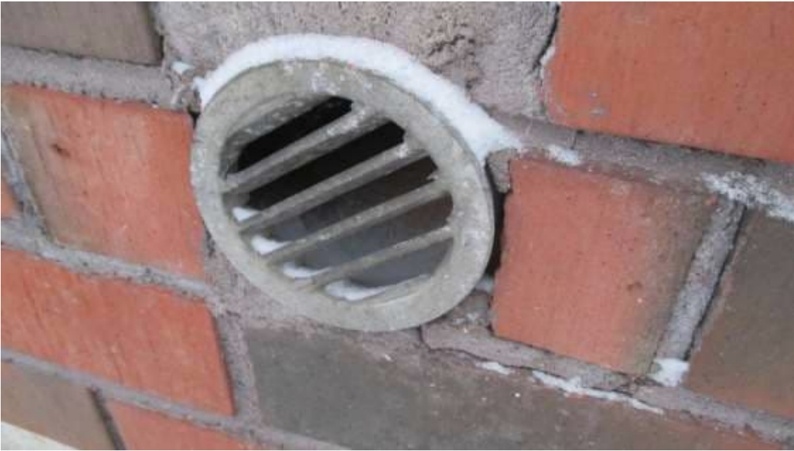
Liite 8. Kuvassa on kiinteistön tiiliverhoilun läpivienti joka pitää saumata uudestaan.
