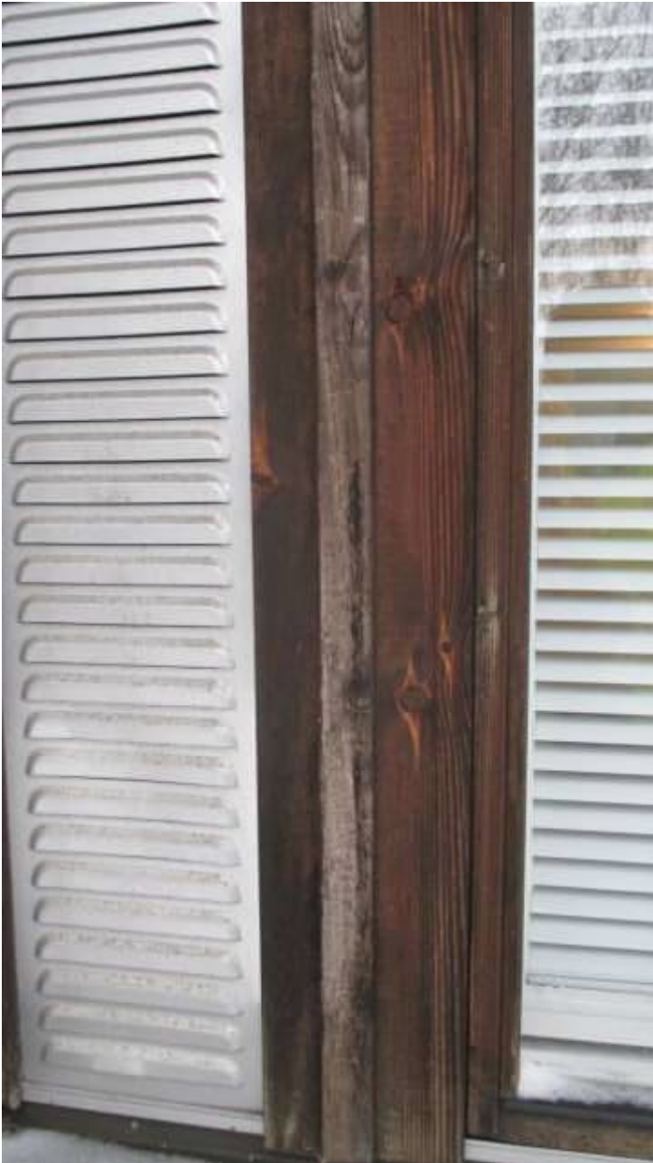
Liite 13. Kuvassa on kiinteistön ikkunaa ulkopuolelta. Ikkunat olivat huoltomaalauksen tarpeessa ulkopuolelta.
