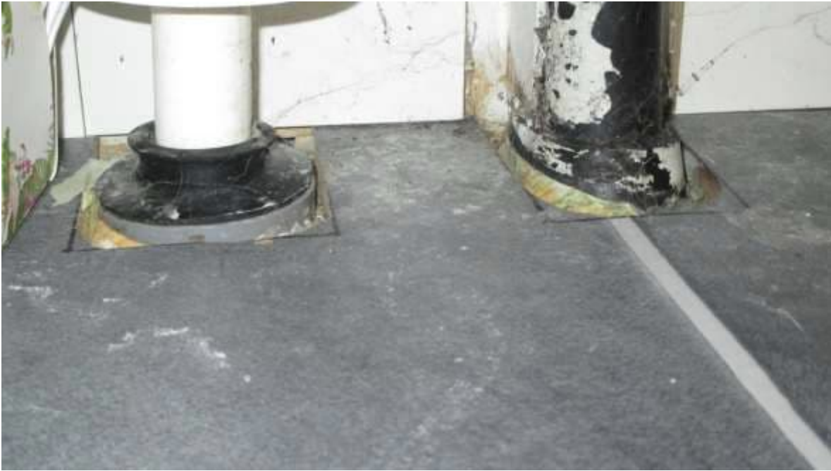
Liite 29. Kuvassa on kiinteistön wc:n viemäreiden lattian läpivientejä joita ei ole tiivistetty ja ne pitää tiivistää saniteettisilikonilla.
