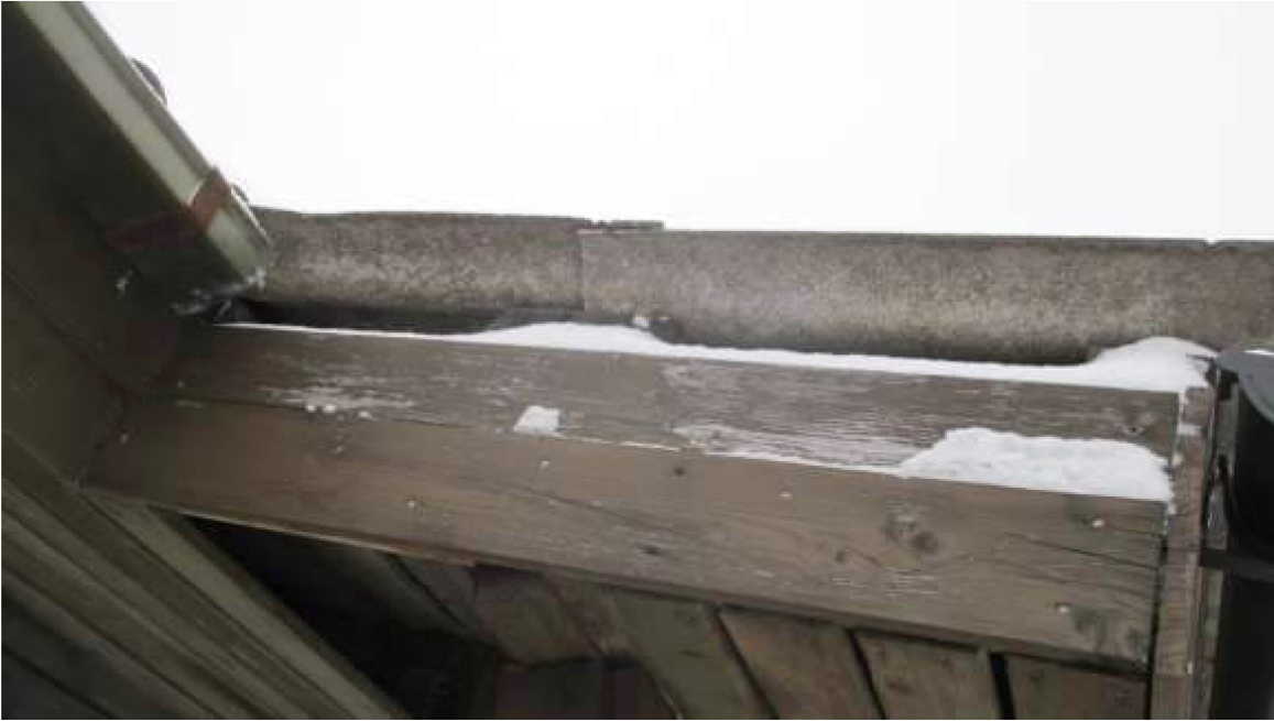
Liite 20. Kuvassa on kiinteistön sisäänkäynnin katon sivu josta puuttuu laudoitus ja se pitää korjata.
