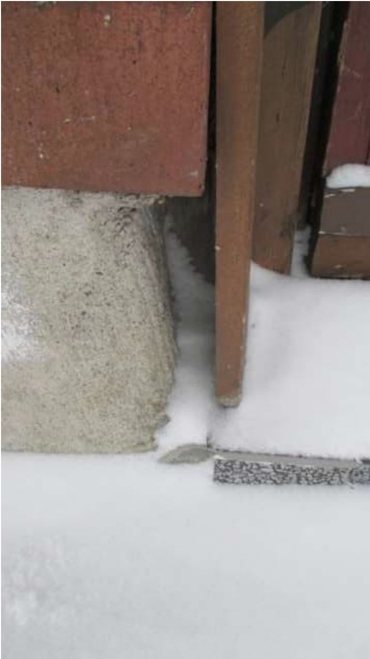
Liite 14. Kuvassa on kiinteistön oven perustuksen ja puulaudoituksen väli jossa on aukkoa ja se pitäisi tiivistää ettei lumi ja vesi jää rakenteisiin.
