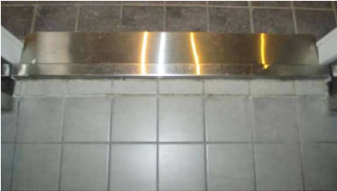
Liite 32. Kuvassa on kiinteistön suihkun lattia ja laattojen välistä puuttuu saumaus tai silikonin ennen oviaukkoa.
