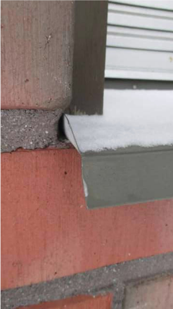
Liite 11. Kuvassa on kiinteistön ikkunapellitys jossa on sivussa rakoa joka pitää tiivistää ettei hienojakoinen lumi tai vesi pääse rakenteisiin.
