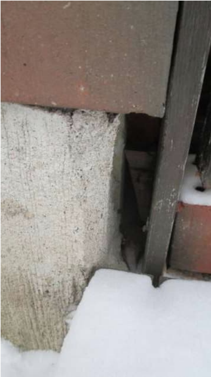
Liite 16. Kuvassa on kiinteistön oven perustuksen ja puulaudoituksen väli jossa on aukkoa ja se pitäisi tiivistää ettei lumi ja vesi jää rakenteisiin.
