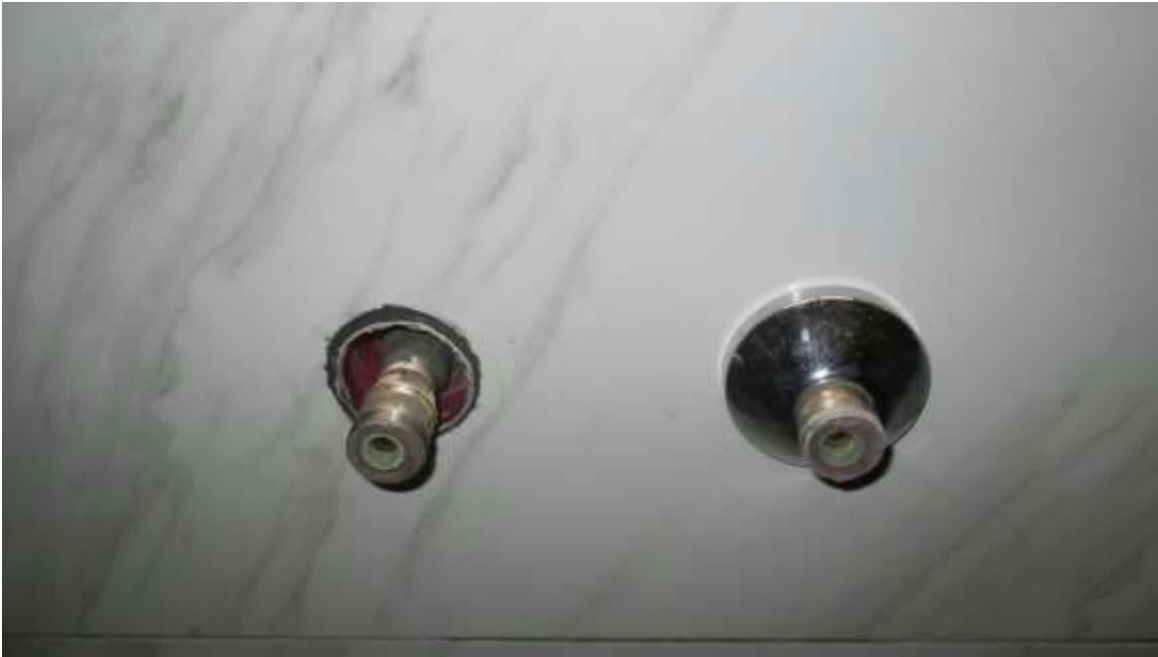
Liite 31. Kuvassa on kiinteistön suihkun vedensekoittajan liitännät. Vedensekoittaja oli jäätynyt mutta putkisto on seinän sisällä kunnossa.
