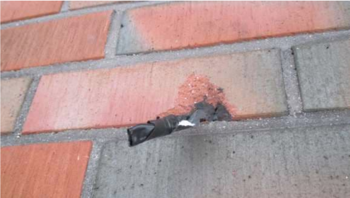
Liite 22. Kuvassa on kiinteistön vasemman sivustan avoin sähköjohto joka pitää poistaa tai koteloida.
