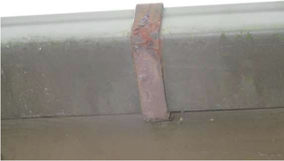
Liite 19. Kuvassa on kiinteistön katon räystäskourun kiinnike joka on ruostunut ja se pitää uusia tulevaisuudessa.
