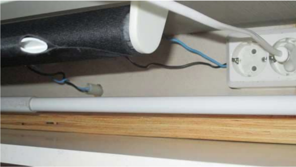
Liite 25. Kuvassa on kiinteistön olohuoneen katon sähkörasia johon tulee suojaamattomat sähköjohdot. Sähköjohdot pitää eristää.
