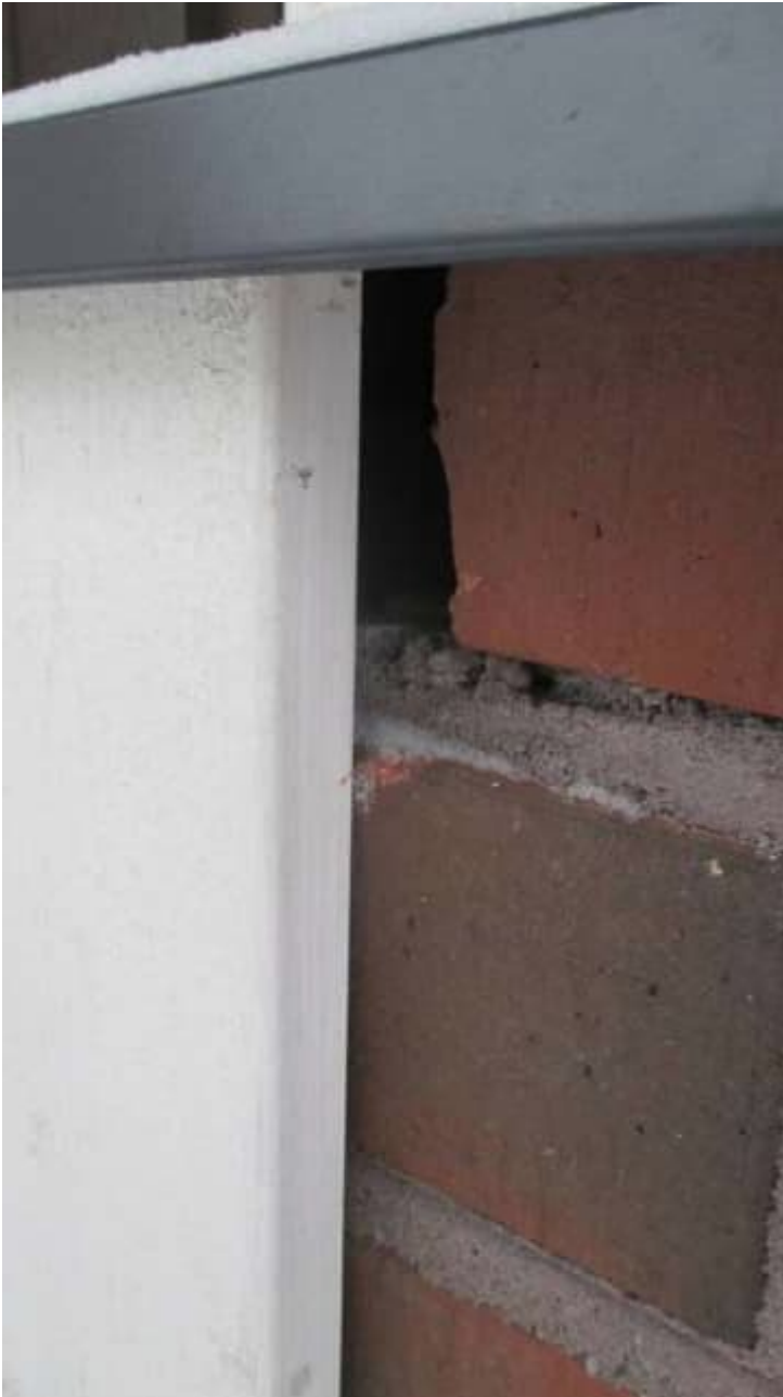
Liite 17. Kuvassa on kiinteistön ikkunapellityksen sivua jossa on aukko joka pitää tiivistää ettei lumi ja vesi jää rakenteisiin.
