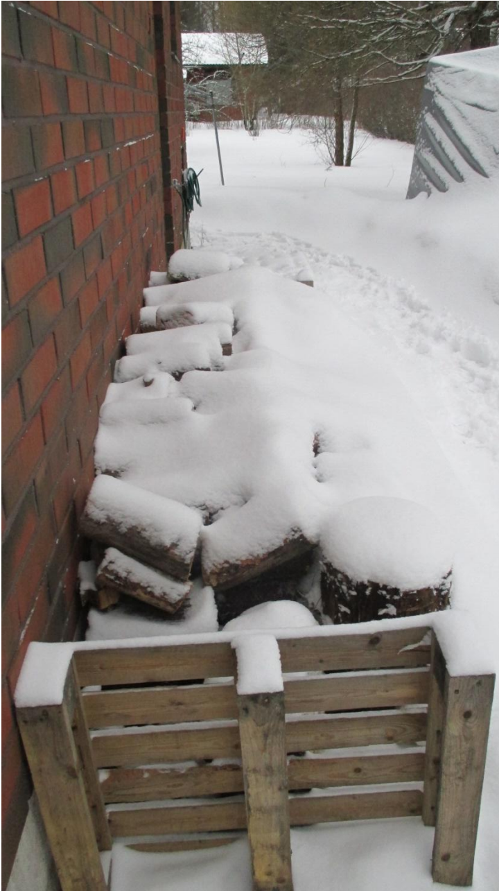
Liite 2. Kuvassa on kiinteistön sokkelia jossa on polttopuuta kiinni sokkelissa ja ne pitää siirtää pois kostuttamasta perustusta.
