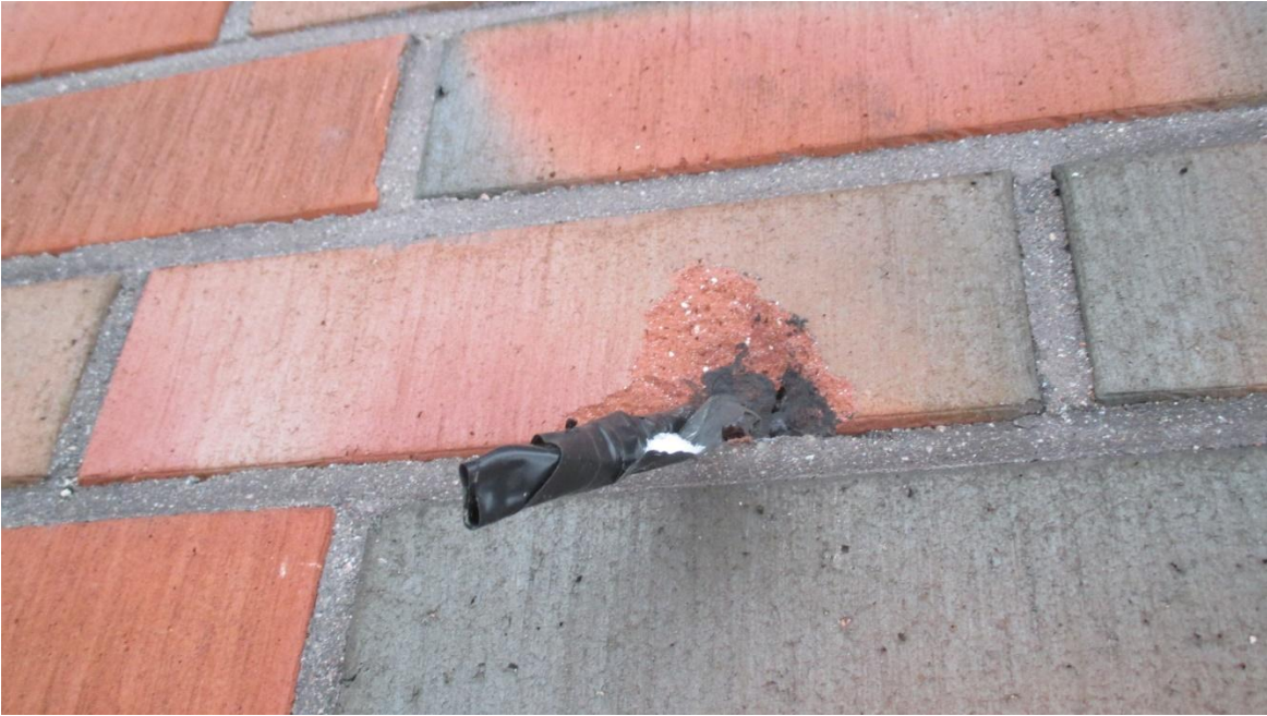
Liite 29. Kuvassa on kiinteistön vasemman sivustan avoin sähköjohto, joka pitää poistaa tai koteloida.
