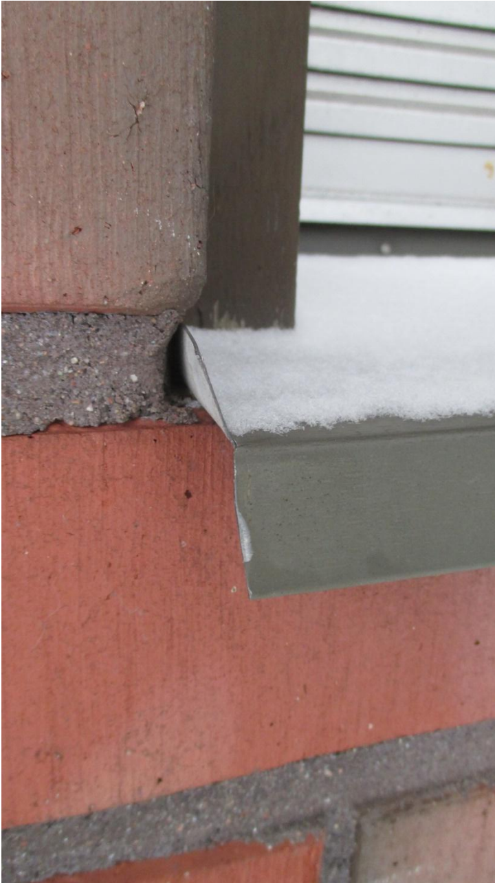
Liite 12. Kuvassa on kiinteistön ikkunapellitys, jossa on sivussa rakoa, joka pitää tiivistää, ettei hienojakoinen lumi tai vesi pääse rakenteisiin.
