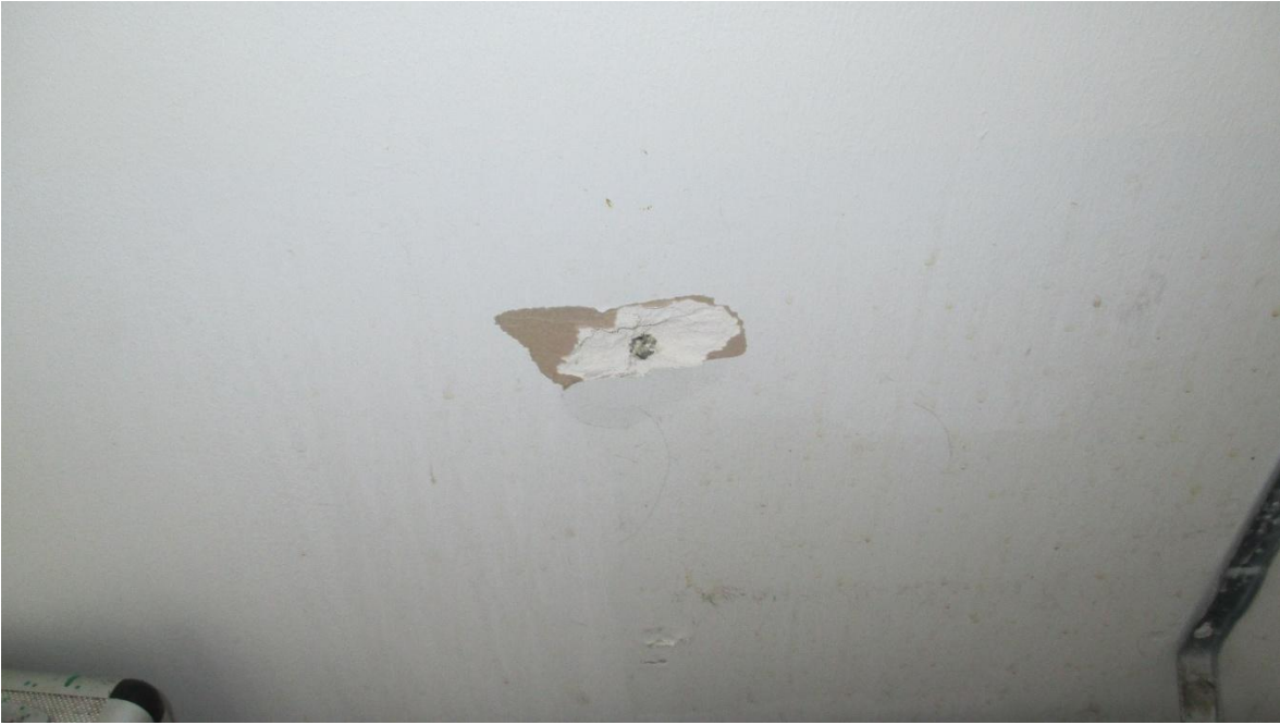
Liite 36. Kuvassa on kiinteistön makuuhuoneen seinä, jossa on reikä.
