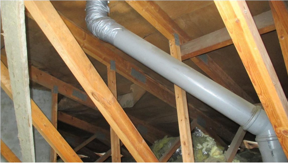
Liite 47. Kuvassa on kiinteistön yläpohjan putkistoa, joka ei ollut eristetty.
