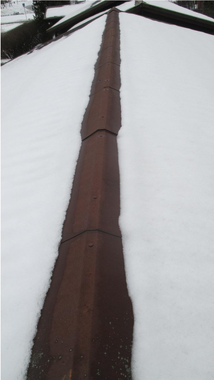
Liite 28. Kuvassa on kiinteistön katon harjapellitystä, joka oli ruostunut ja siinä oli aukkoja.
