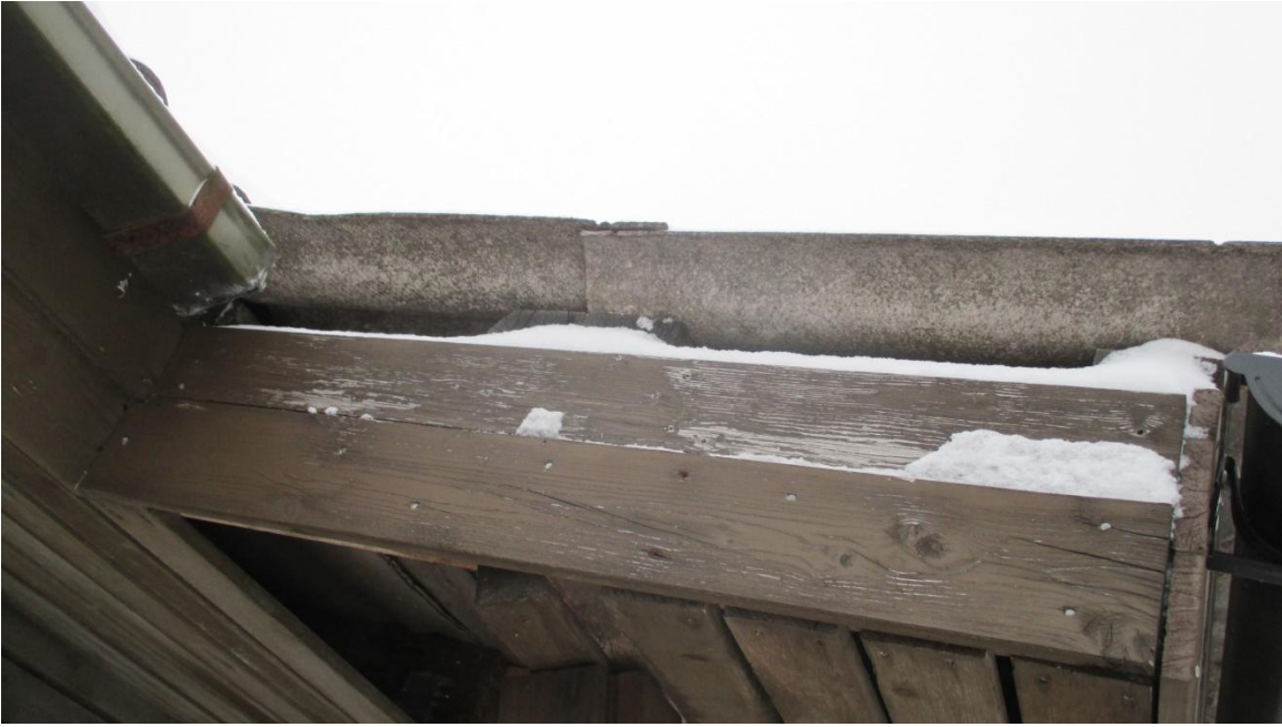
Liite 23. Kuvassa on kiinteistön sisäänkäynnin katon sivu, josta puuttuu laudoitus ja se pitää korjata.
