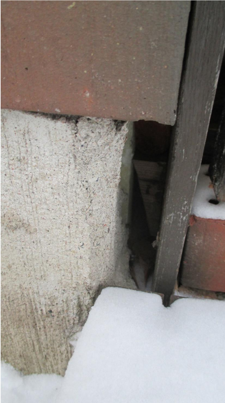
Liite 17. Kuvassa on kiinteistön oven perustuksen ja puulaudoituksen väli, jossa on aukkoa ja se pitäisi tiivistää, ettei lumi ja vesi jää rakenteisiin.
