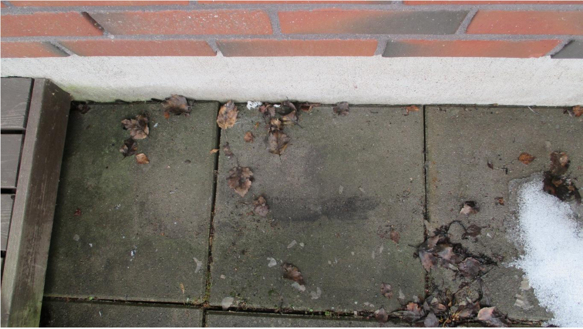
Liite 3. Kuvassa on kiinteistön ulkoseinän vierustaa, jossa on betonilaatoitus kiinni perustuksessa ja siitä pitää poistaa ensimmäinen rivi.
