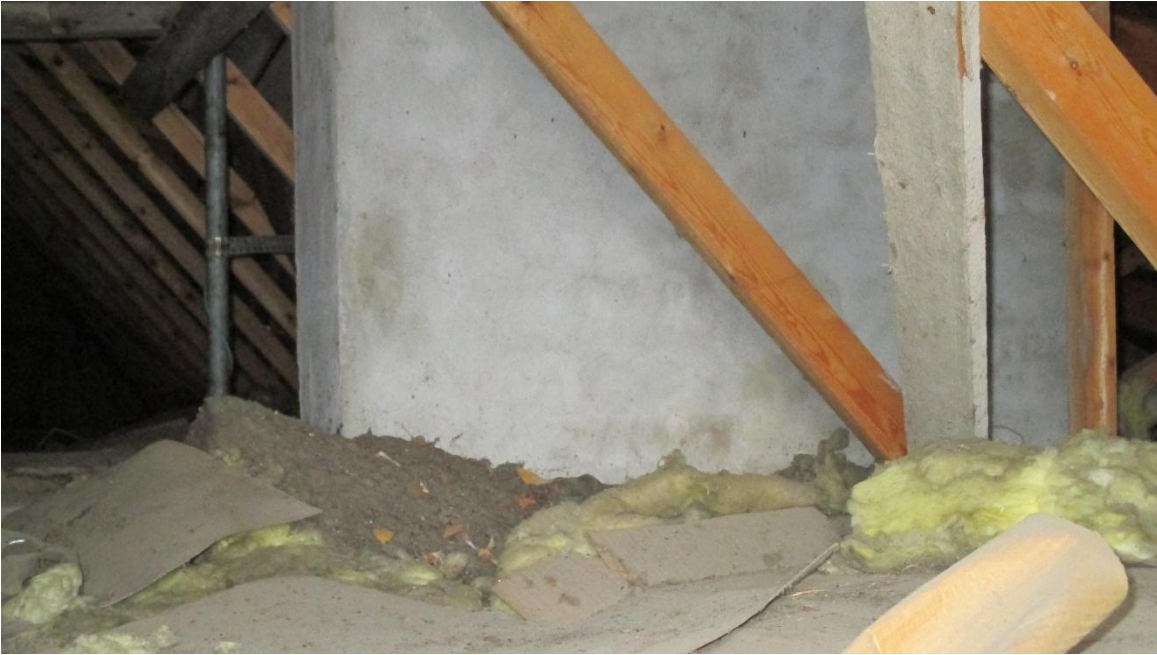
Liite 46. Kuvassa on kiinteistön yläpohjaa ja hormi, jonka palosuojavilloitusta kannattaa lisätä.
