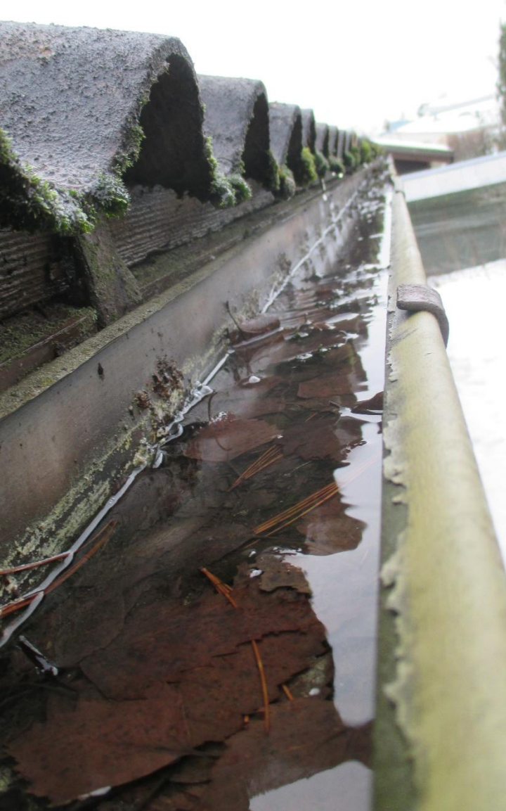
Liite 26. Kuvassa on kiinteistön katon vesiränniä, joka oli täynnä roskaa. Katon räystääslautoja ei oltu maalattu ja niissä oli lahoa.
