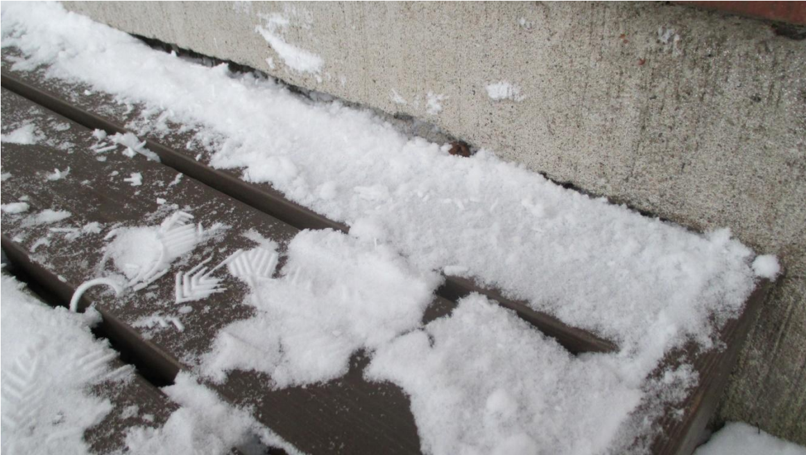
Liite 6. Kuvassa on kiinteistön sisäänkäynnin terassin puuosia, jotka menevät sokkelin sisään. Sokkeli pitää tasoittaa ja siirtää puuosat pois sokkelin sisältä ettei rakenne kerrytä kosteutta sokkeliin.
