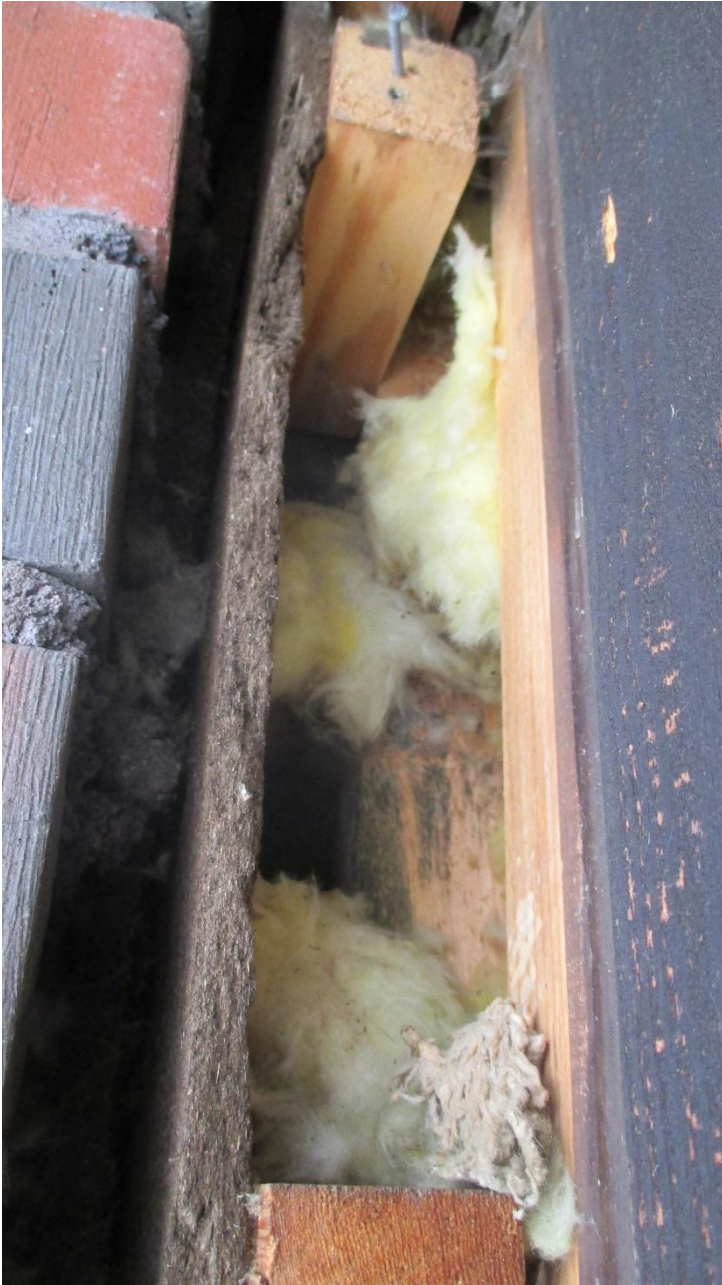
Liite 20. Kuvassa on kiinteistön takaosan ovenkarmia, josta puuttuu lauta ja eristevilla on näkyvillä.
