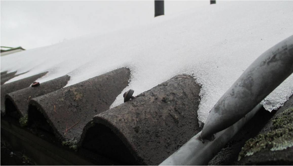
Liite 25. Kuvassa on kiinteistön katon pystyyn noussut katenaula, jonka läpiviennistä vuotaa vettä.
