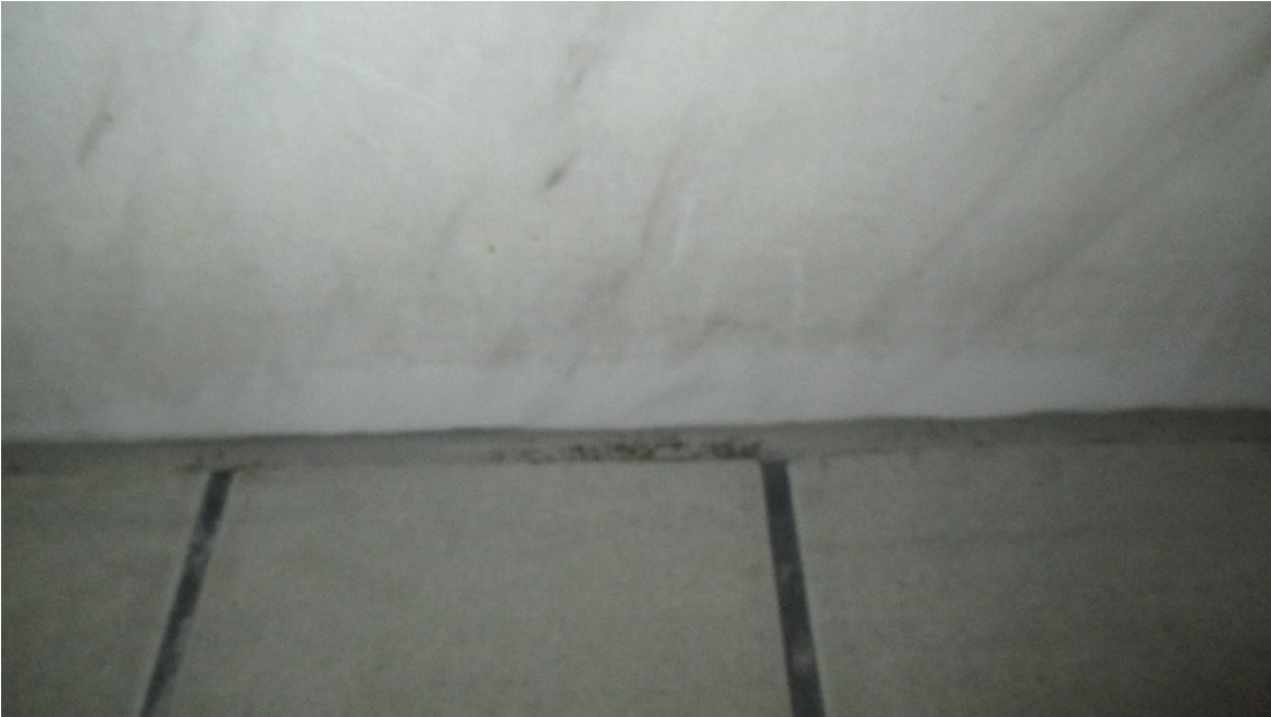
Liite 43. Kuvassa on kiinteistön suihkun silikonisaumaa, jossa on tummaa mikrobijälkeä.
