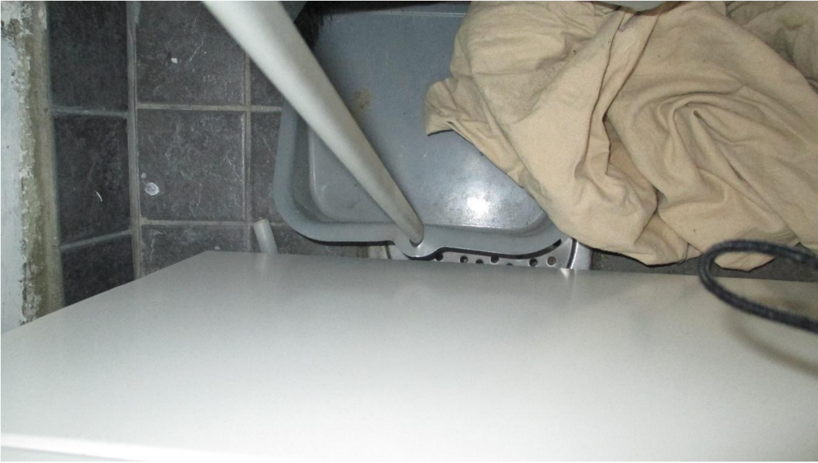
Liite 38. Kuvassa on kiinteistön kodinhoitohuoneen lämmivesivaraaja ja lattiakaivon irronnut kehys.
