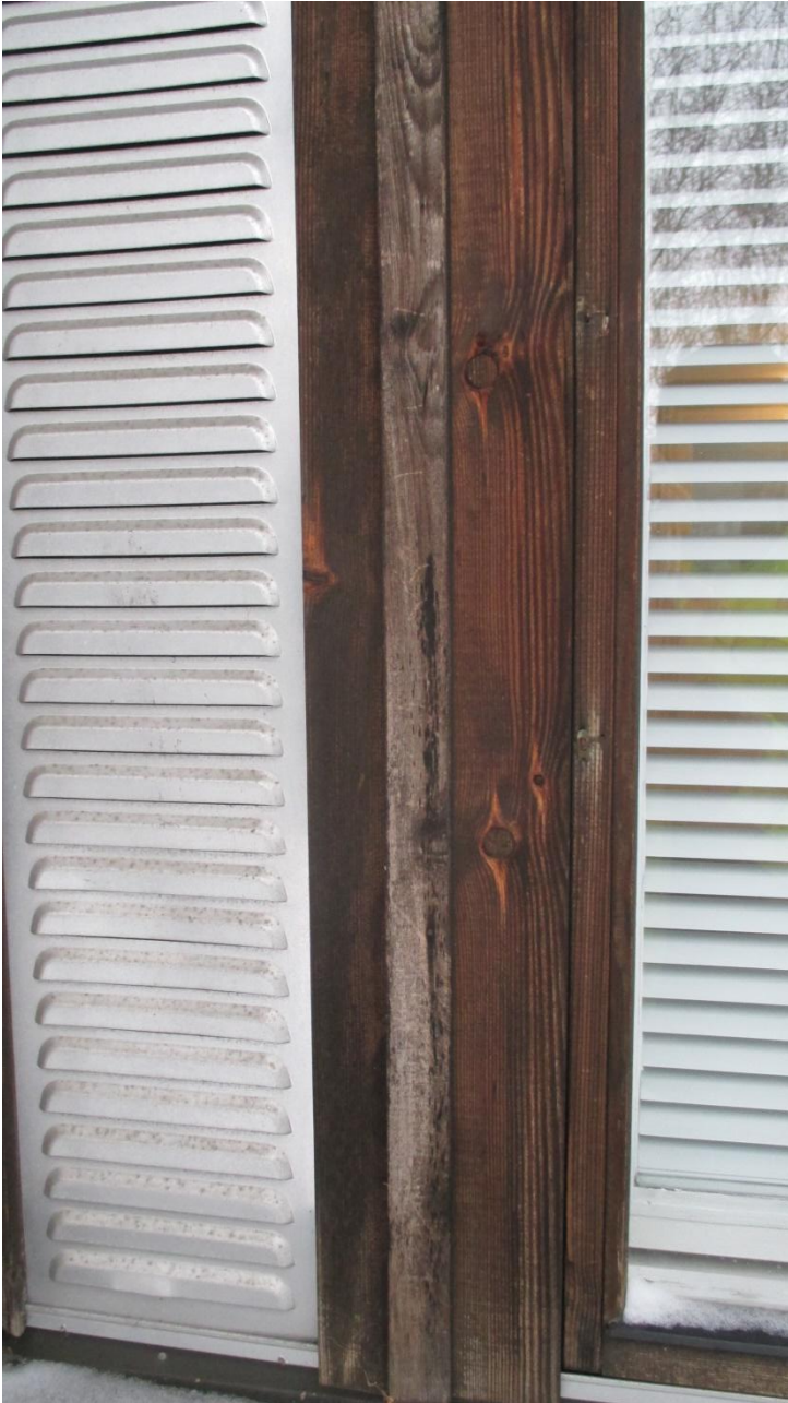
Liite 14. Kuvassa on kiinteistön ikkunaa ulkopuolelta. Ikkunat olivat huoltomaalauksen tarpeessa ulkopuolelta.
