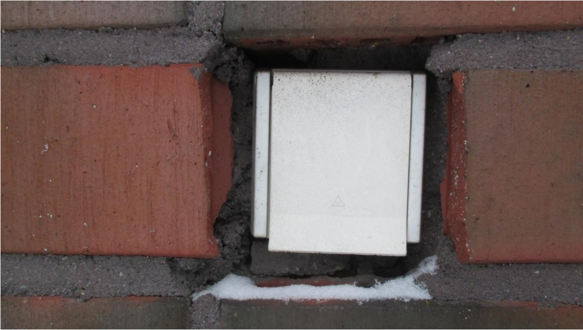
Liite 10. Kuvassa on kiinteistön tiiliverhoilun sähköpistorasia, jonka ympärys pitää saumata uudestaan.
