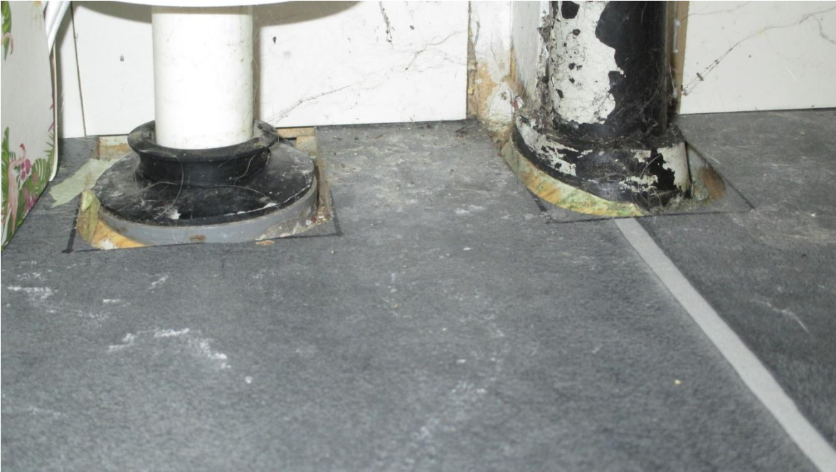
Liite 41. Kuvassa on kiinteistön wc:n viemäreiden lattian läpivientejä, joita ei ole tiivistetty ja ne pitää tiivistää saniteettisilikonilla.
