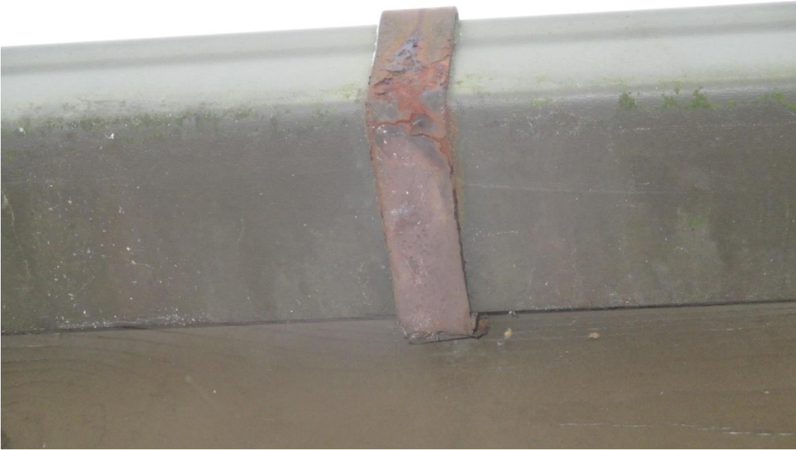
Liite 22. Kuvassa on kiinteistön katon räystäskourun kiinnike, joka on ruostunut ja se pitää uusia tulevaisuudessa.
