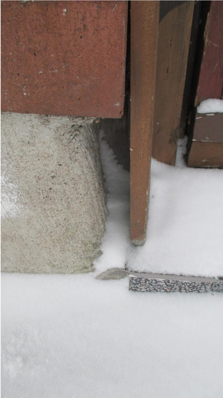
Liite 15. Kuvassa on kiinteistön oven perustuksen ja puulaudoituksen väli, jossa on aukkoa ja se pitäisi tiivistää, ettei lumi ja vesi jää rakenteisiin.
