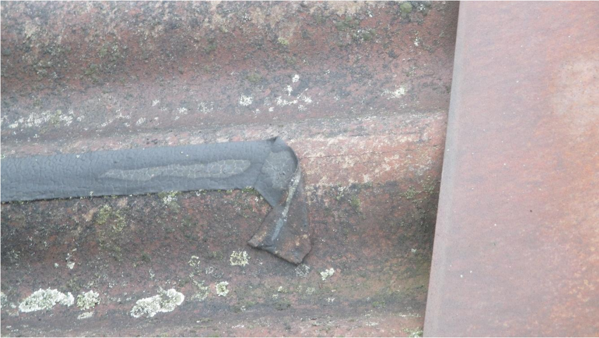
Liite 27. Kuvassa on kiinteistön kattoa ja haljennut kate.
