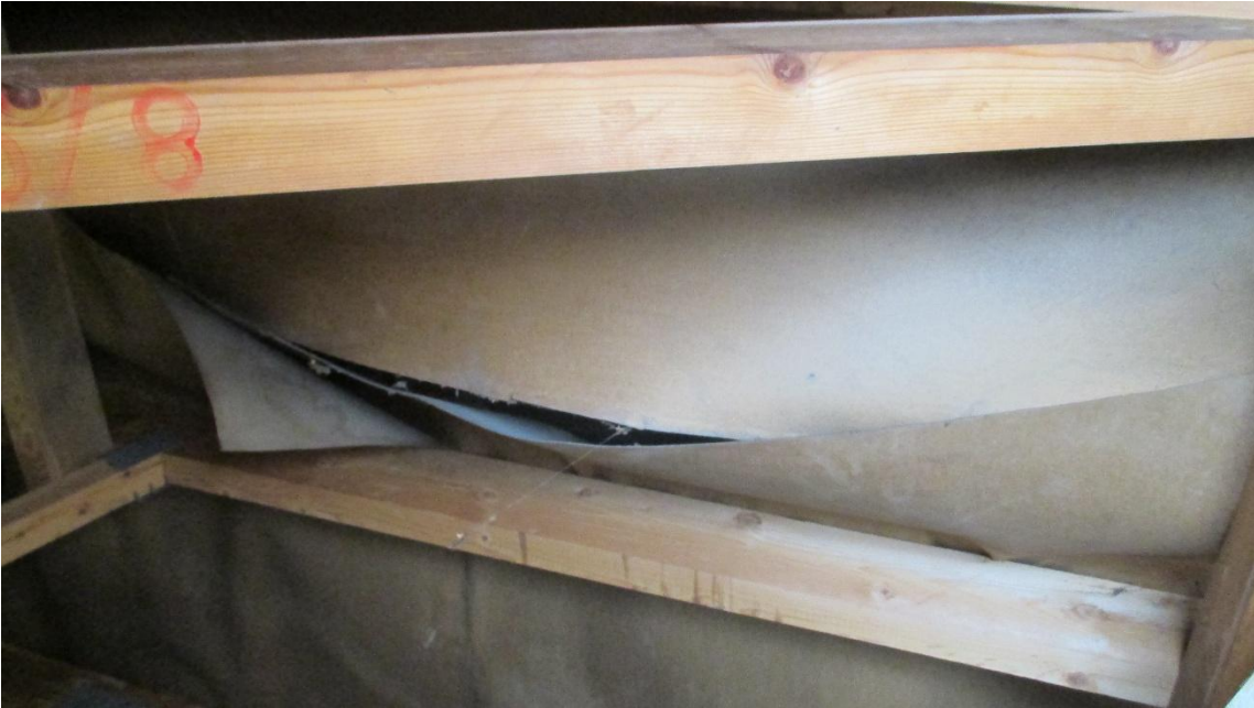
Liite 49. Kuvassa on kiinteistön yläpohjan katon aluspahvia, joka on irronnut kiinnityksestä.
