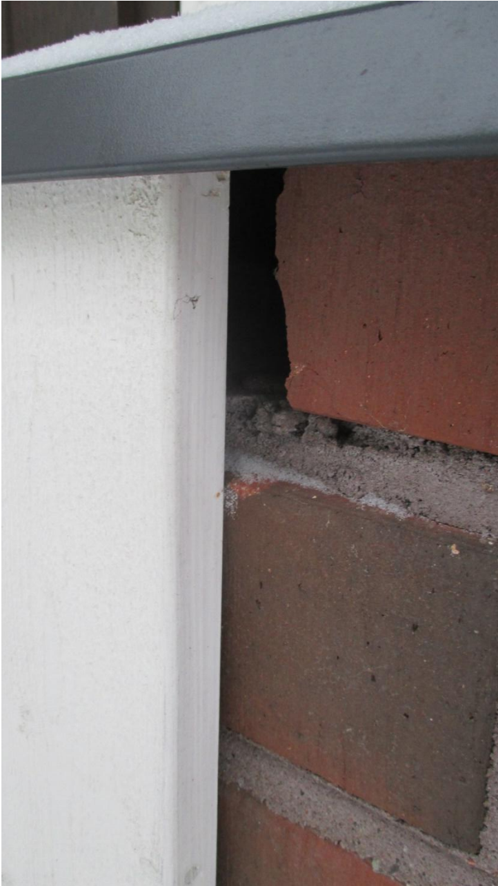
Liite 18. Kuvassa on kiinteistön ikkunapellityksen sivua, jossa on aukko, joka pitää tiivistää, ettei lumi ja vesi jää rakenteisiin.
