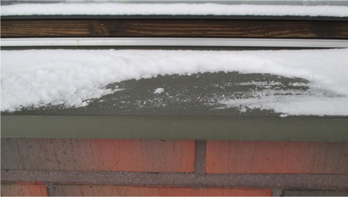
Liite 13. Kuvassa on kiinteistön ikkunapellitystä, jonka kaato pitäisi olla suurempi poispäin kiinteistöstä, ettei lumi ja vesi jää pellityksen päälle.
