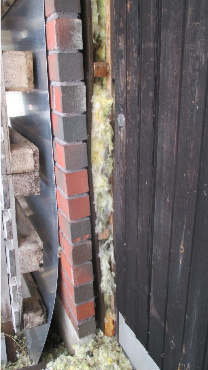
Liite 19. Kuvassa on kiinteistön takaosan ovenkarmia, josta puuttuu lauta ja eristevilla on näkyvillä.
