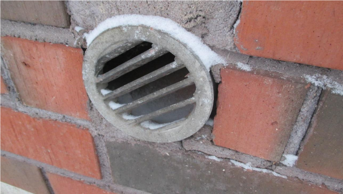
Liite 9. Kuvassa on kiinteistön tiiliverhoilun läpivienti, joka pitää saumata uudestaan.
