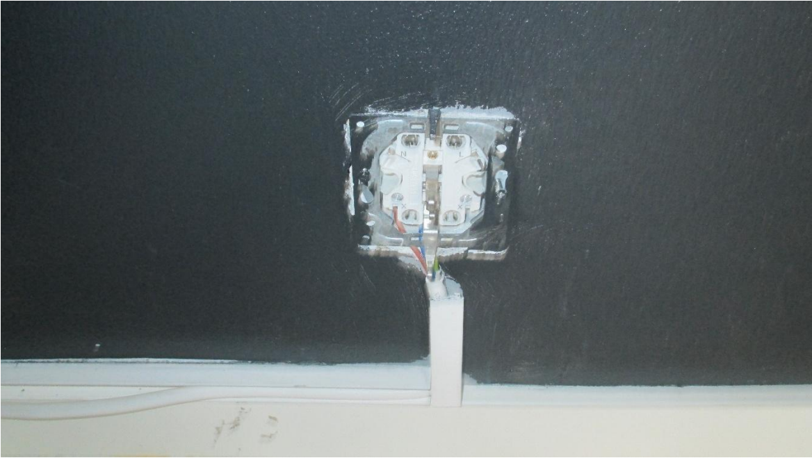
Liite 34. Kuvassa on kiinteistön avonainen sähkörasia.
