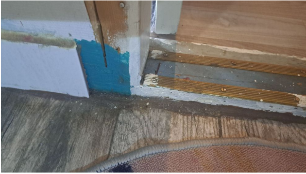
Lattiassa on vedeneriste havaittavissa.
