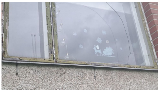
Ikkunoiden ulkopuitteet ovat huollon / korjauksen tarpeessa.
