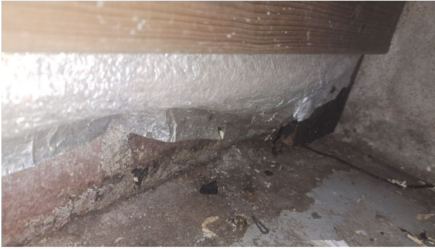
Seinässä on höyrynsulku, lattiaa ei ole vedeneristetty, joten höyrynsulkua ei ole tiivistetty alareunastaan.
