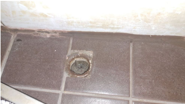
Suihkunurkkauksessa lattiassa reikä, jonka tarkoitus ei selvinnyt tässä tarkastuksessa. Silikonisaumat ovat uusimisen tarpeessa.
