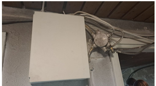
Kaikkia sähkövetoja ei ole kiinnitetty seiniin, johdot ja rasiat roikkuvat.
