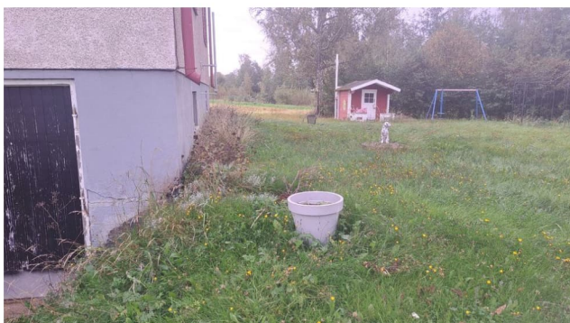
Maanpinta kallistaa pääasiallisesti pois päin rakennuksesta. Salaojien tarkastuskaivoja ei ole, joten salaojien olemassaolosta ei ole tietoa. Perusmuurin ympärillä kosteuseristeenä on vanhaa bitumisivelyä, patolevyä ei ole.
