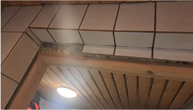
Oviaukossa pinnoitteet epätiiviit. Vedeneristettä ei havaittu.
