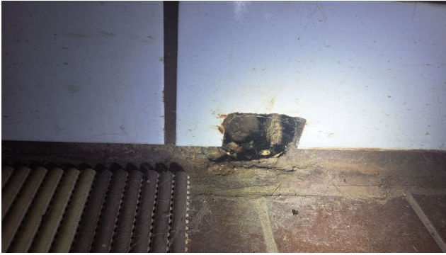
Saunan ja kylpyhuoneen väliseinän alaosassa aukko.
