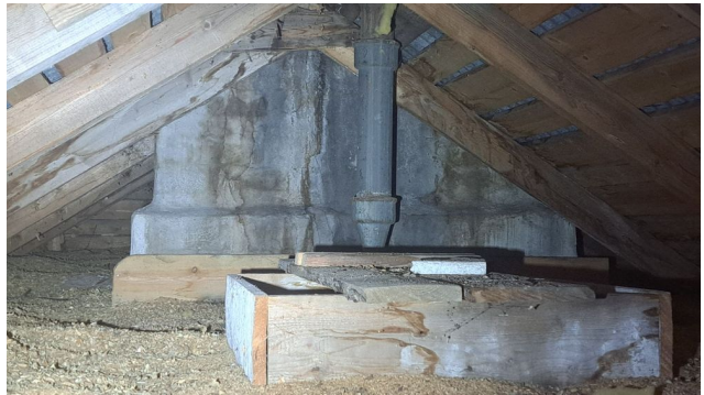
Hormin ympärillä on valumajälkiä. Viemärin tuuletusputkea ei ole eristetty.
