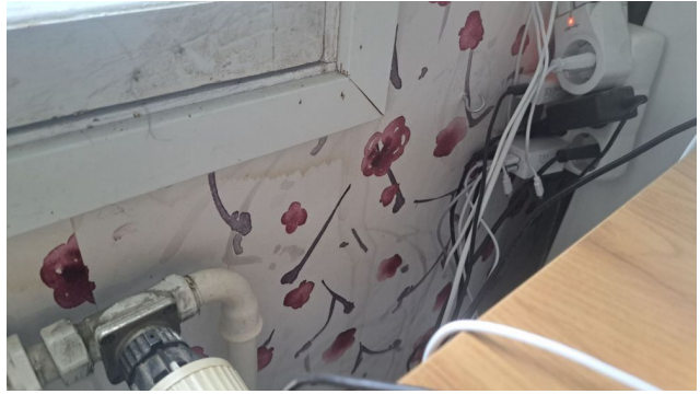
Keittiössä ikkunan alla valumajälkiä.
