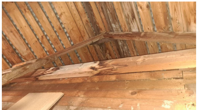
Ruodelaudoissa ja kattorakenteissa kosteusjälkiä, todennäköisesti kondenssikosteuden aiheuttamia.
