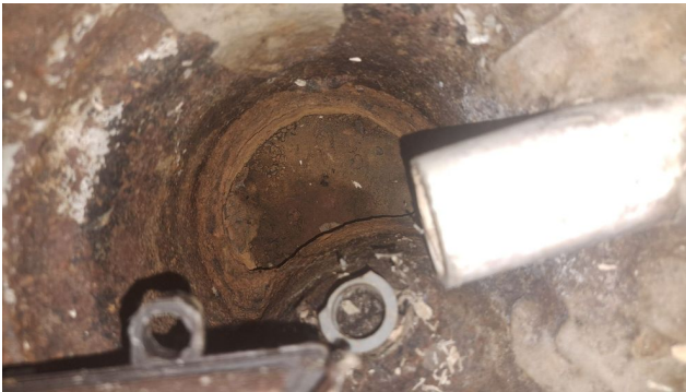
Lattiakaivo ruosteessa ja kuivunut.
