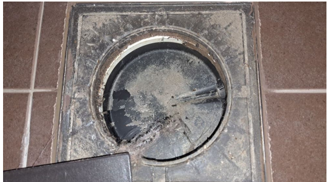
Suihkussa kuivakaivo, josta poistoputki menee saunan puolella olevalle kaivolle.
