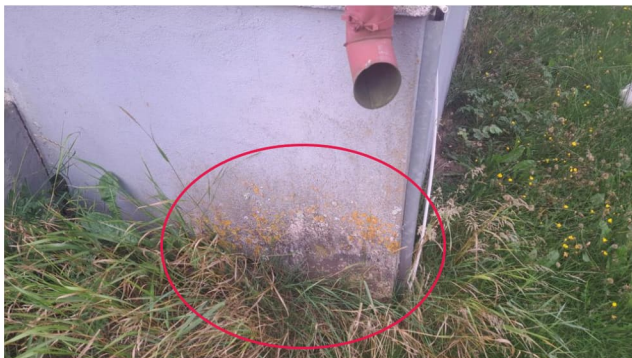
Sadevedet valuvat ränneistä suoraan perustuksiin. Kosteus pääsee rasittamaan rakenteita.
