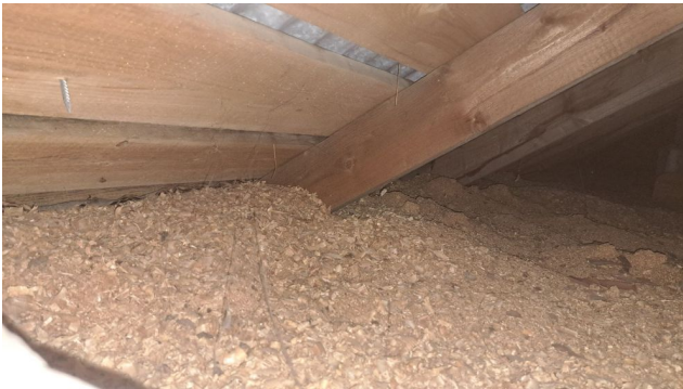
Sahanpurueriste on kiinni vesikatteessa eikä tila pääse tuulettumaan.
