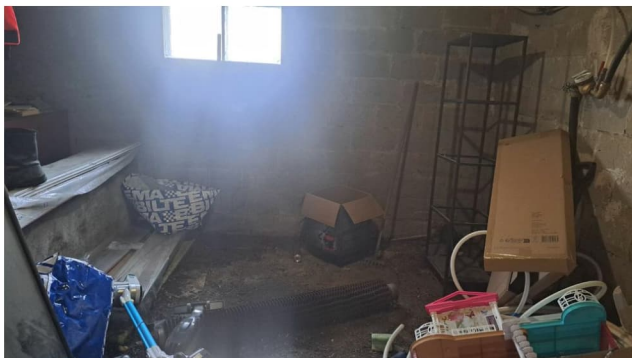
Kellarissa maakosteus rasittaa alapohjaa ja ulkoseinien alaosia. Lattiaa vasten varastoidut orgaaniset materiaalit saattavat vaurioitua kosteuden vaikutuksesta.
