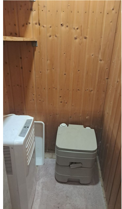
Komeron / kuivakäymälän lattiassa kohonneita pintakosteusarvoja. Maakosteus todennäköisesti rasittaa alapohjaa.
