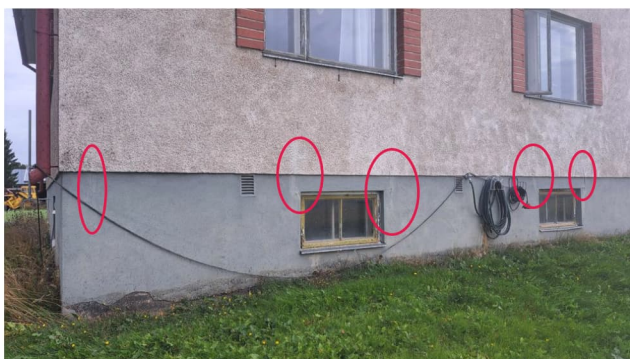
Sokkelissa paikoitellen halkeamia etenkin aukkojen ympärillä.
