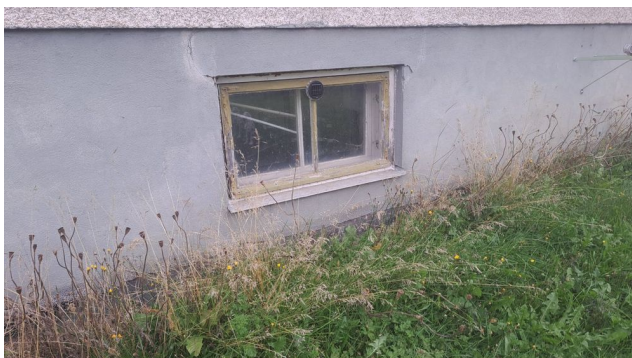
Ikkunapellityksissä puutteelliset kaadot.
