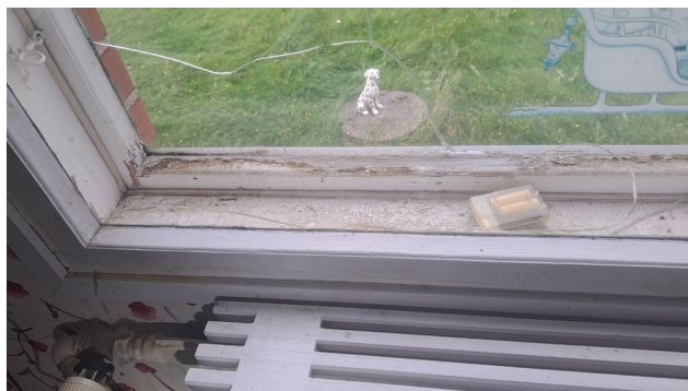
Ikkunoiden ulkopokat paikoitellen huonokuntoiset.
