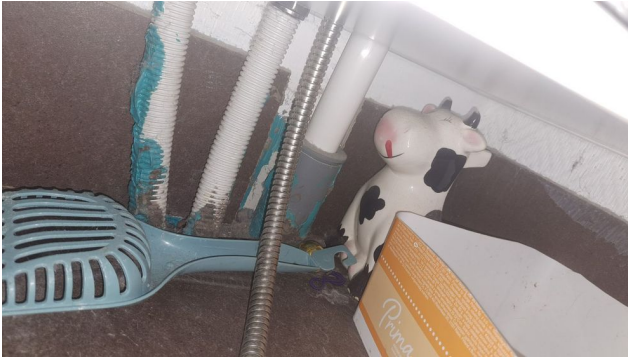
Lattiassa on vedeneriste havaittavissa.
