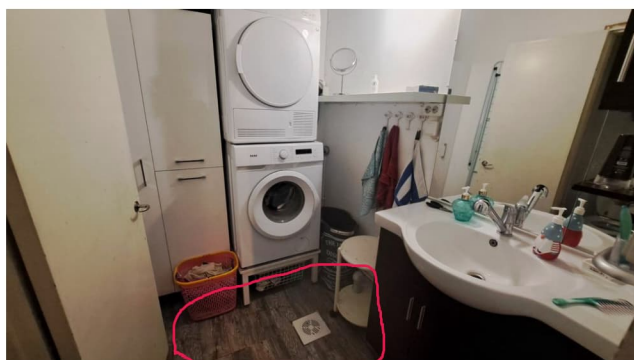
Kodinhoitohuone. Kuvaan on havainnollistettu aluetta, missä kohonneita pinta-arvoja todettiin.
