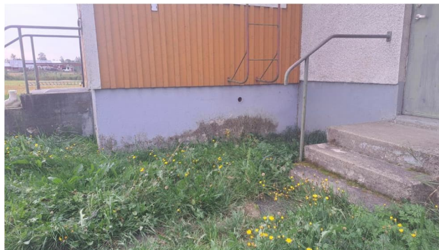
Sokkelissa viitteitä kosteusrasituksesta.
