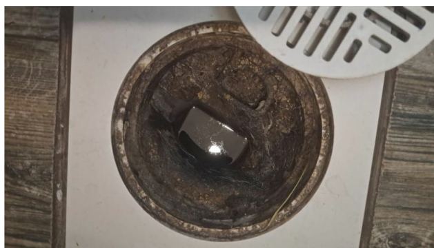
Lattiakaivo on puhdistuksen tarpeessa.
