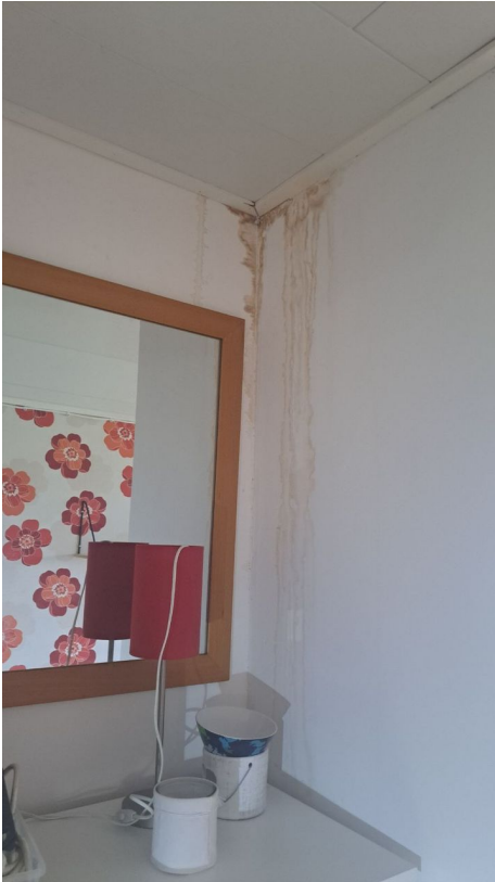
Vintin sisäpinnoilla valumajälkiä kattovuodoista.
