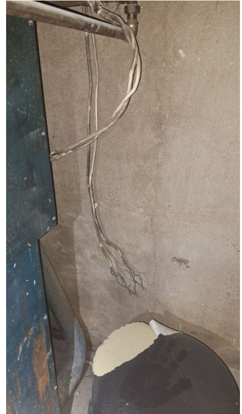
irralisia johtoja pannuhuoneessa. Ei ole tiedossa mitä johtoja on kyseessä tai tuleeko niihin virtaa.
