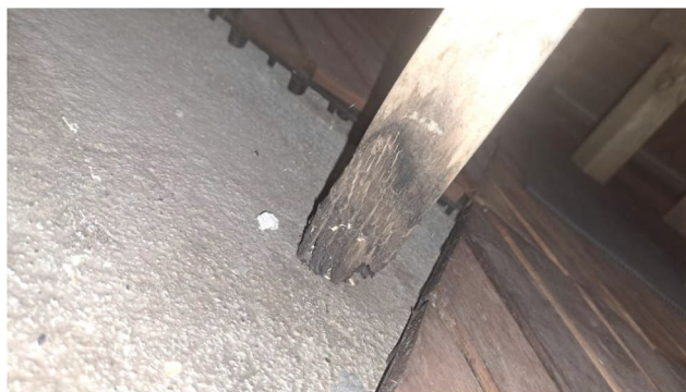
Lauteiden runkopuut lahonneet lattiaa vasten.
