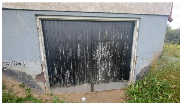
Sokkelissa halkeamia. Maanpinnan alapuolelle on tehty bitumisivelyä, jonka laskennallinen käyttöikä on kuitenkin saavutettu.
