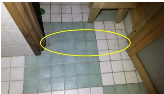
Saunan oven kohdalla laattoja irti alustastaan.
