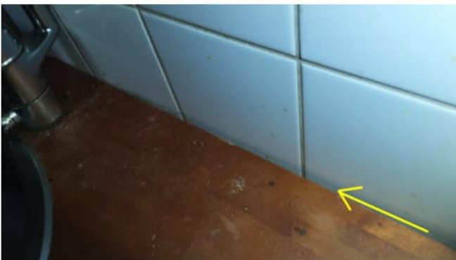
Keittiön allastason ja seinälaatoituksen välissä ei ole tiivistystä.
