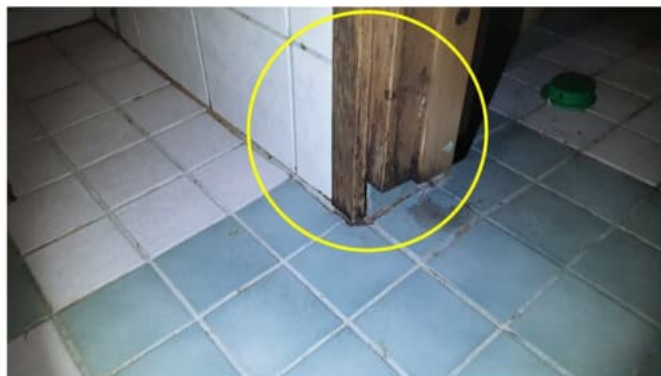
Saunan oven karmissa ja listassa mikrobivaurioita.
