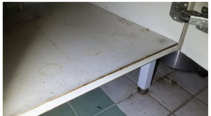
Allaskaapin pohjalevy vaurioitunut.
