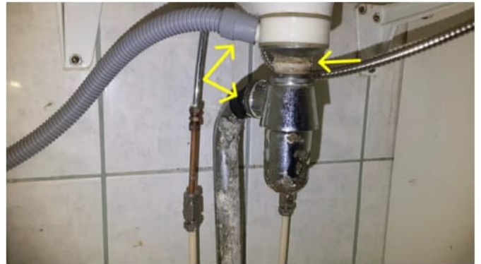
Pesukoneen poistoputken päästä puuttuu klemmari. Allaskaapin sisällä hajulukko kasattu väärin ja liitos vuotaa (teippiä liitoksessa)
