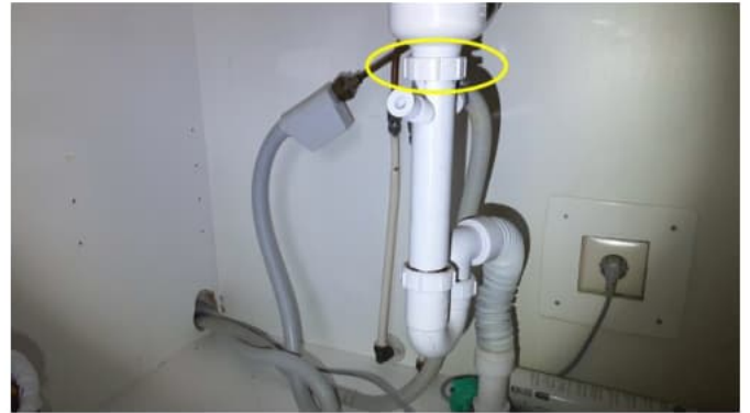
Allaskaapissa hajulukon liitos vuoti, kiristetty tarkastuksen yhteydessä.
