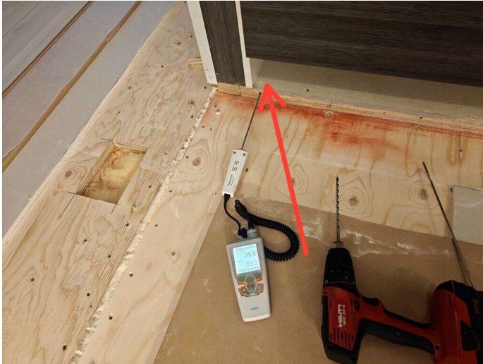
Kuva 13 Kaappien alla oleva korokelevy on kastunut Rh 93% 22°C.
