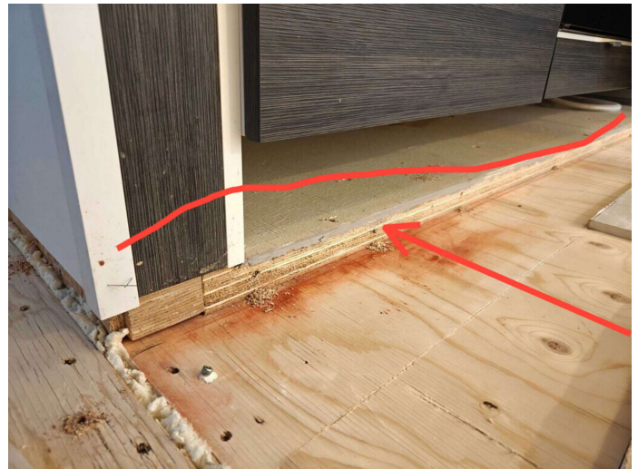
Kuva 12 Kaappien alla oleva korokelevy on kastunut.
