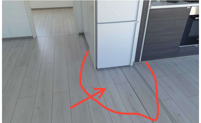
Kuva 4 Keittiö: Laminaattilattia on vaurioitunut jääkaappipakastimen ympäriltä.
