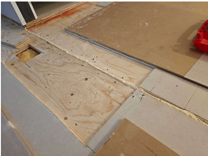
Kuva 15 Lattian puurekenne levyssä veden jättämiä jälkiä.
