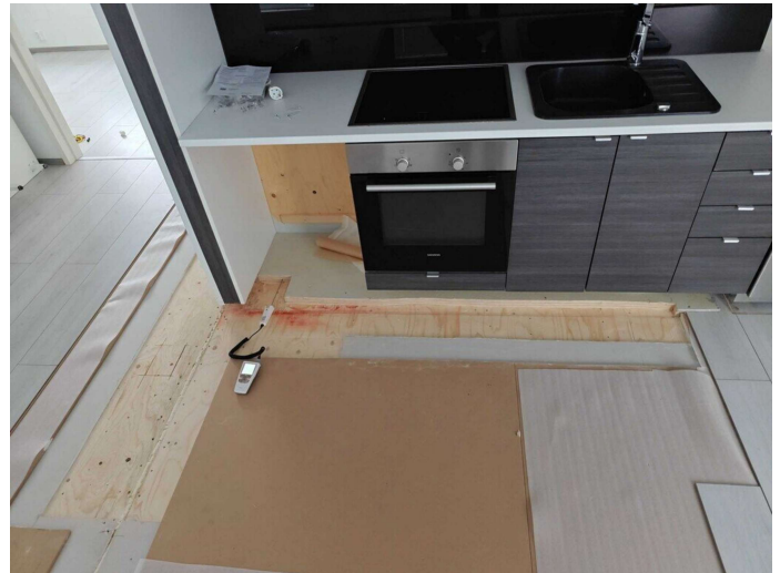
Kuva 18 Kaappien alla oleva korokelevy on poistettu kastuneelta alueelta.
