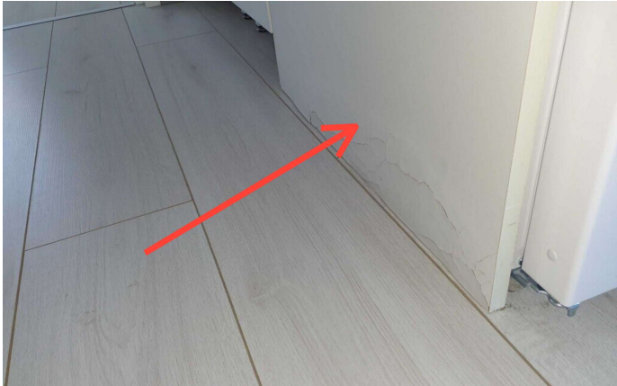
Kuva 3 Kaapin sivuseinä on kastunut ja vaurioitunut alaosaan
