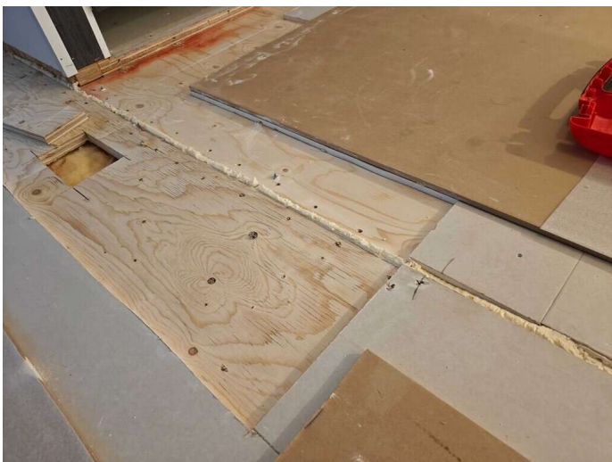
Kuva 15 Lattian puurekenne levyssä veden jättämiä jälkiä.
