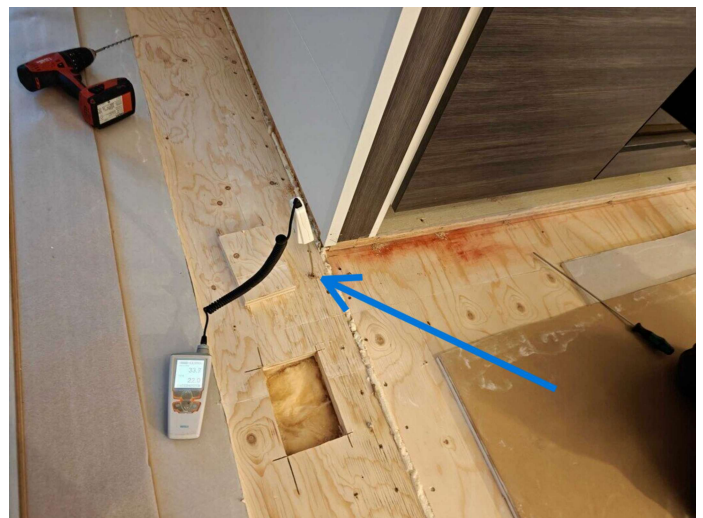
Kuva 16 Lattian puurekennelevyssä veden jättämiä jälkiä. Levylattia on kuiva Rh 33% 22°C.
