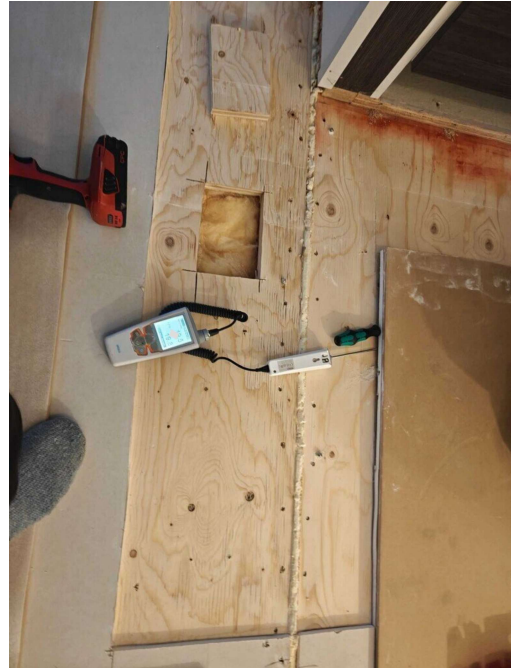
Kuva 14 Kipsilevyllä ei havaittu kosteutta puretun alueen ulkopuolella. RH 22 %, 20 °C.
