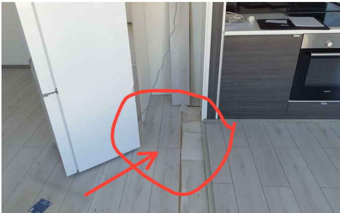
Kuva 5 Vaurioitunut alue lattiassa
