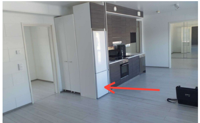
Kuva 2 Jääkaappipakastin vuotanut sulamis veden lattialle.
