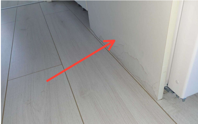
Kuva 3 Kaapin sivuseinä on kastunut ja vaurioitunut alaosaan
