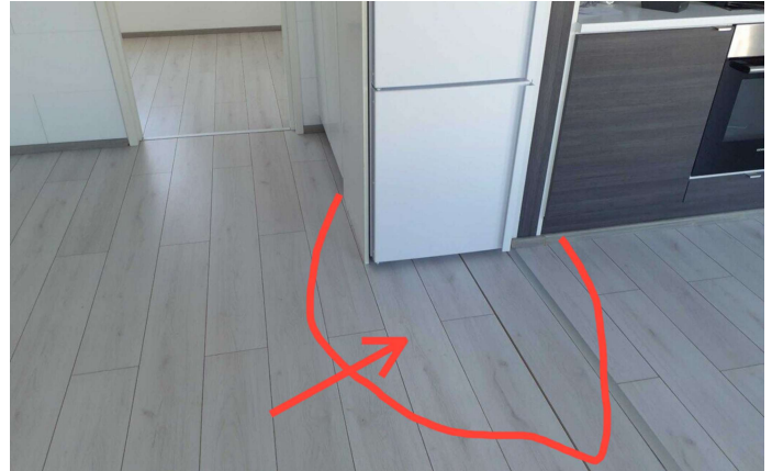
Kuva 4 Keittiö: Laminaattilattia on vaurioitunut jääkaappipakastimen ympäriltä.
