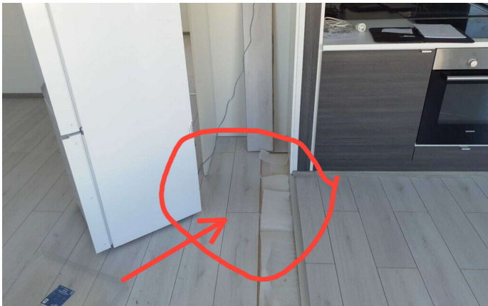
Kuva 5 Vaurioitunut alue lattiassa
