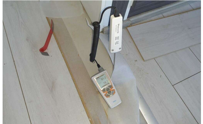
Kuva 8 Lattian kipsilevyt on kastunut Rh 90% 21°C.
