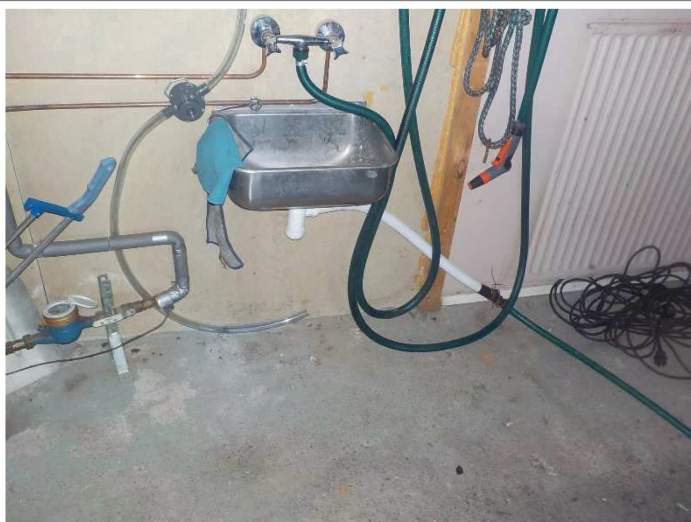
Autotallin putkistoja ja vesimittari.
