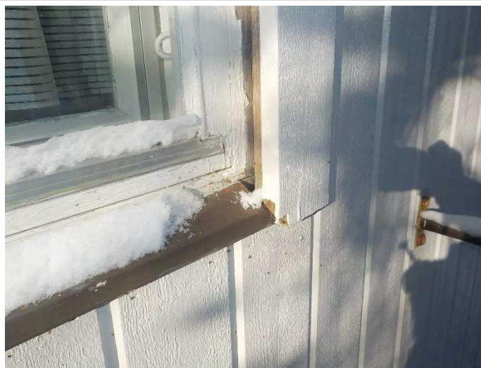
Vesipeltien ja ikkunoiden päätyjä on lautaverhouksen osalta tiivistämättä.
