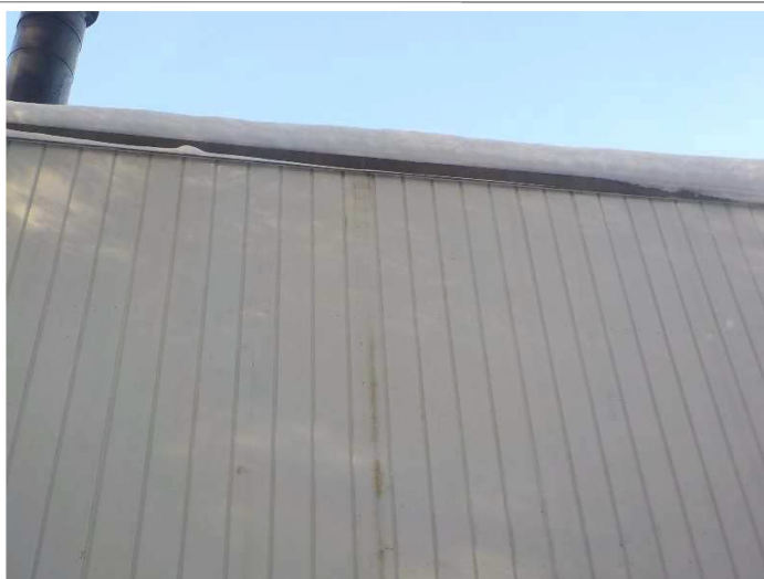
Ulkoseinät/lautaverhous altistuu helposti jatkuvalle säärasitukselle.
