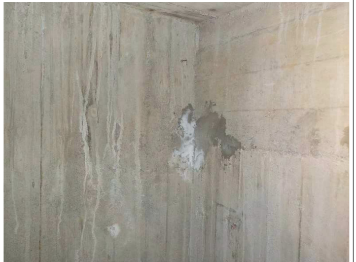
Kellarin seinän kalkkeumaa.
