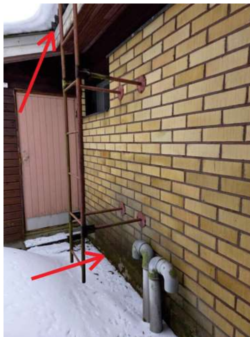
Kuva 4 Takapihan julkisivussa sammalkasvustoa, Vesikouru puuttuu ko. kohdalta.
