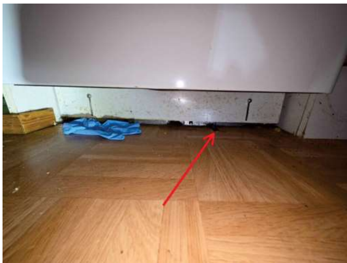
Kuva 23 APK kaapeli lattiasta
