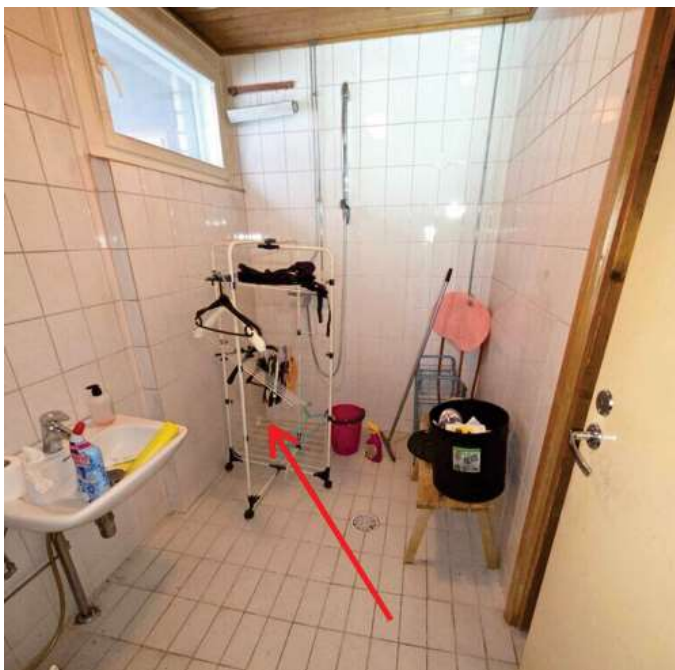
Kuva 16 Kylpyhuoneessa laatan saumoissa halkeamaa
