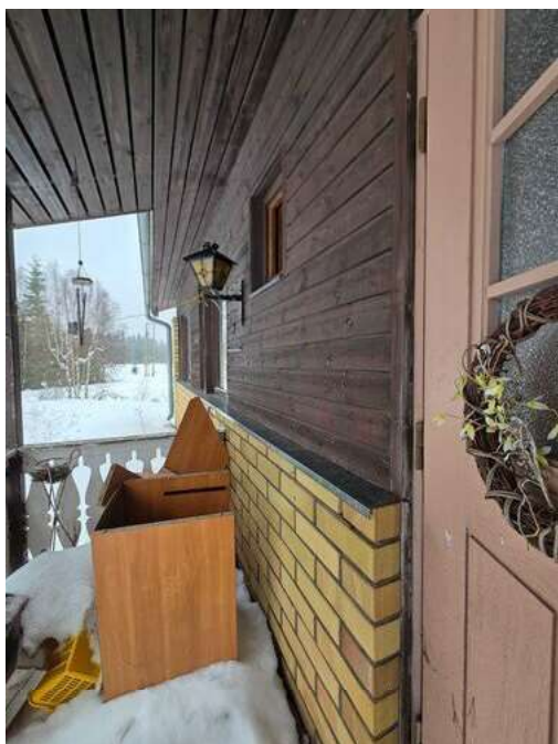
Kuva 11 Vesipeltien kaltevuus puutteellinen
