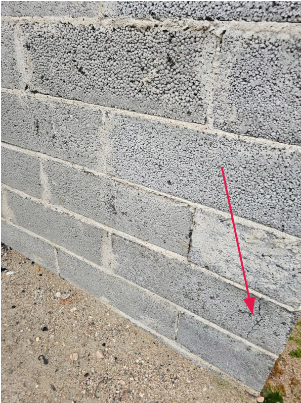
Nurkan pystysuuntainen halkeama
