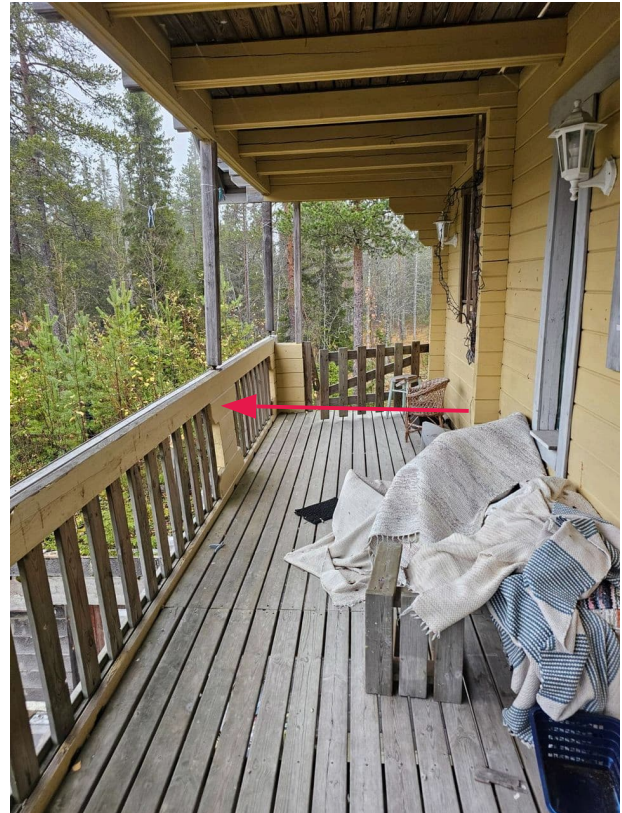
Parveke on pullahtanut nuolen osoittamassa suunnassa. Kaide ja pilarit heiluvat käsin heiluttamalla. Tämä on aiheuttanut taipumaa ylemmän parvekkeen rakenteisiin.
