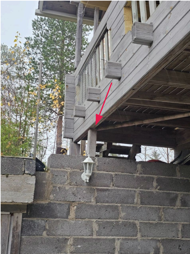
Alemmalle parvekkeelle on otettu tuki harkkomuurauksen päältä, ja muurauksen liikkumisen myötä tuki on nurjahtanut
