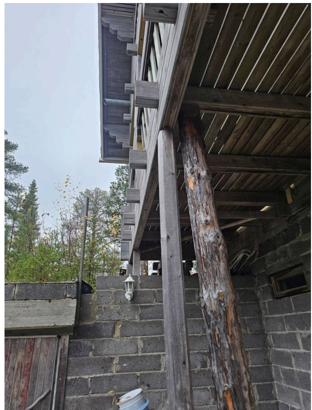
Alempi parveke on tuettu alkuperäisen pilarin lisäksi tukilla.
