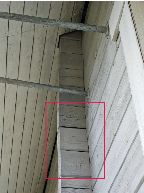
Liitoksessa merkkejä epätasaisesta painumisesta, ja mahdollisesti hirsirungon vähäinen pullistuminen ulospäin
